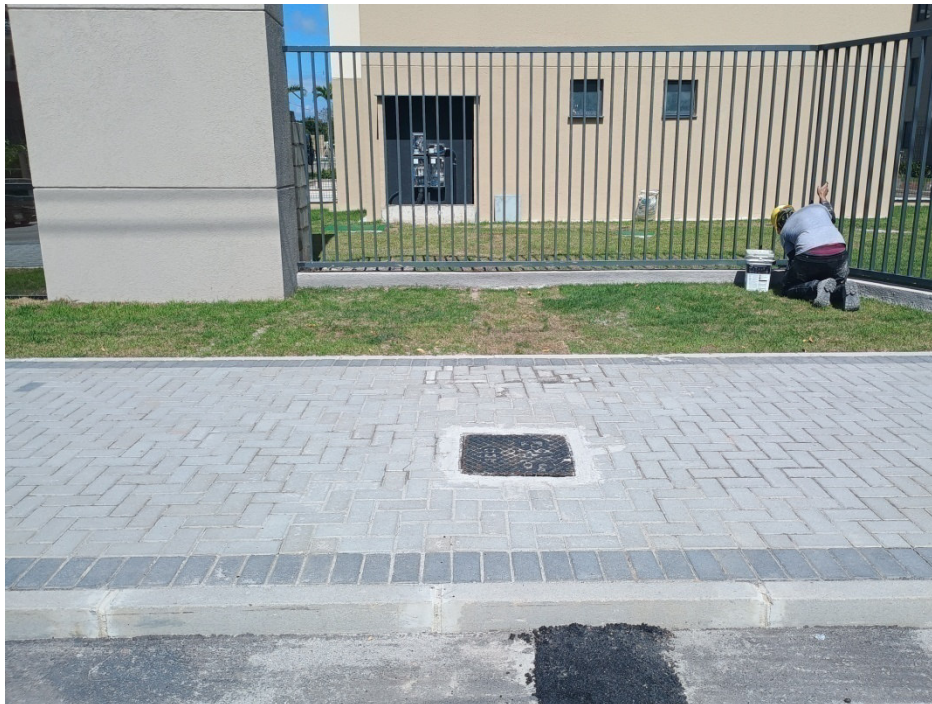
Foto 1: ponto de interligação de gás natural do Condomínio Novo Lar Recreio.
