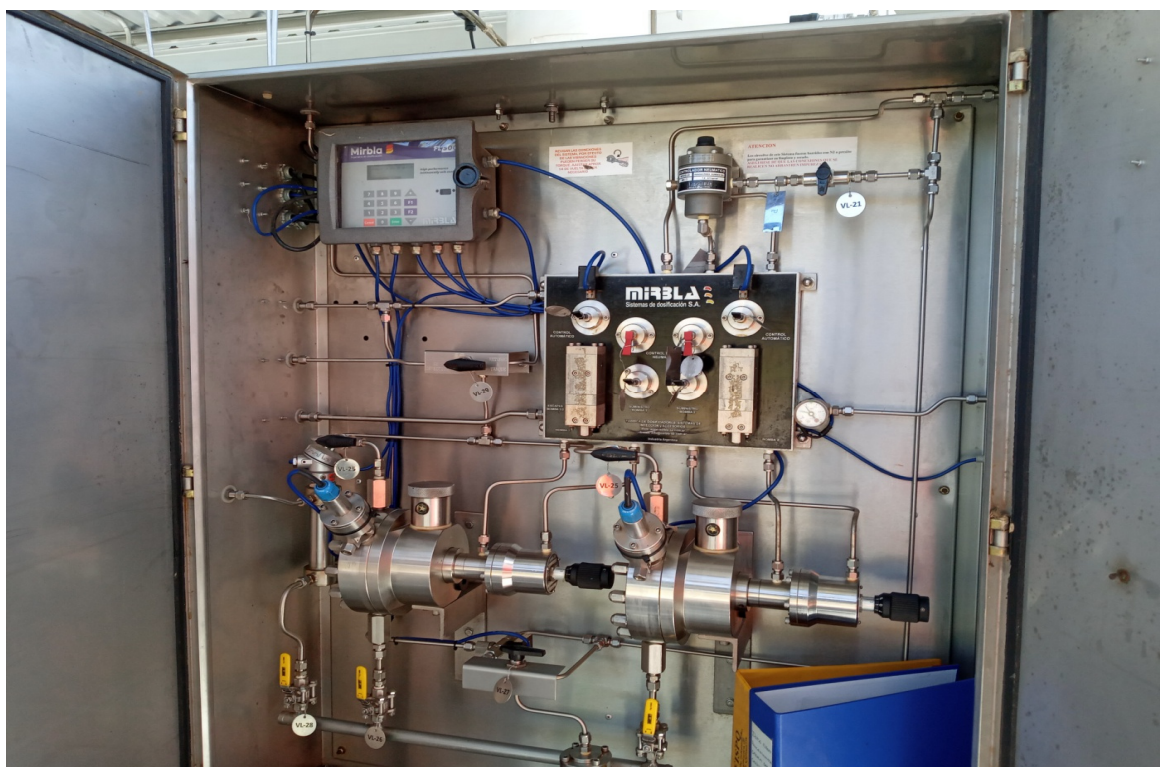
Foto 6: Equipamento de odorização
