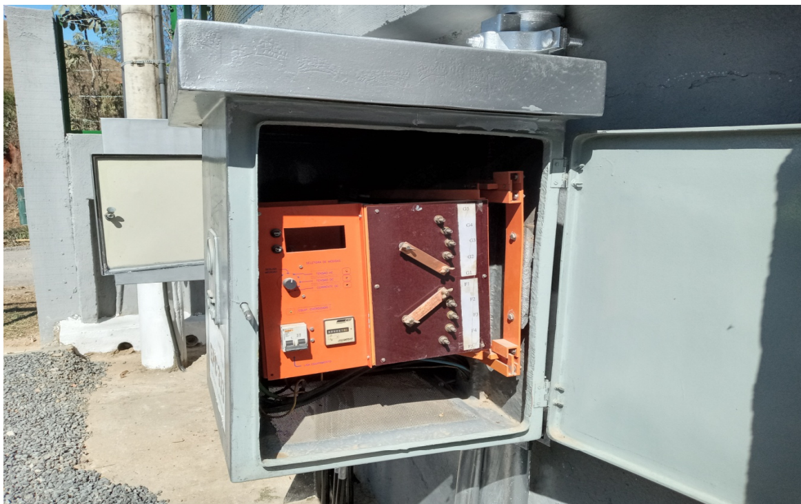
Foto 11: Retificador do sistema de proteção catódica
