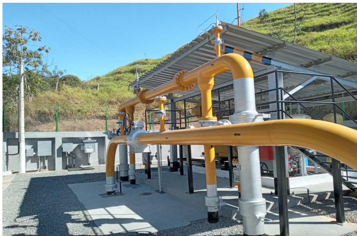
Foto 4: Rede de entrada do gás natural
