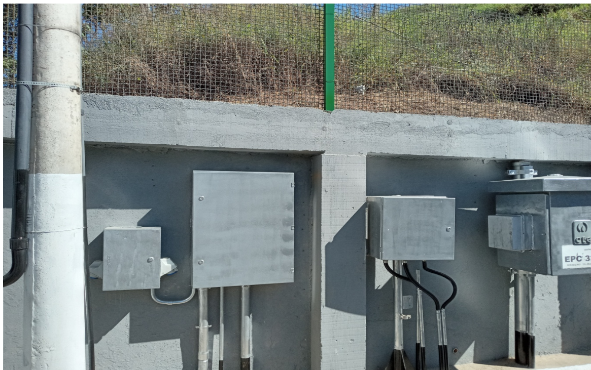
Foto 15: Painéis elétricos sem sinalização de segurança
