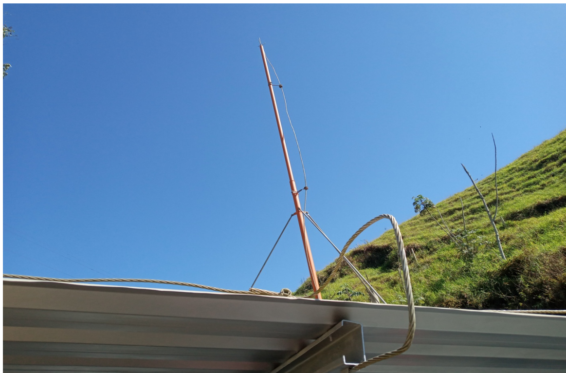
Foto 10: Sistema de proteção contra descarga atmosférica
