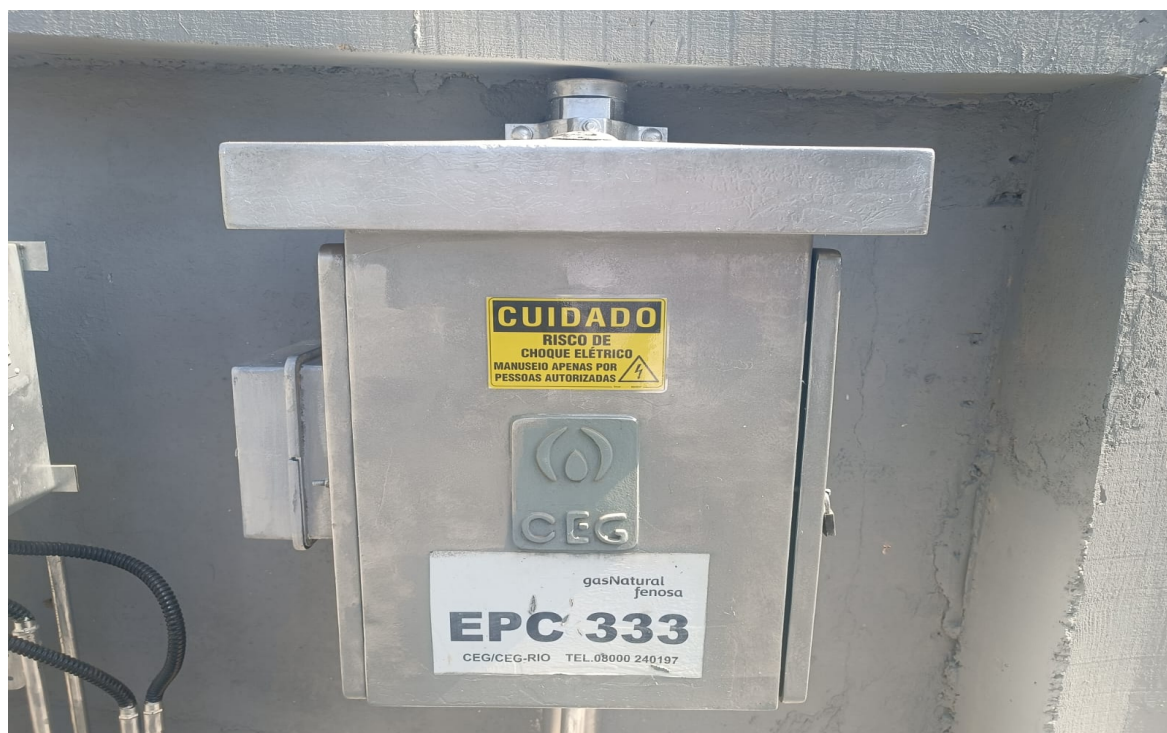
Foto 17: Pannel com sinalização de segurança
