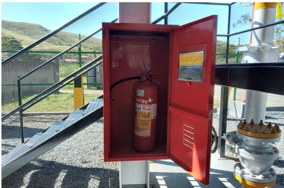
Foto 12: Extintor de incêndio
