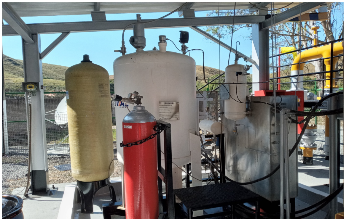
Foto 5: Estação de Odorização
