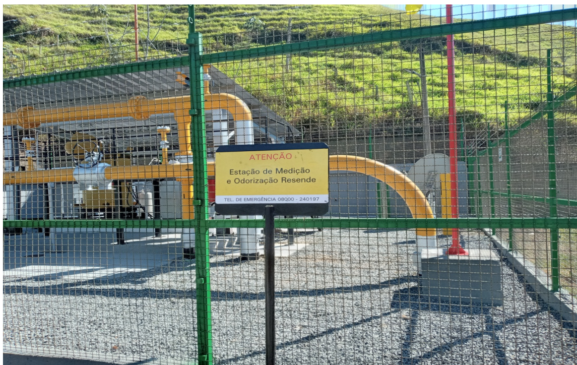
Foto 1: Placa de identificação da estação
