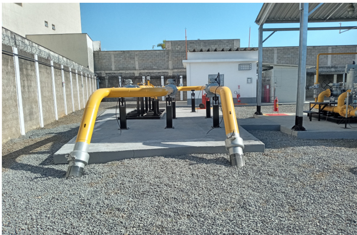
Foto 4: Rede de entrada do gás
