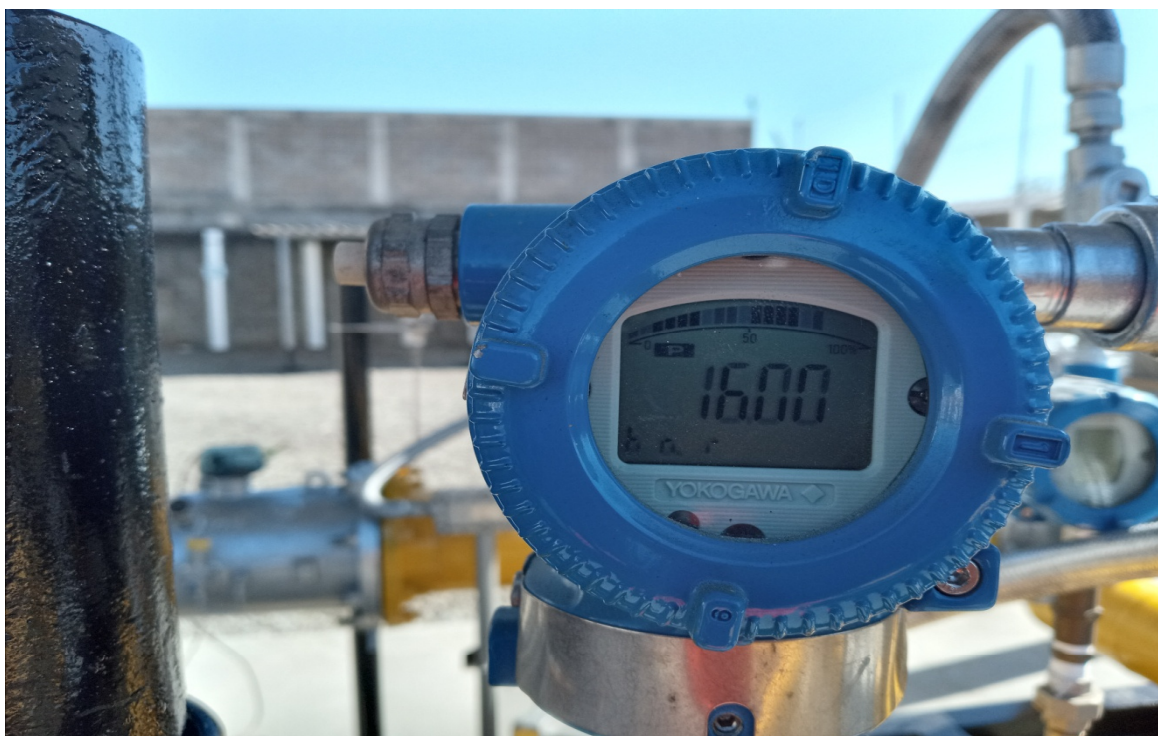
Foto 9: Transmissor de pressão a jusante do regulador
