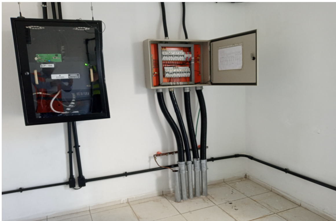
Foto 16: Painele de telemetria e quadro de distribuição de energia elétrica
