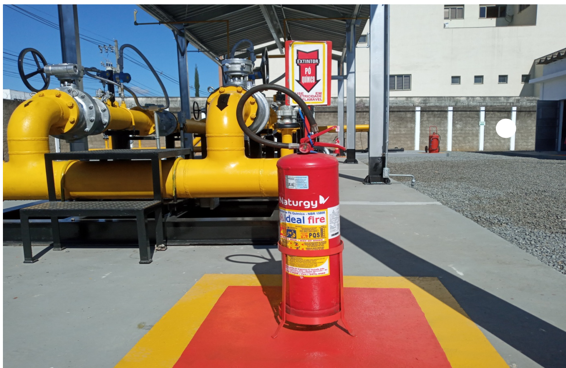
Foto 12: Extintor de PQS
