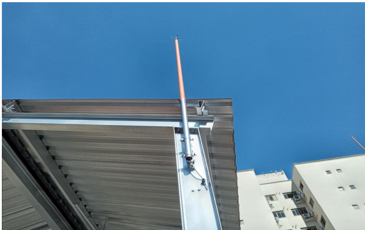
Foto 15: Sistema de proteção contra descargas atmosféricas
