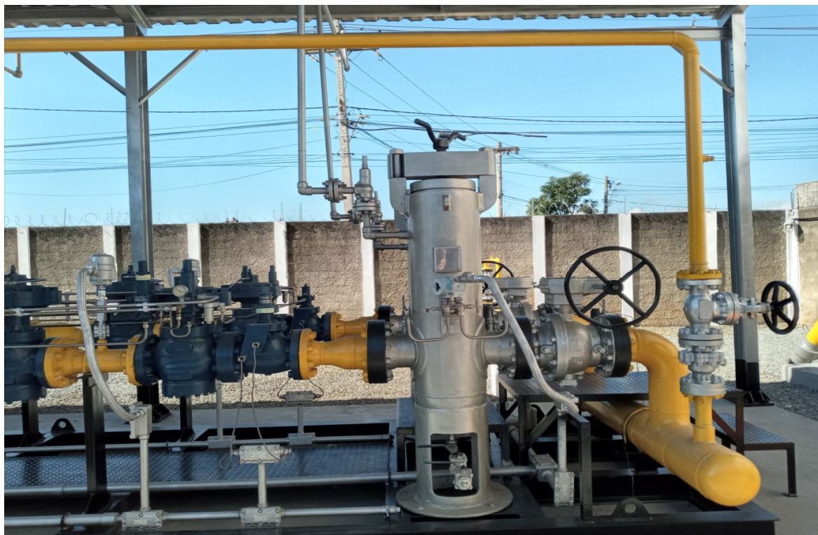
Foto 6: Filtro e válvula de regulação
