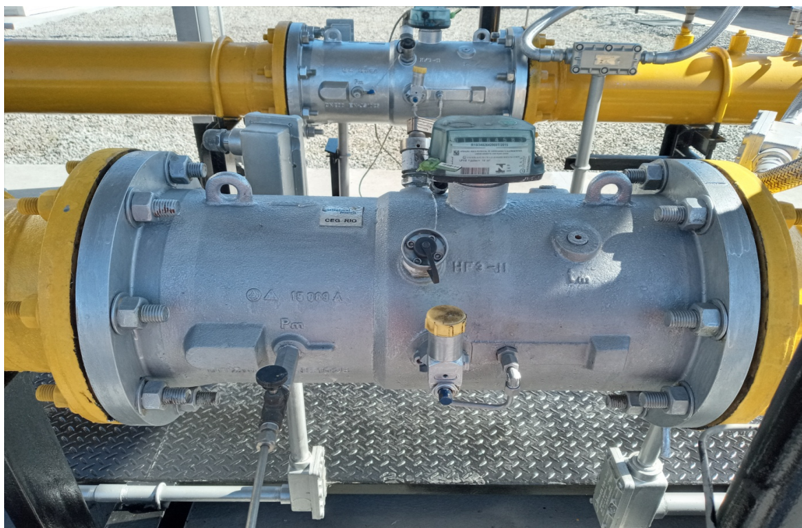
Foto 8: Medidor tipo turbina
