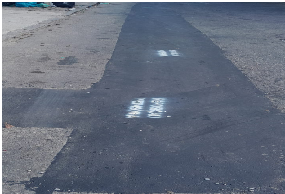
Foto 6: Trecho com identificação de reposição provisória.
