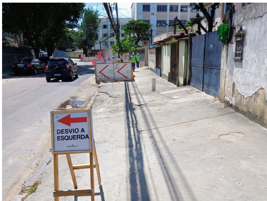
Foto 4: Trecho ainda sem instalação.
