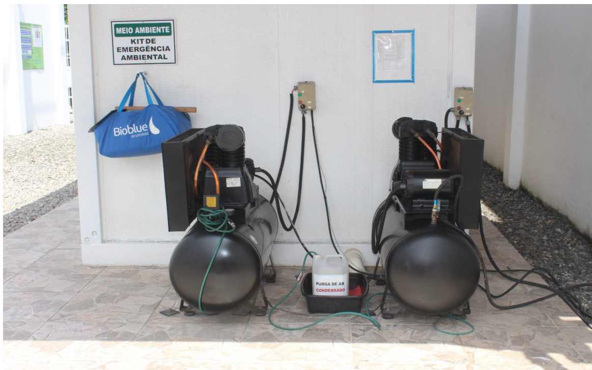
Foto 7: Compressores (sistema de acionamento de válvulas - RCU)
