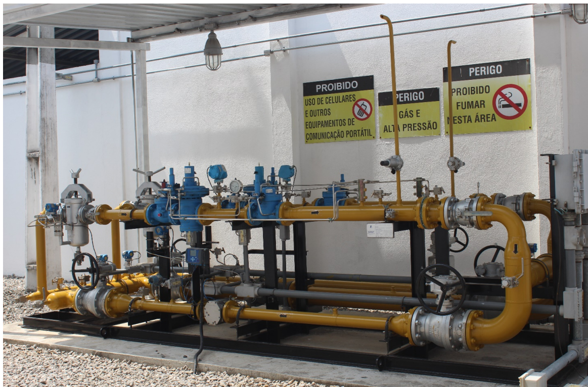
Foto 6: Estação de regulagem e medição - 6,4 / 0,85 bar
