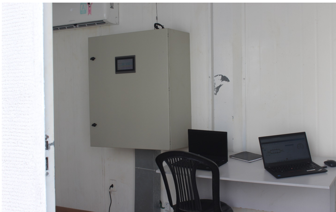
Foto 9: Sala de controle e operação
