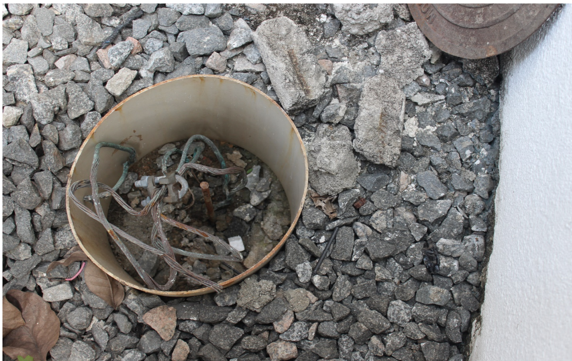
Foto 11: Cabo de aterramento desconectado da haste
