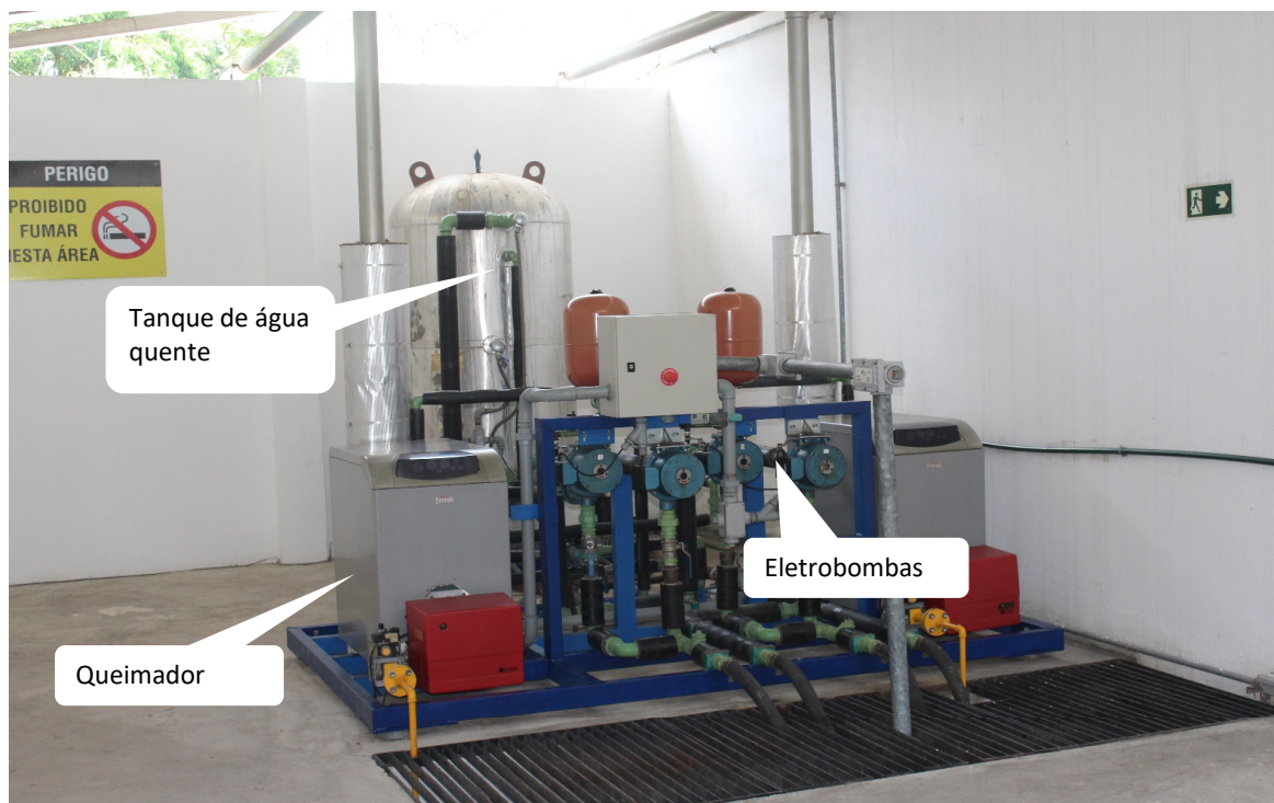
Foto 5: Sistema de aquecimento, armazenamento e recalque de água (Trocador de calor - RCU)
