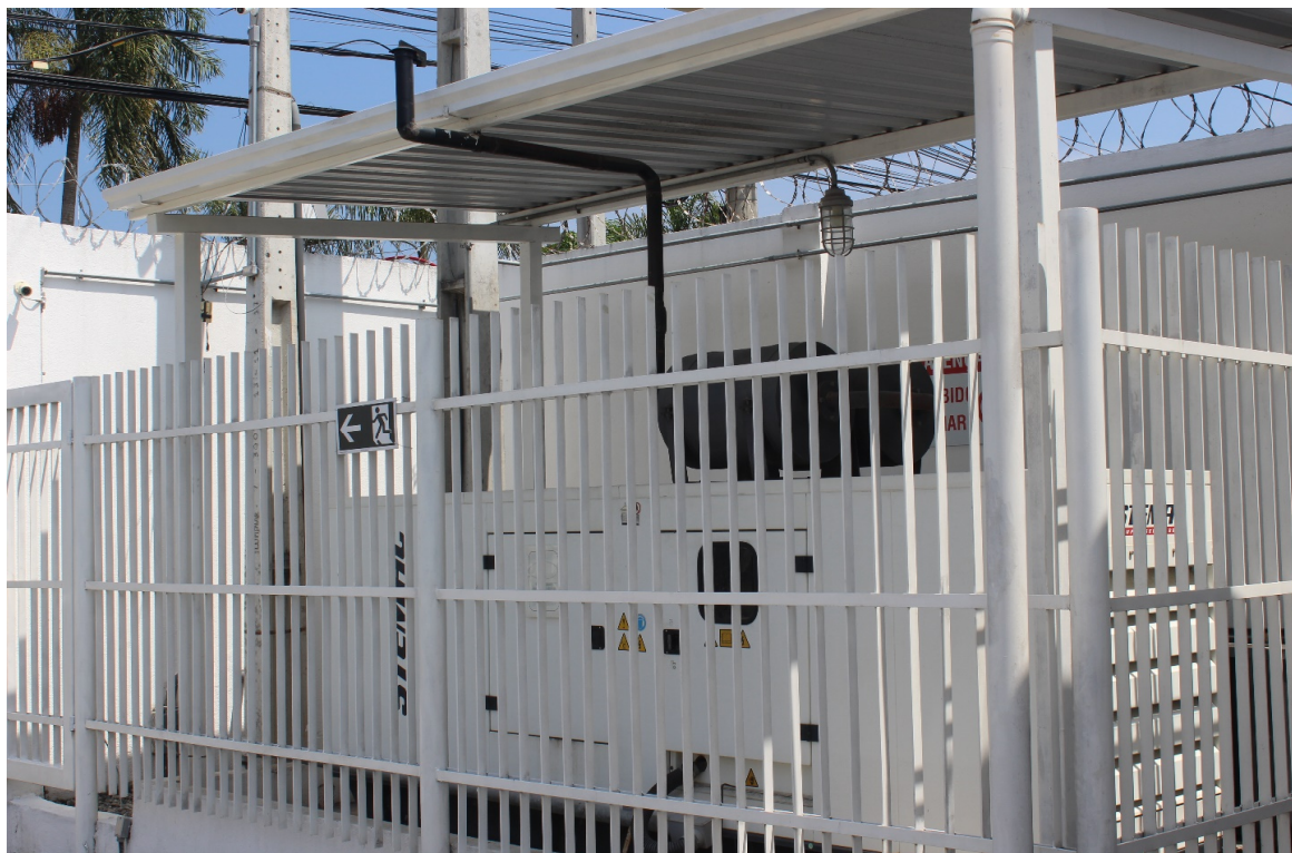
Foto 10: Gerador de emergência (a diesel)
