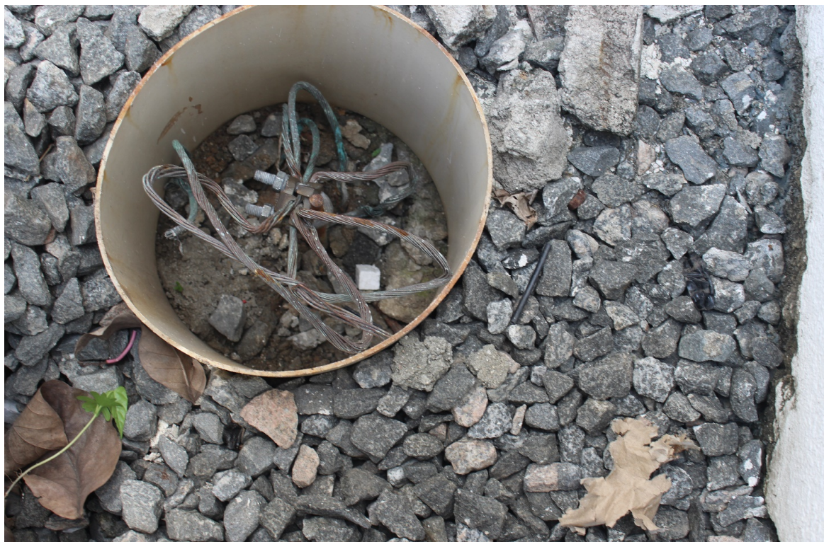
Foto 12: Cabo de aterramento conectado à haste
