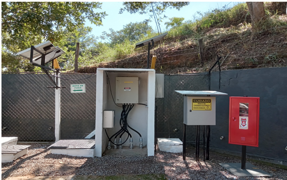
Foto 9: Painéis elétricos e sistema fotovoltaico
