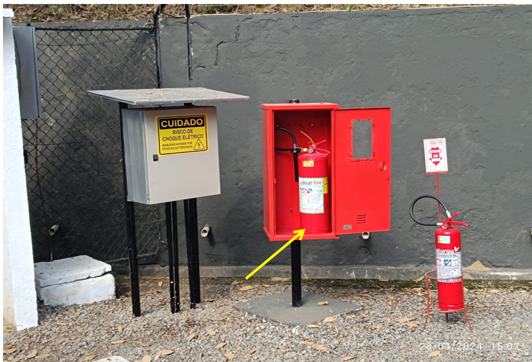
Foto 14: Extintor acrescentado à estação
