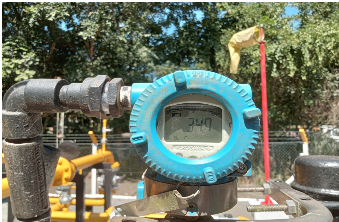
Foto 6: Indicação da pressão (entrada e saída)
