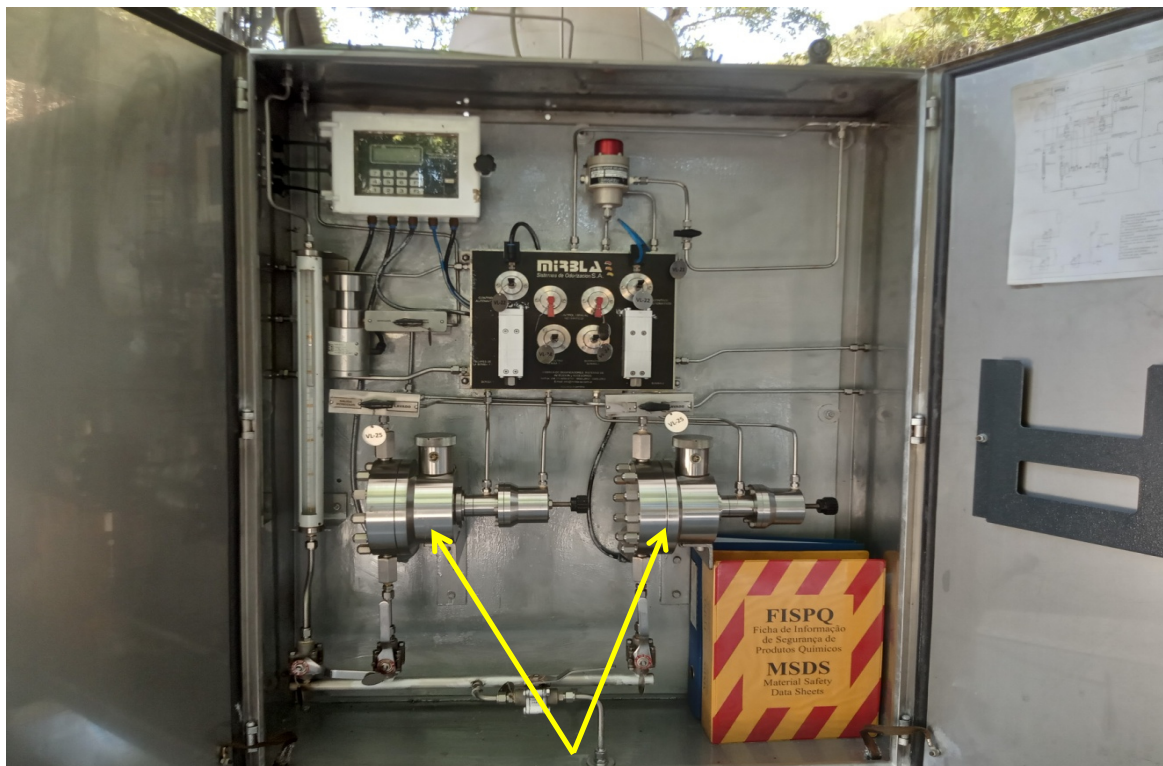
Foto 8: Equipamento de odorização (bombas pneumáticas)
