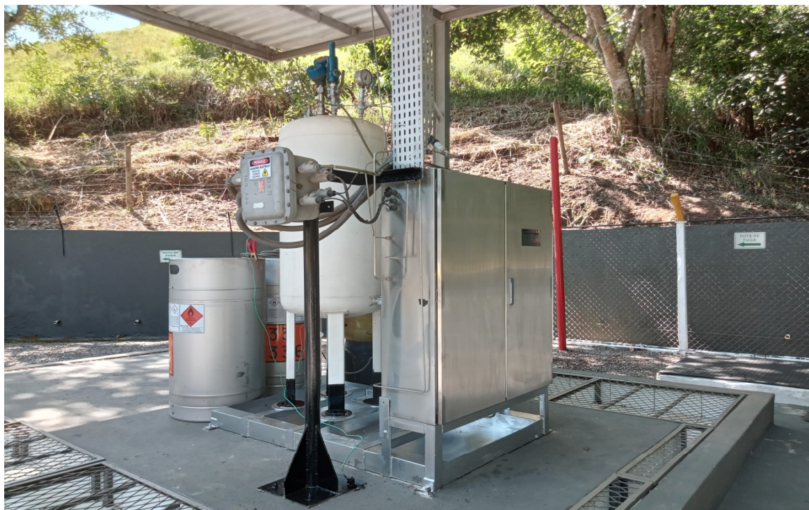
Foto 7: Estação de odorização
