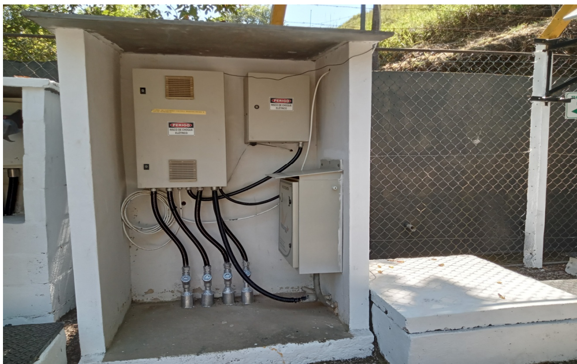
Foto 11: Painéis elétricos e telemetria
