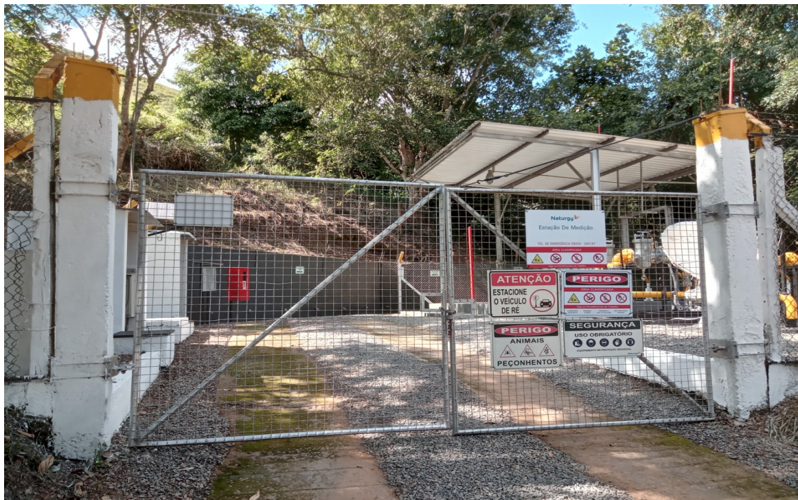
Foto 13: Portão desalinhado e ausência de cerca na parte superior
