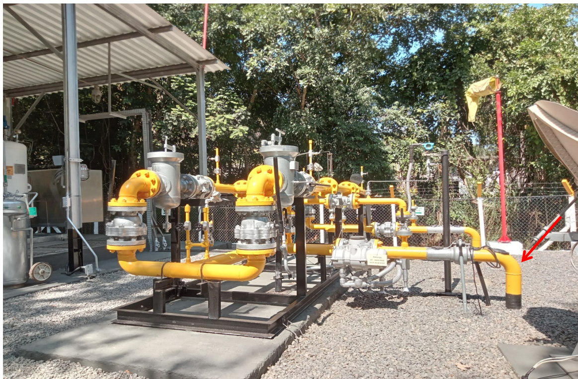
Foto 4: Linha de entrada, sistema de filtragem e medição do gás
