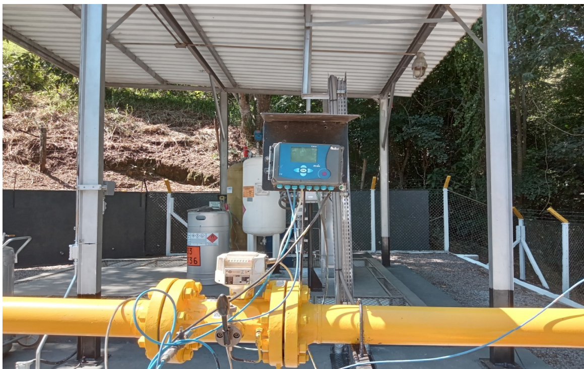
Foto 5: Medidor tipo turbina e conversor de volume
