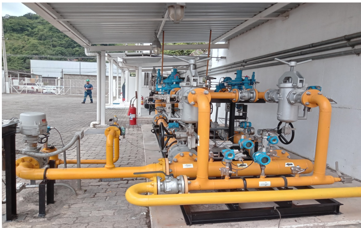
Foto 7: Estação de regulação e medição (6 / 1 bar)
