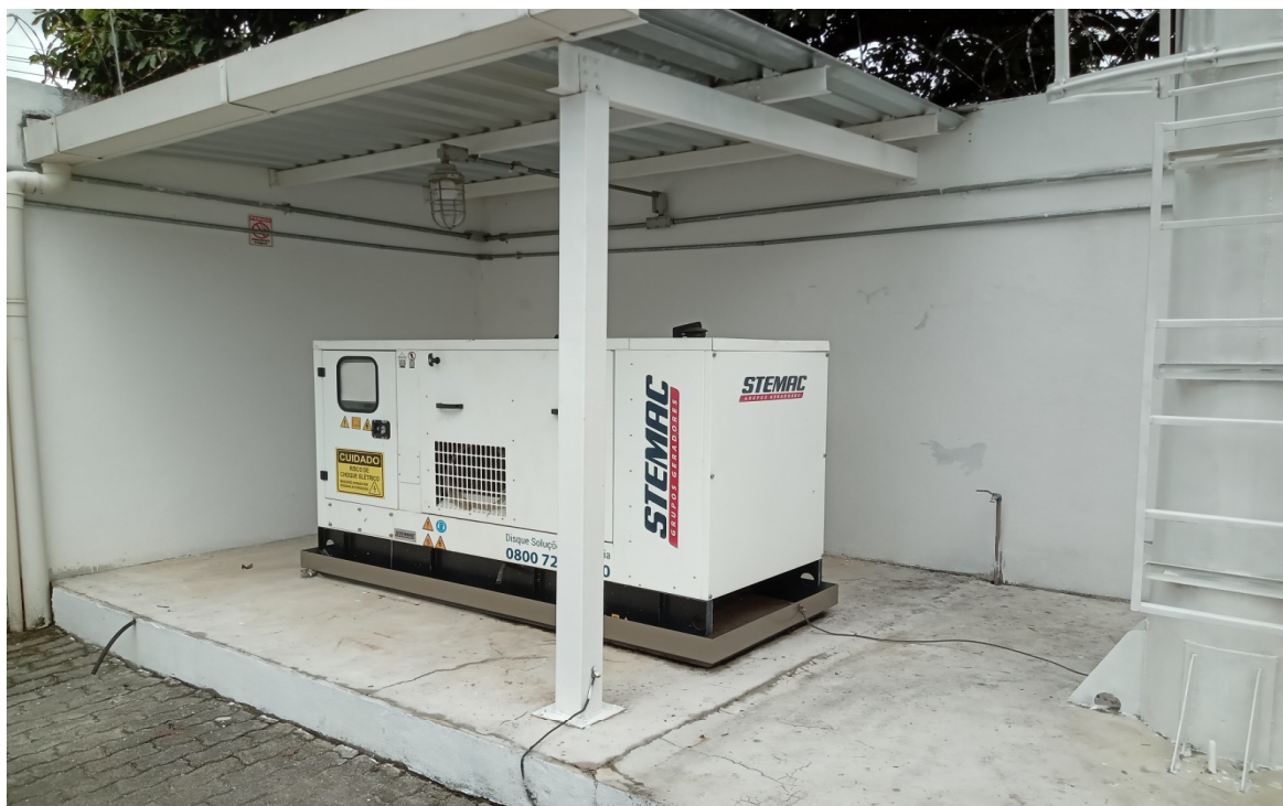
Foto 15: Gerador de emergência
