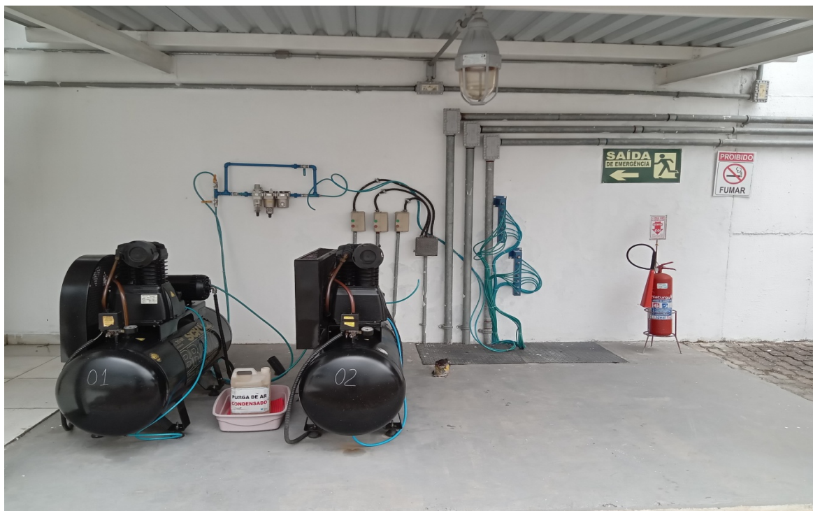
Foto 11: Compressores (sistema de acionamento de válvulas)
