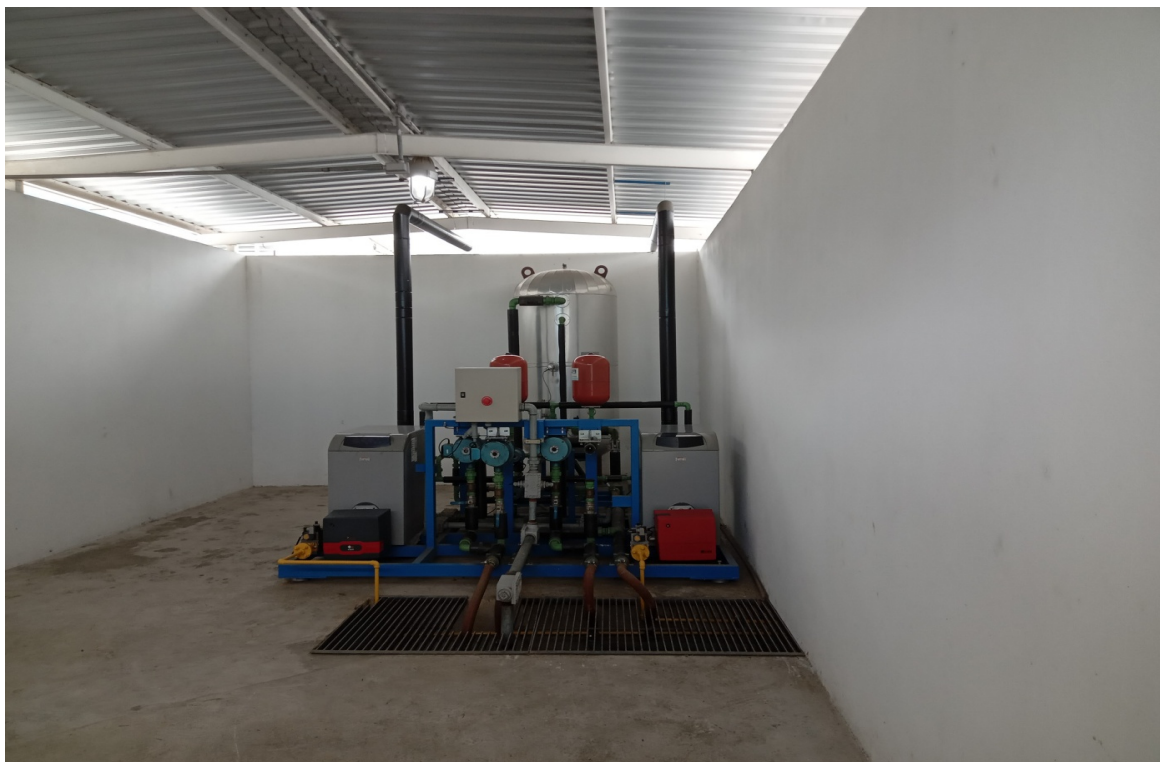
Foto 6: Sistema de aquecimento, armazenamento e recalque de água (Trocador de calor - RCU)
