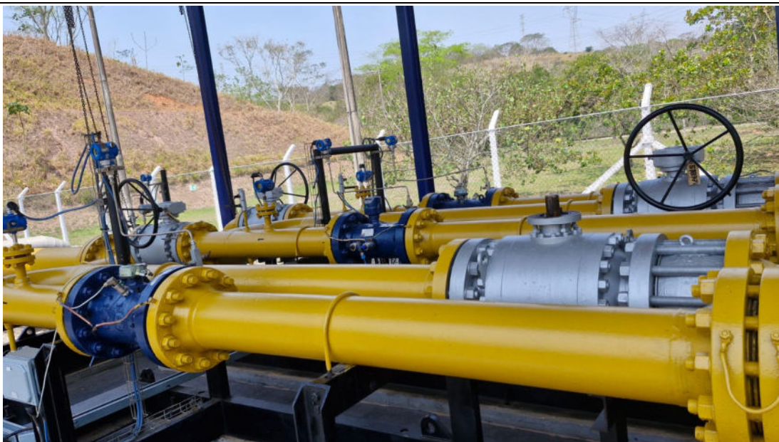
Foto 7: Fim da regulagem e passagem pelos medidores.
