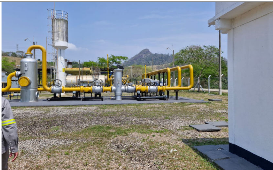
Foto 5: Duto direcionado à UTE, filtragem ao lado esquerdo e centro, derivações para regulagem seguindo ao lado direito. Trecho passava em 3 linhas pelas caldeiras originalmente, sendo unificado mais à frente.
