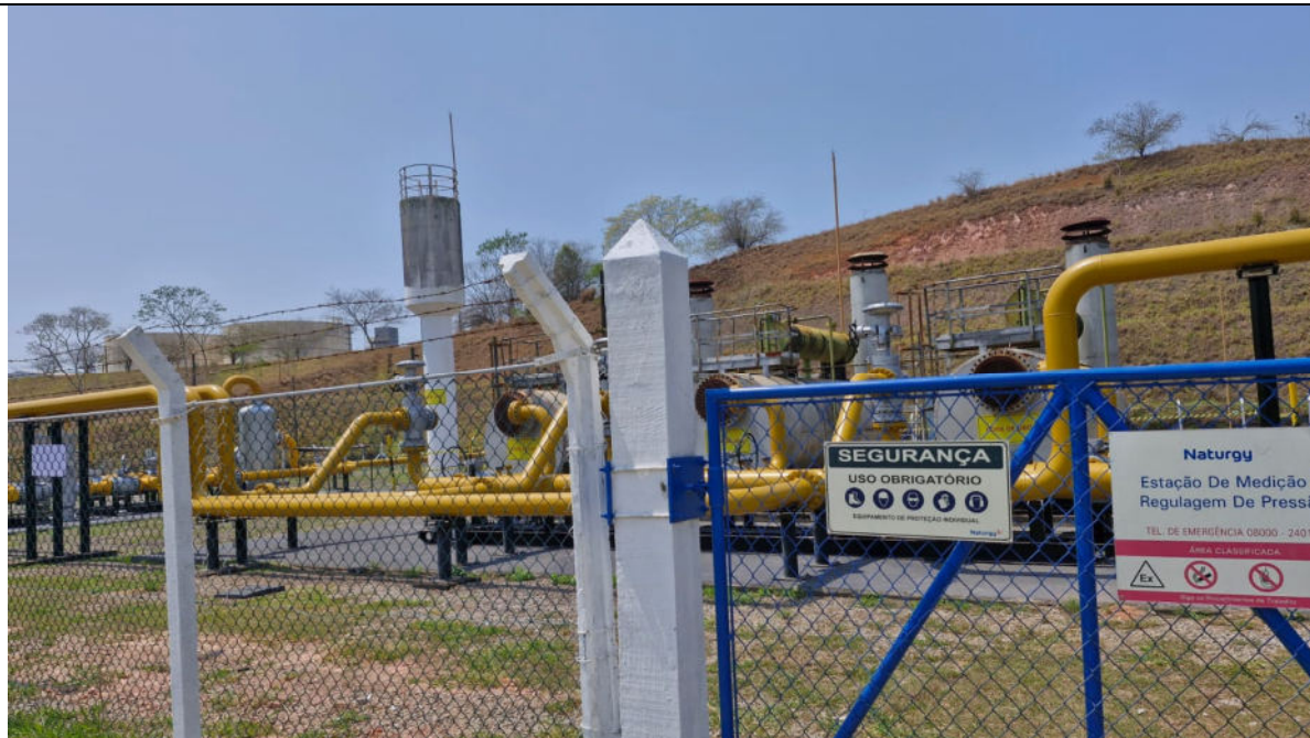
Foto 2: Entrada do City Gate, placas de sinalização de perigo, uso de EPI e vista da Estação.
