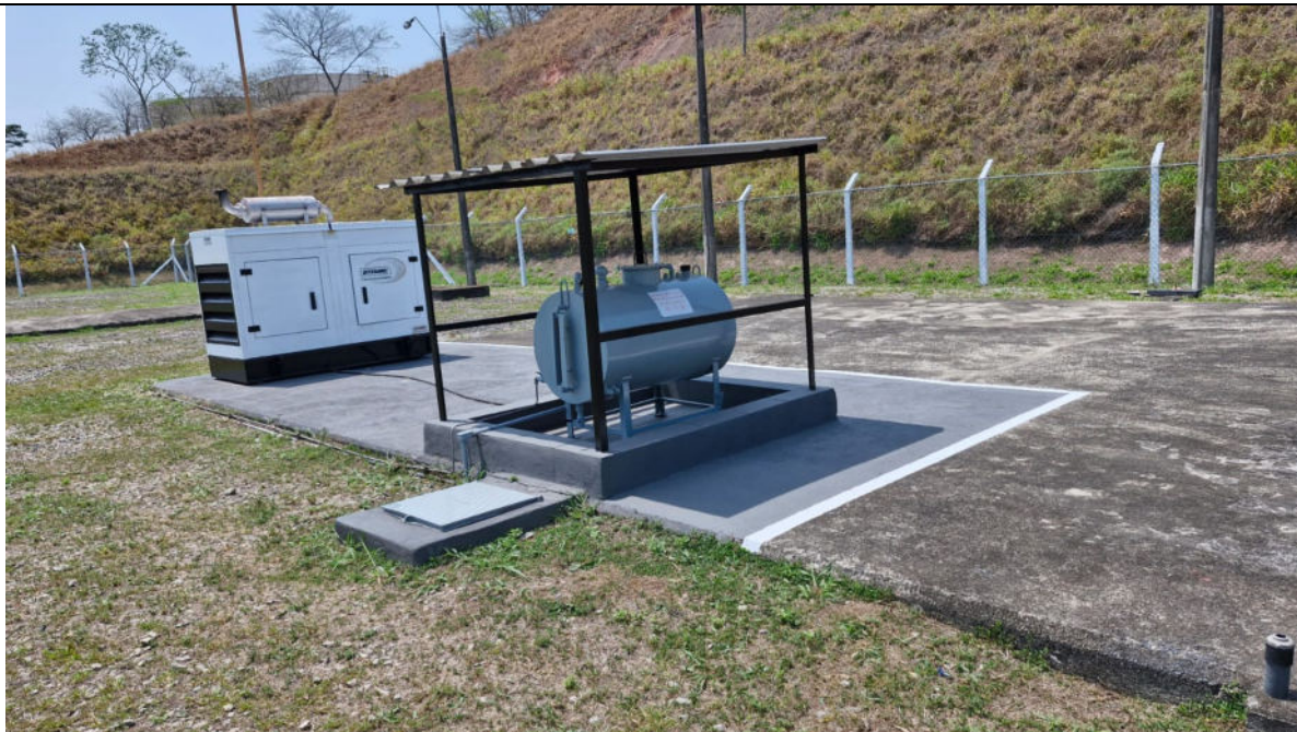
Foto 8: Gerador a diesel encontrado na estação, para abastecer sala de cromatografia e sala de acomodação de funcionários.
