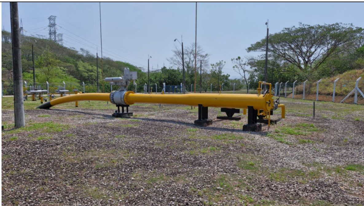
Foto 4: Trecho do Canhão Recebedor de PIG, e válvulas de bloqueio.
