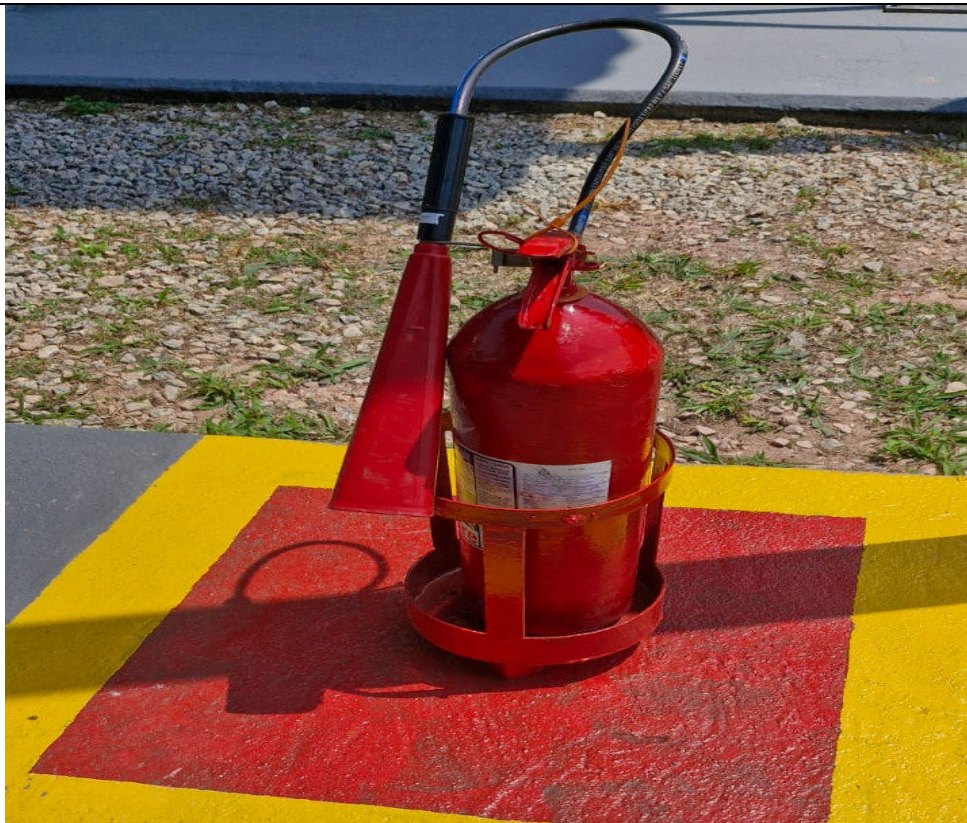
Foto 15: Um dos extintores disponíveis. Falta da documentação impediu checar se atendia posicionamento e qualidade requisitados..
