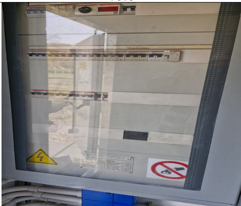
Foto 14: Quadro de energia da sala de operação do gerador.
