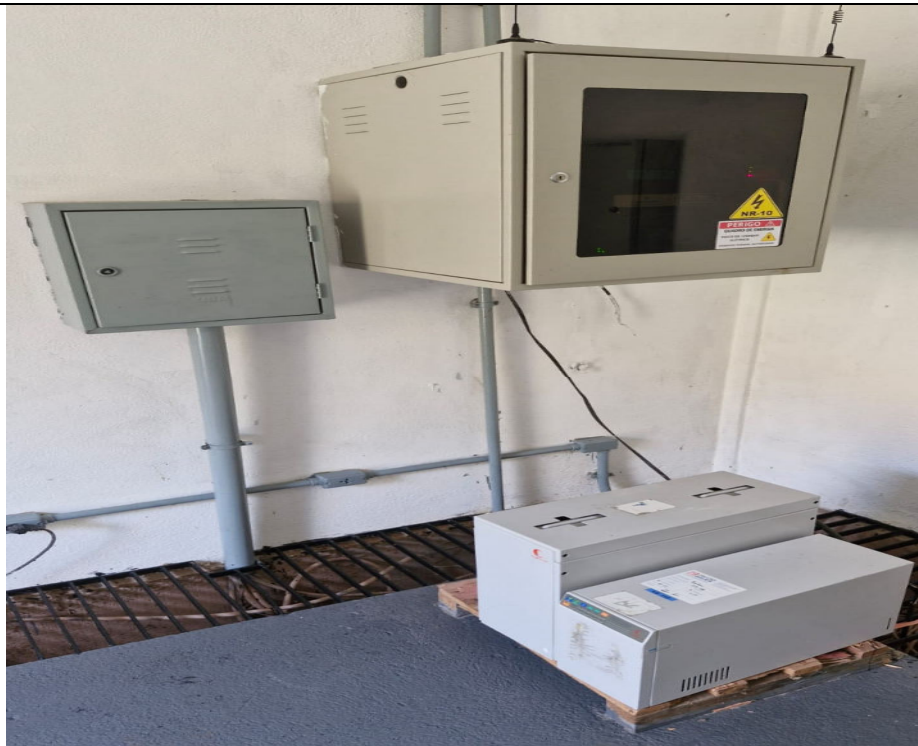
Foto 13: Equipamento de telemetria e telecomando.
