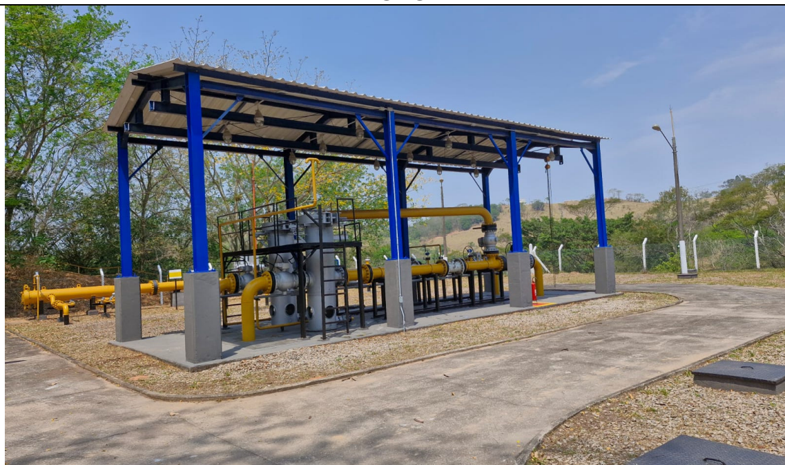
Foto 3: Vista da área principal da estação. Filtros ao lado esquerdo, sinalizando a entrada do gás, medição mais à direita.
