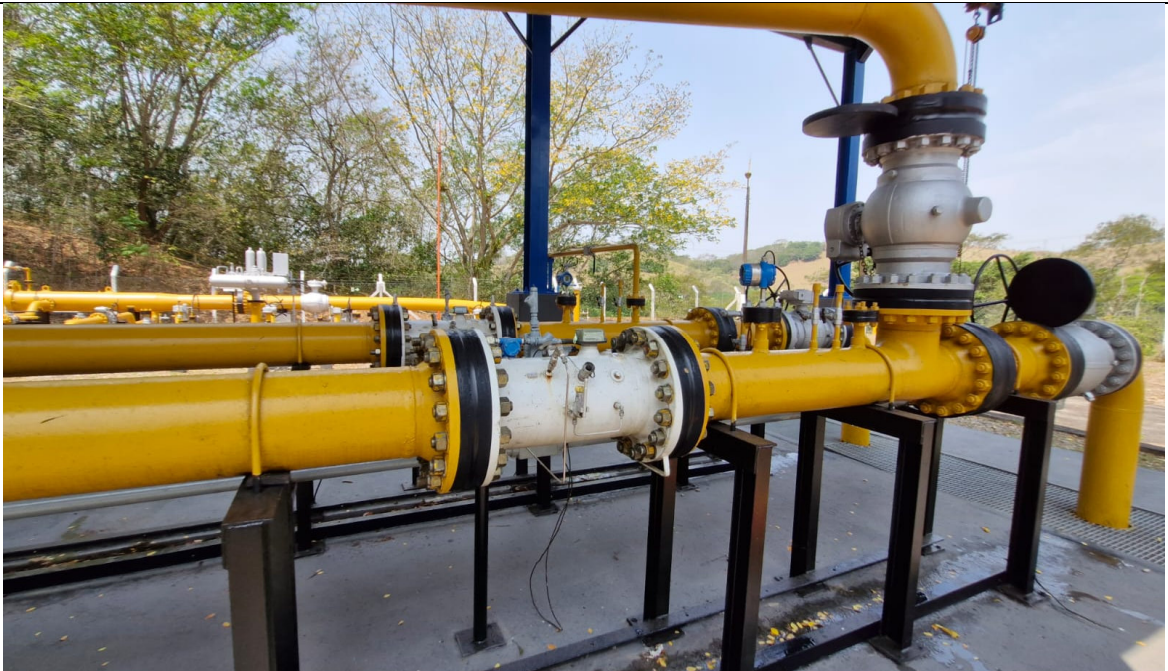
Foto 5: Duto direcionado à UTE, trecho com o medidor volumétrico.
