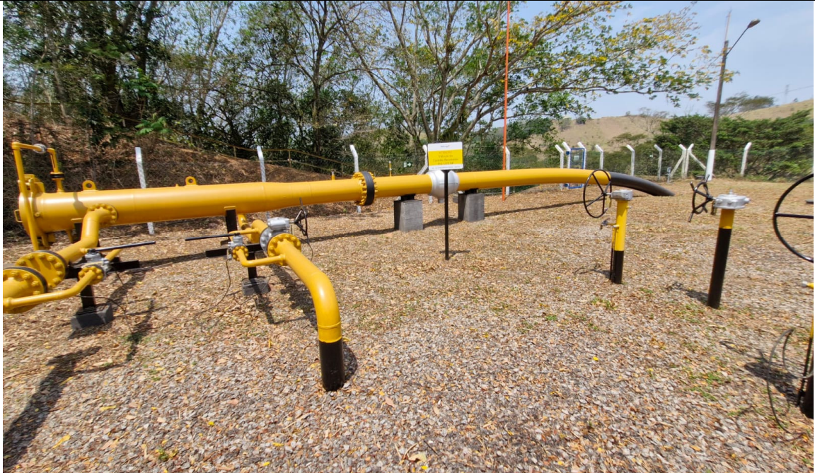
Foto 4: Trecho do Canhão Receptor de PIG, e válvulas de bloqueio.
