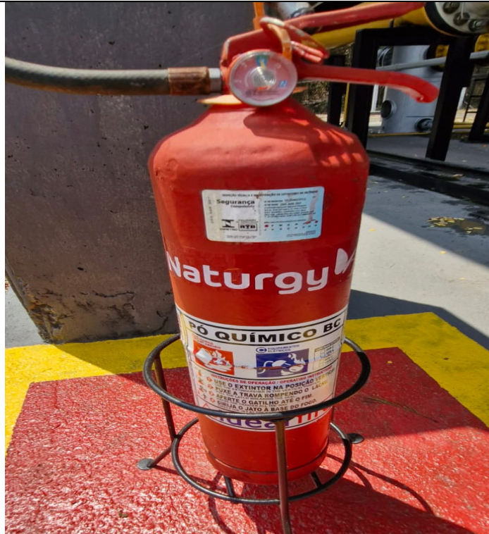
Foto 6: Um dos extintores disponíveis. Falta da documentação impediu checar se atendia posicionamento e qualidade requisitados.
