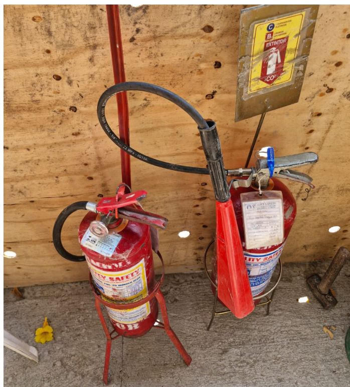
Foto 6: Extintores de Incêndio.
