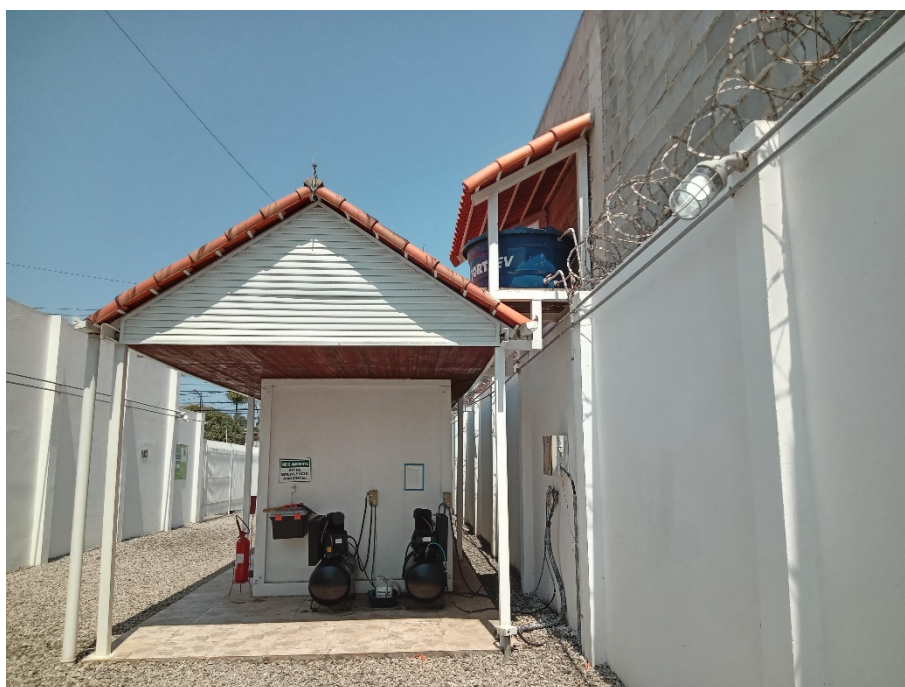
Foto 6: Compressores de ar para acionamento e controle das válvulas da RCU.
