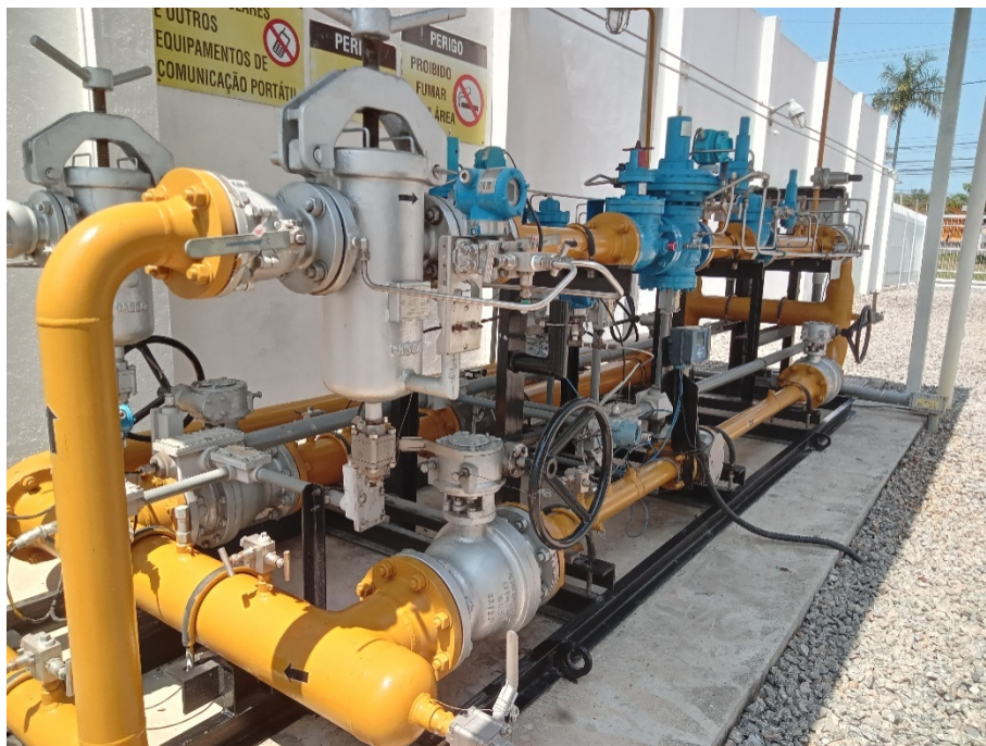
Foto 8: Estação de Regulação e Medição 6/0,8 bar.
