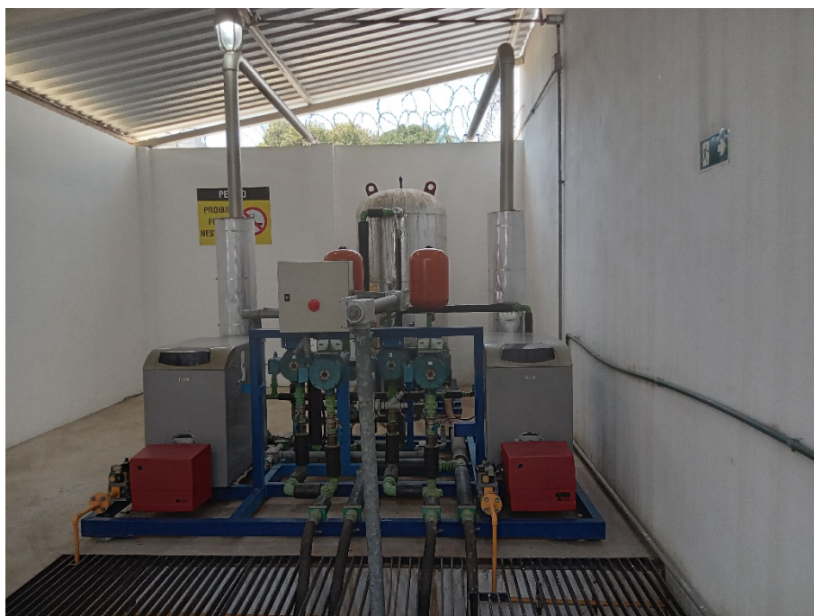
Foto 4: Sistema de aquecimento, armazenamento e recalque de água para os trocadores de calor da RCU.
