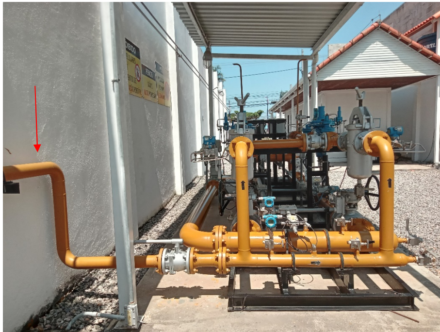
Foto 7: Tubulação de gás que sai da RCU e segue para a ERM da Concessionária.
