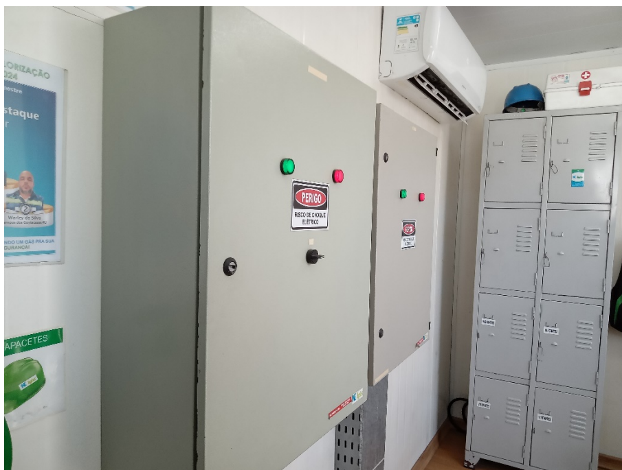
Foto 10: Painéis elétricos na sala de operação.
