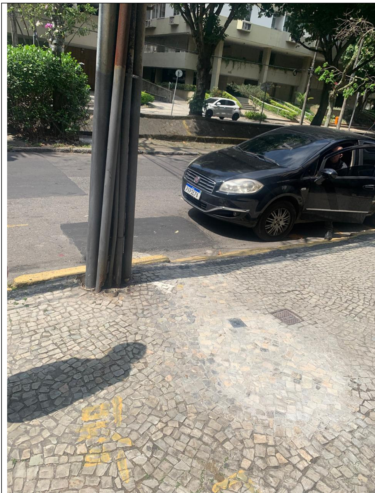
Foto 5: assentamento no passeio.
