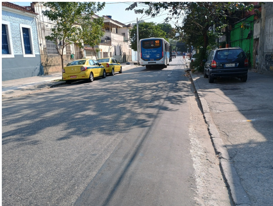
Foto 2: assentamento na via de veículos.
