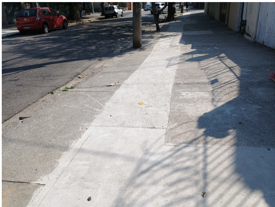
Foto 3: assentamento no passeio.
