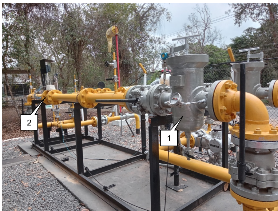
Foto 3: Skid industrial da estação de medição – filtro (1) – medidor (2).
