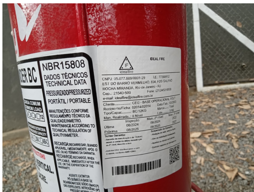
Foto 9: Extintor de incêndio.
