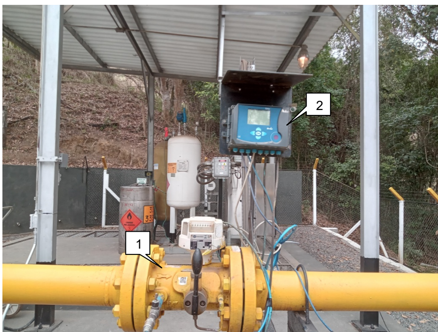
Foto 6: Medidor de vazão do gás (1) e conversor de volume (2).
