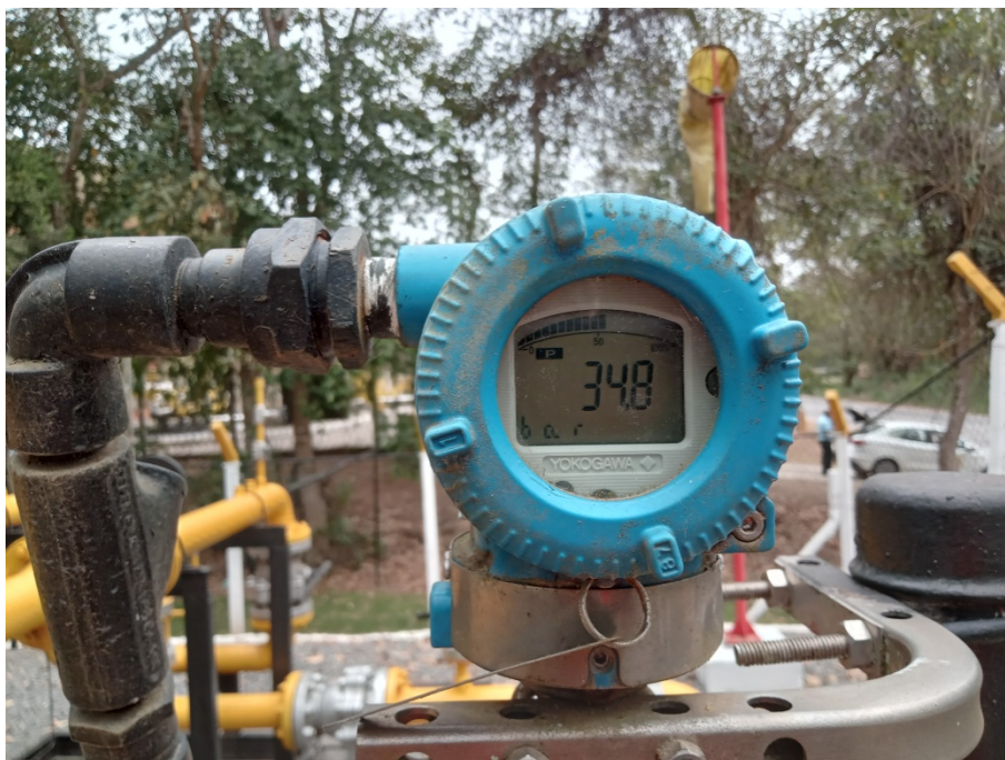
Foto 5: Transdutor de pressão.
