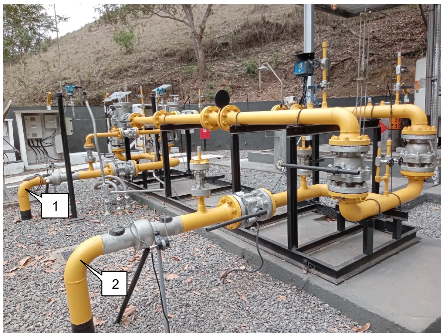
Foto 4: Tubulação de entrada de gás (1) e tubulação de saída de gás (2) .
