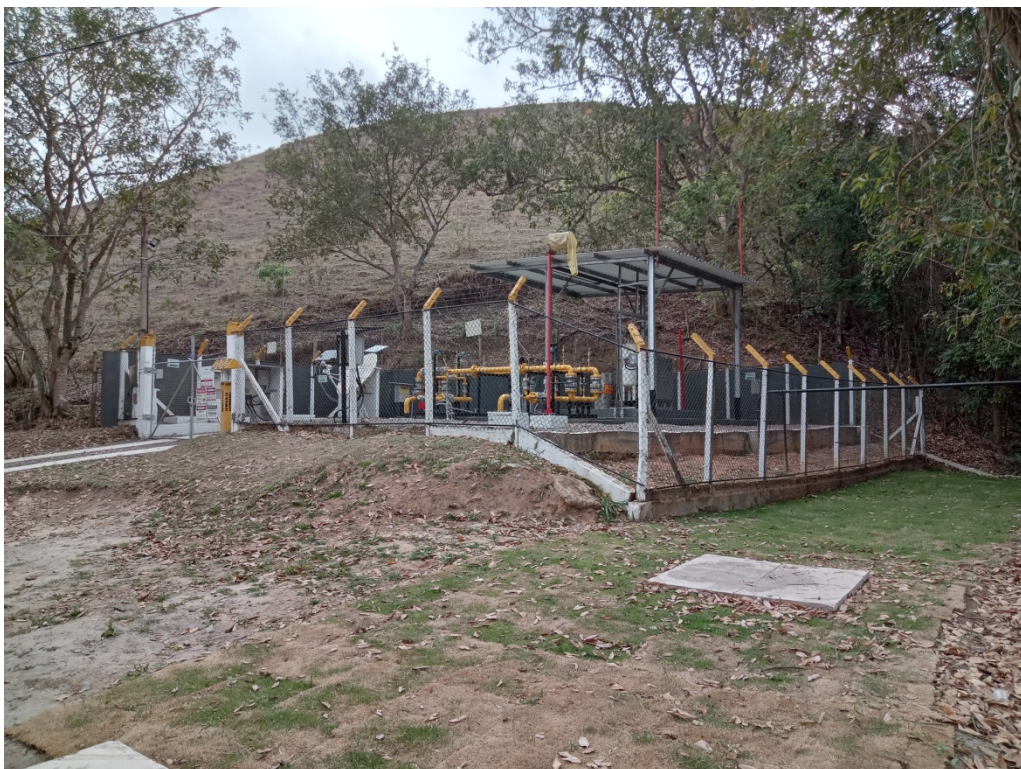
Foto 14: Vista externa estação de medição de gás natural.
