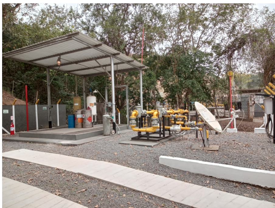
Foto 10: Vista da estação de medição e odoração.
