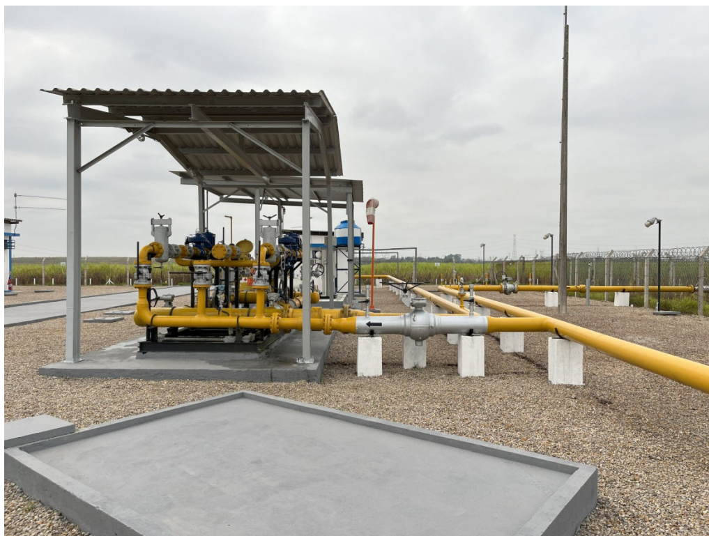
Foto 4: Estação de regulação e medição, que se conecta ao ponto de entrega da TAG pelo gasoduto à direita.
