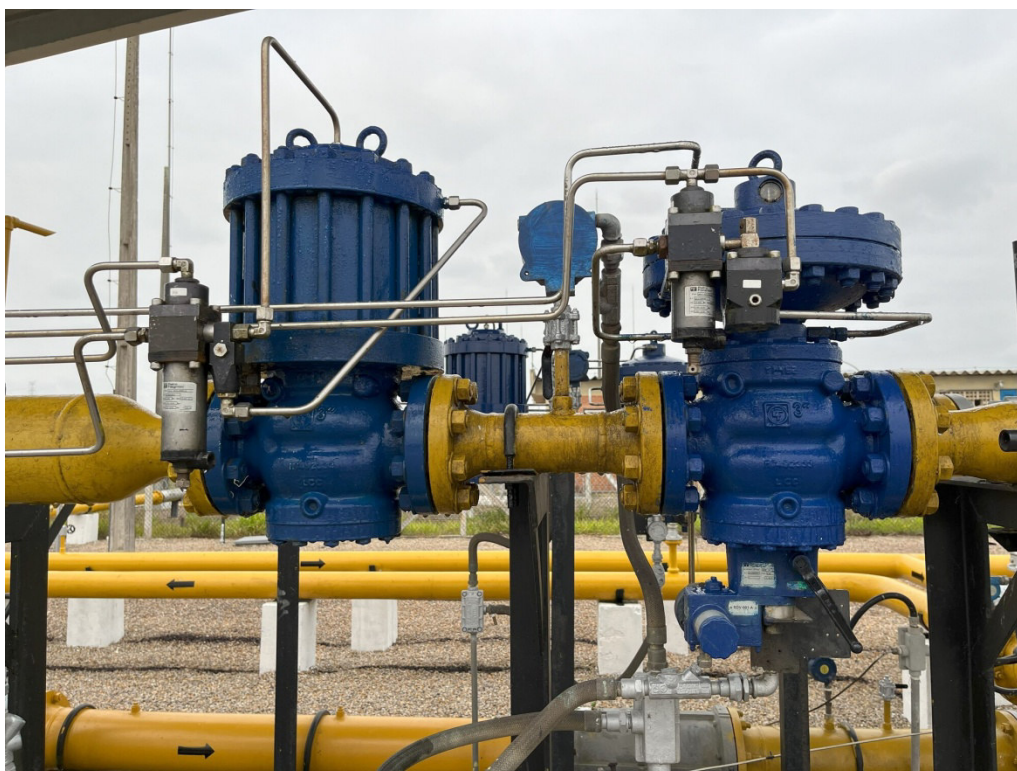
Foto 7: Reguladores de pressão.
