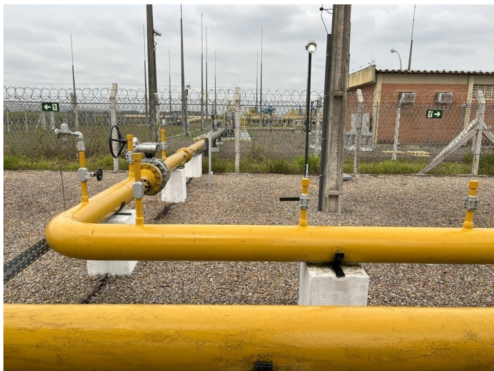
Foto 5: Gasoduto de entrada da estação, proveniente do ponto de entrada da TAG (ao fundo).
