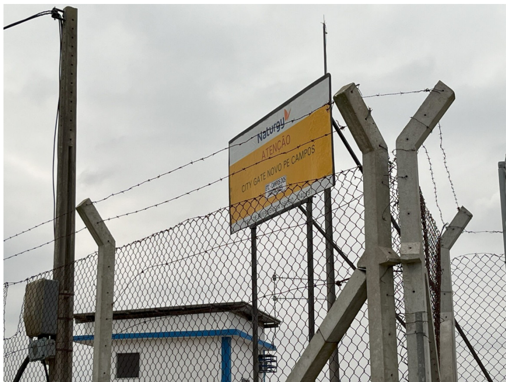
Foto 2: Placa de identificação da ETC de Campos dos Goytacazes.
