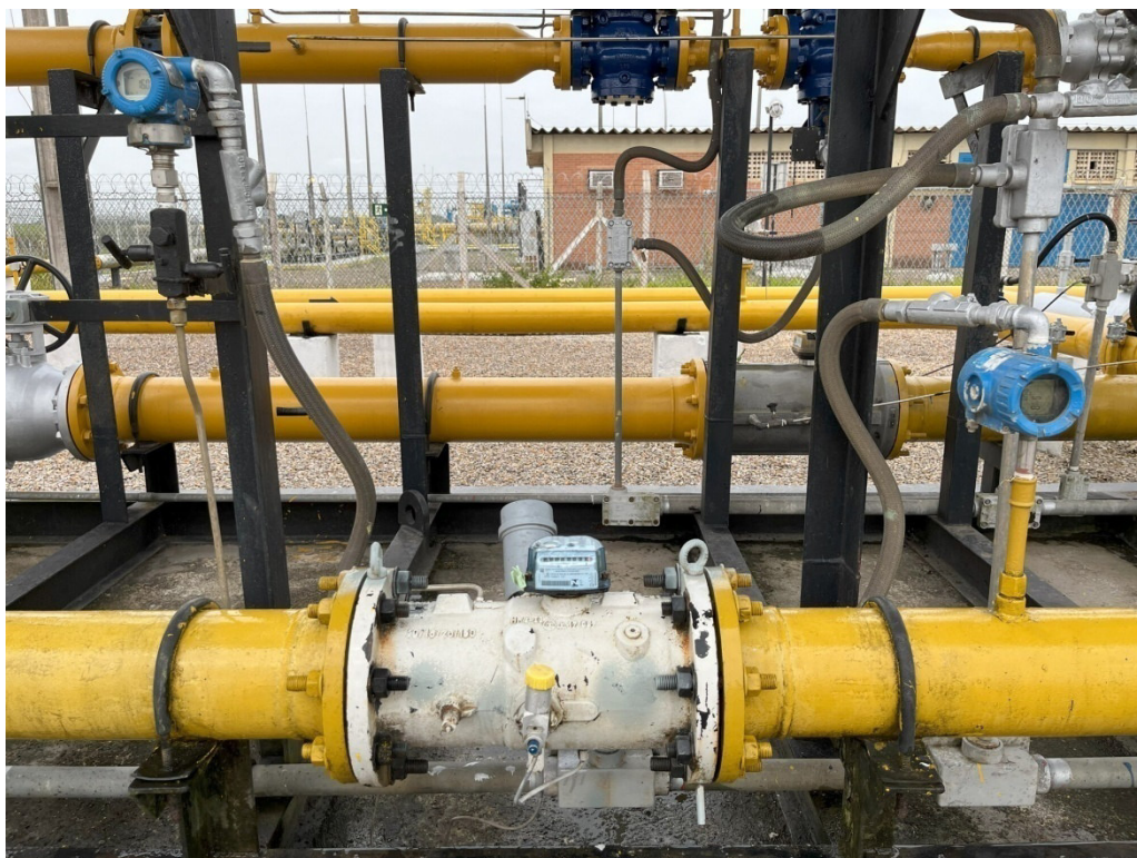
Foto 8: Medidores de volume (abaixo); pressão (acima à esquerda); e temperatura (à direita).
