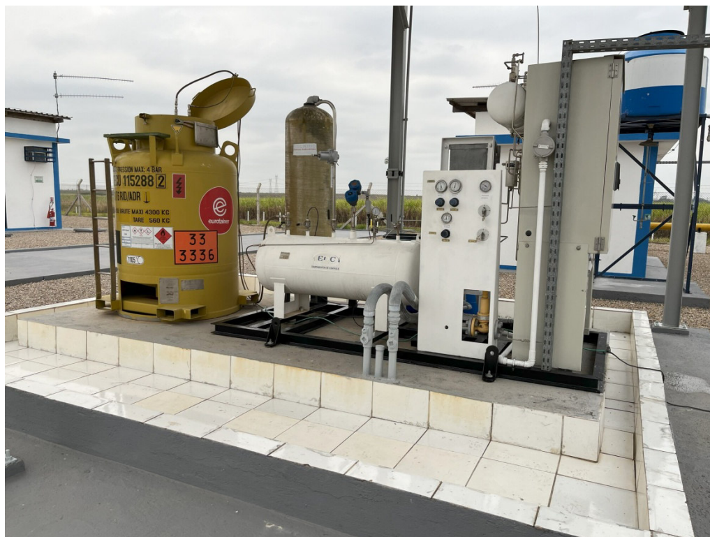
Foto 10: Estação de odorização.
