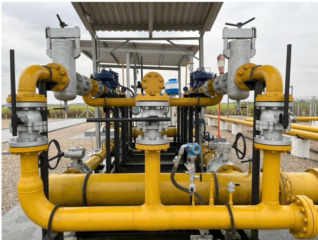
Foto 6: Estação de regulação e medição.
