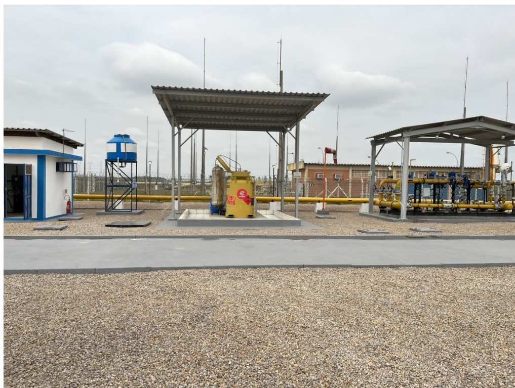
Foto 9: Da direita para a esquerda, na direção do fluxo de gás no gasoduto (visível ao fundo): estação de regulação e medição, estação de odorização, chuveiro de emergência, e câmara de cromatografia.
