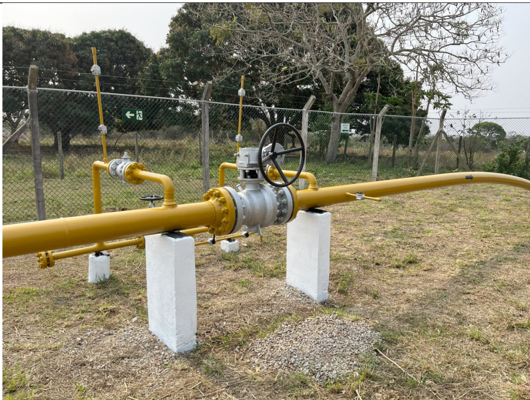
Foto 5: Válvula de bloqueio XV-120.
