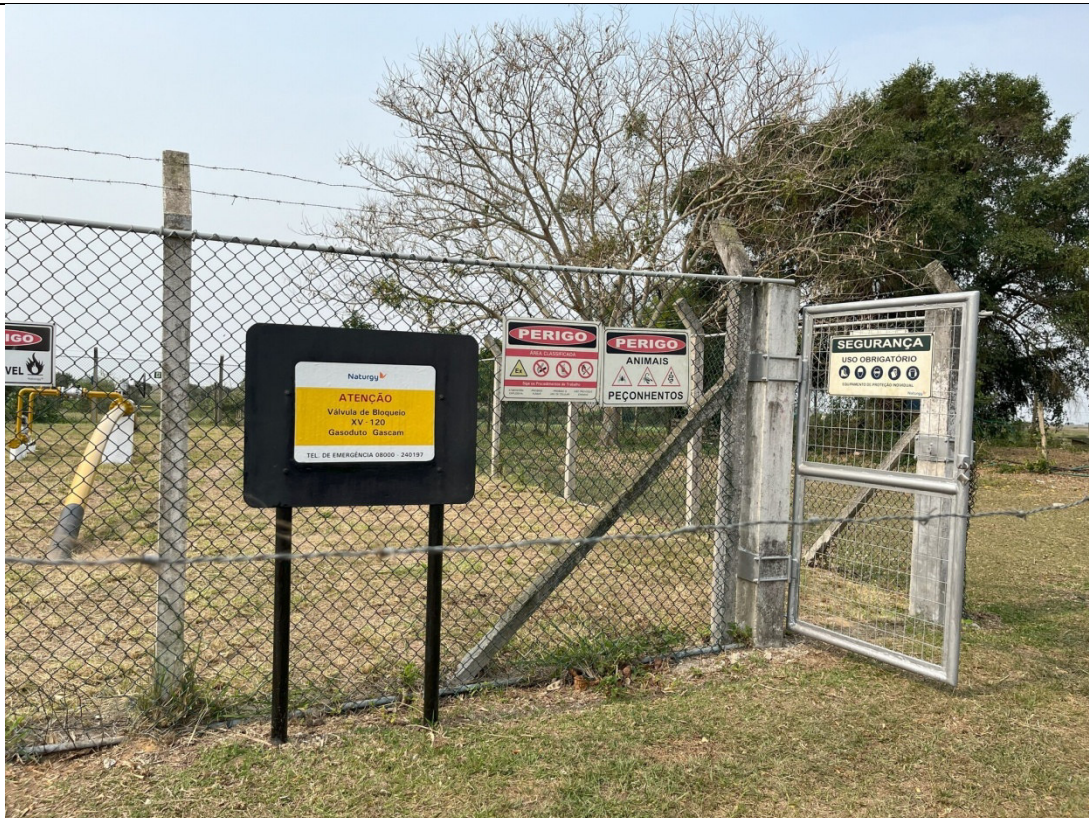
Foto 3: Identificação da válvula e sinalizações de segurança.
