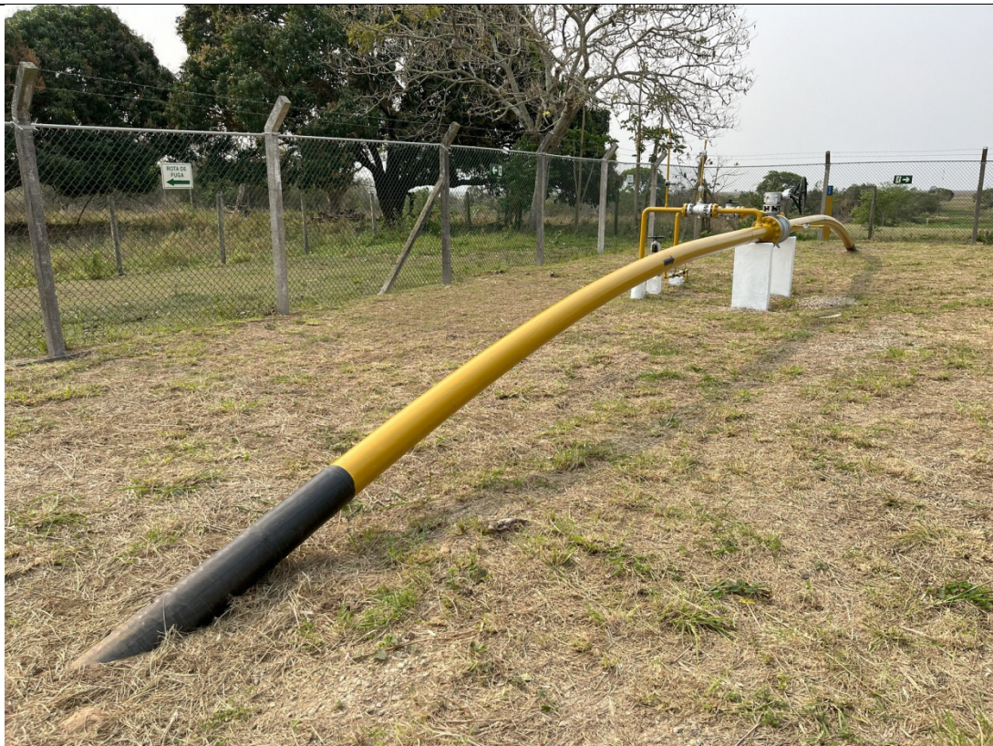
Foto 4: Gasoduto de aço de 6" e válvula de bloqueio.
