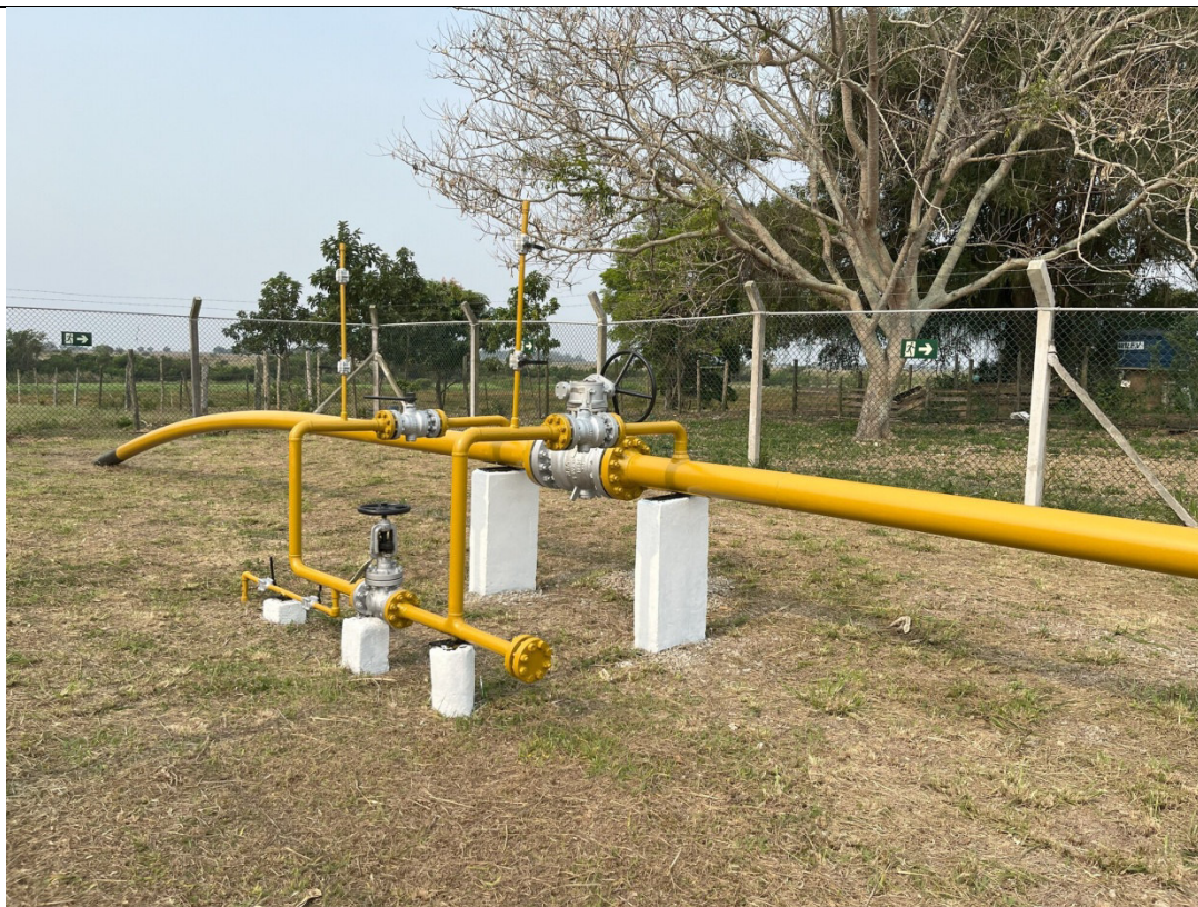
Foto 6: Bypass da válvula de bloqueio.
