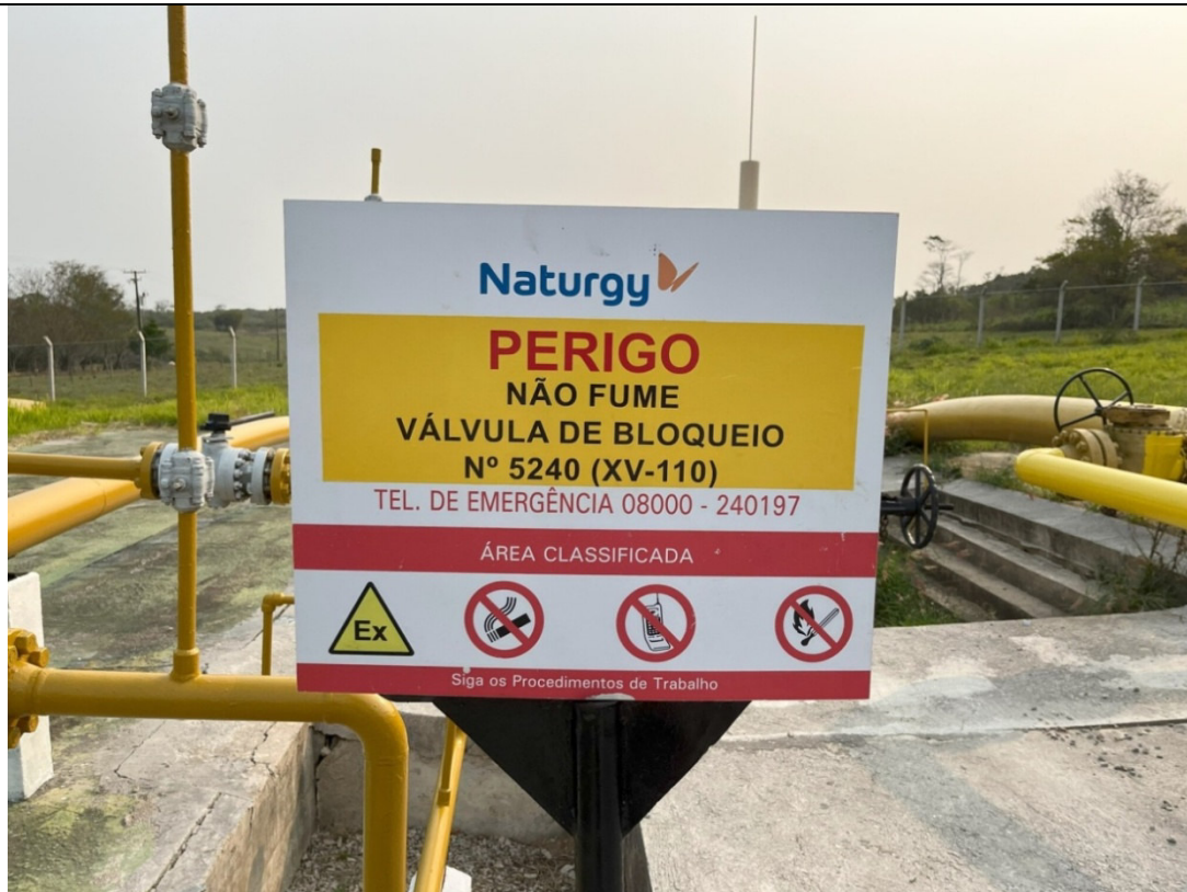
Foto 5: Placa de identificação da válvula com sinalização de segurança.
