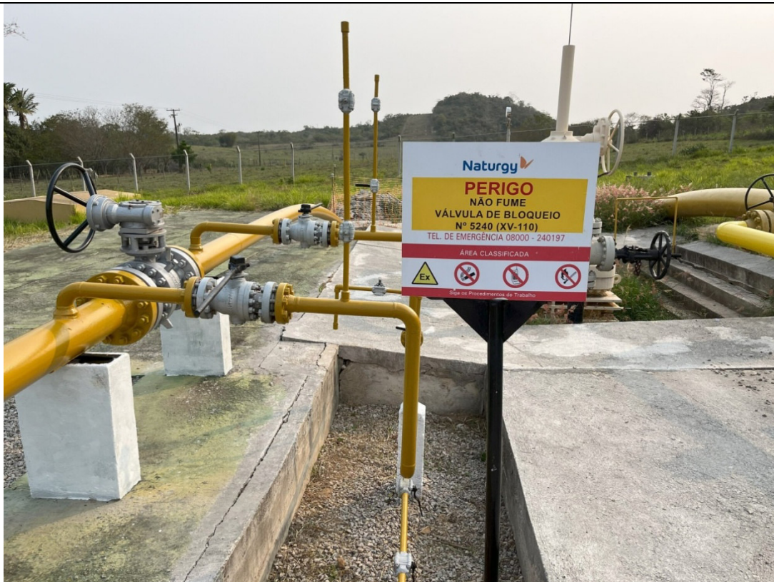
Foto 4: Válvula da Naturgy à esquerda e sua placa de identificação.
