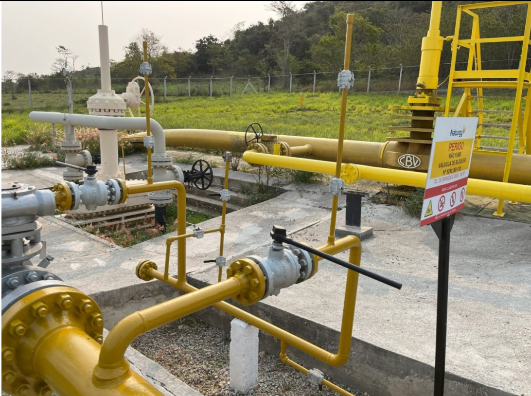
Foto 7: Bypass da válvula; duto da Transpetro visível ao fundo.
