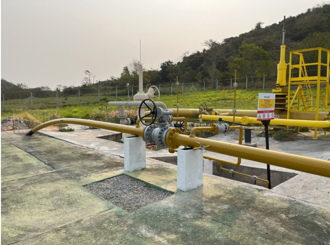
Foto 6: Gasoduto de aço de 6" com válvula de bloqueio.
