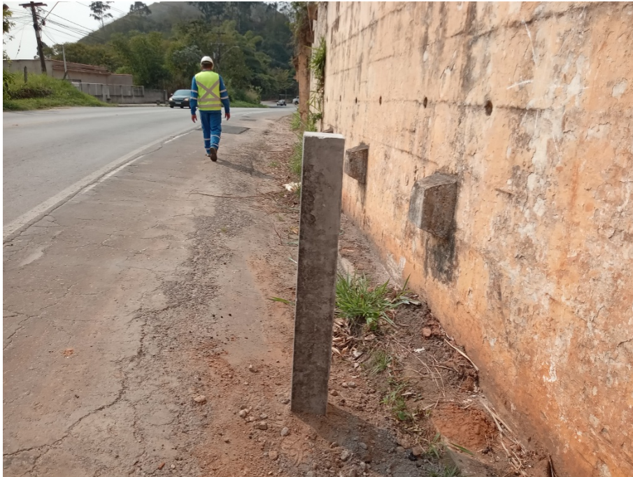
Foto 11: Marco vertical de concreto sem pintura das indicações.
