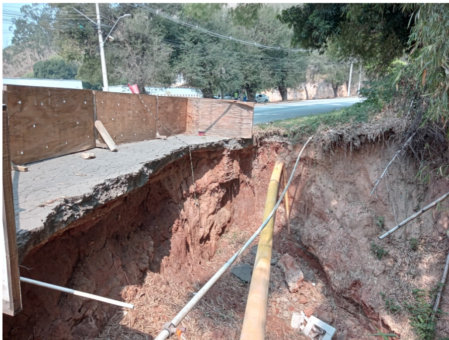
Foto 10: Tubulação exposta em local onde ocorreu erosão.
