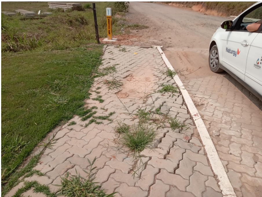
Foto 4: Trecho da calçada com deformidades.
