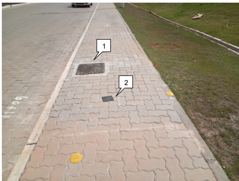
Foto 2: Caixa de válvula de rede (previsão para expansão da rede) (1) e válvula de ramal do cliente (2).
