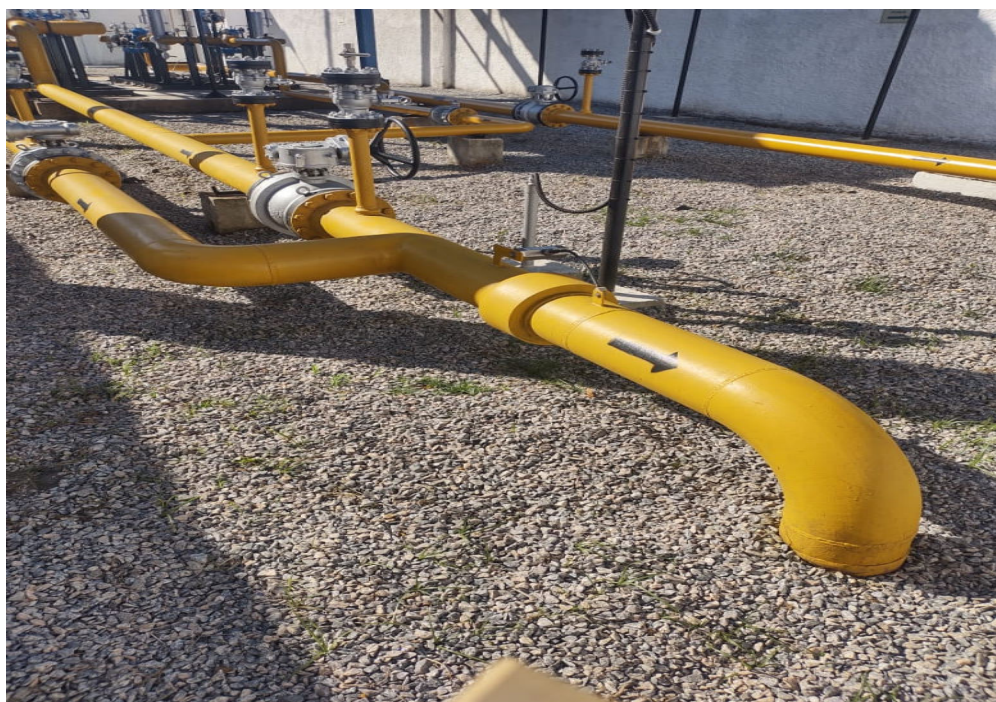
Foto 12: Tubulação de saída para Arraial do Cabo.
