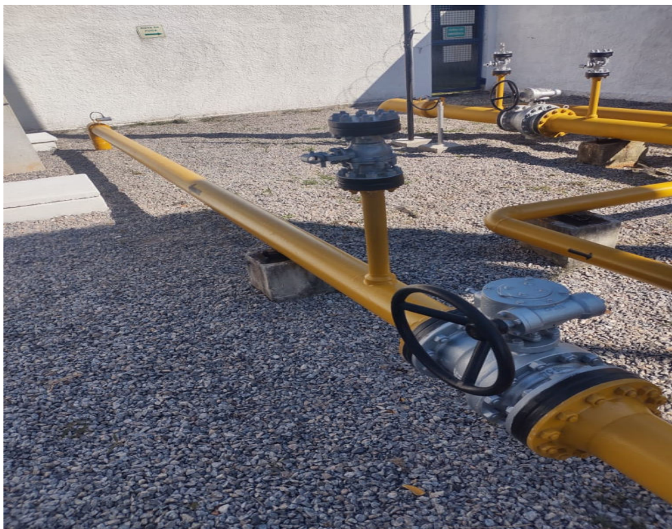
Foto 13: Tubulação de saída para Búzios.
