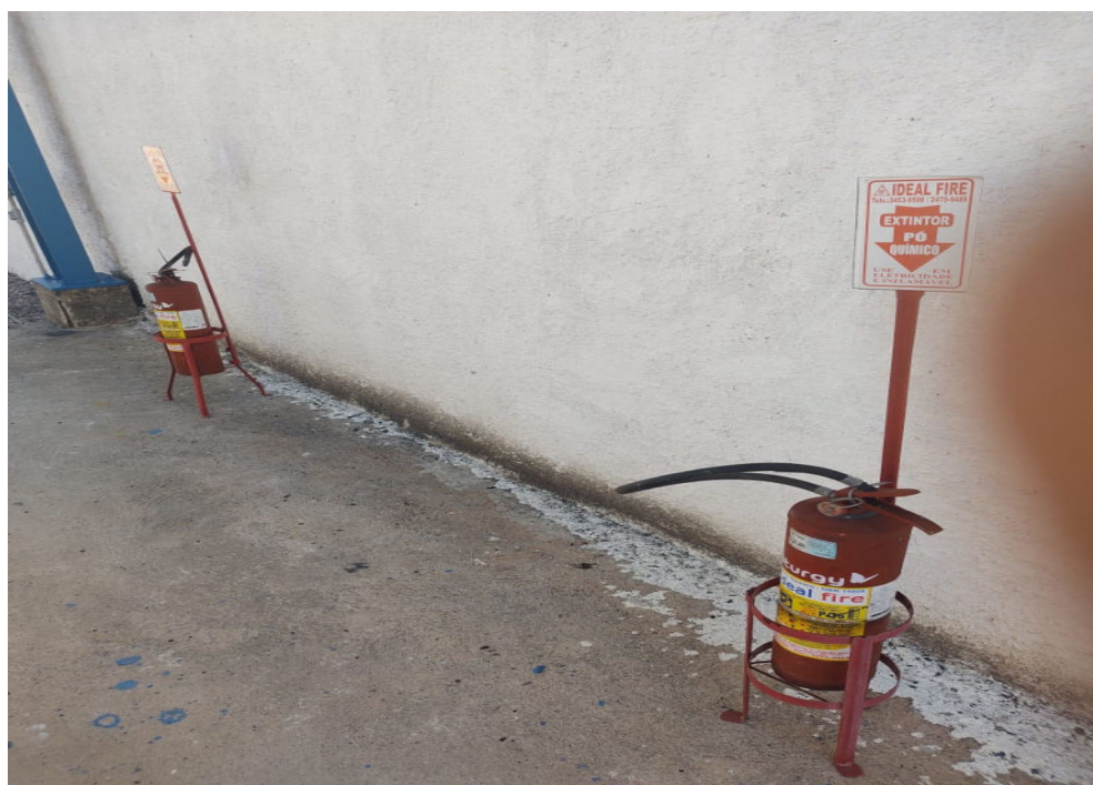
Foto 8: Extintores com prazo de inspeção vencido.
