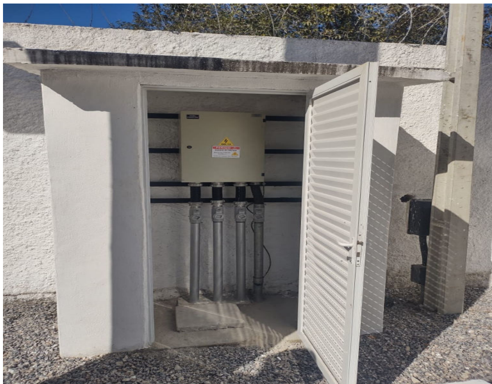
Foto 7: Local de acondicionamento do sistema elétrico.
