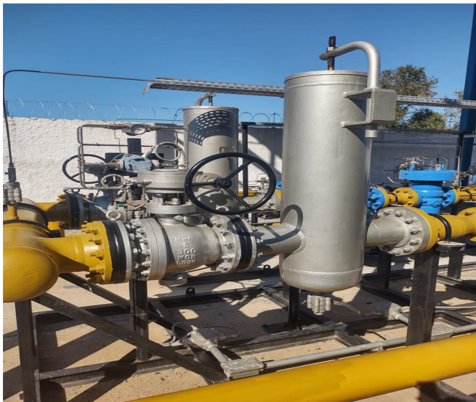
Foto 10: Filtro da linha principal.
