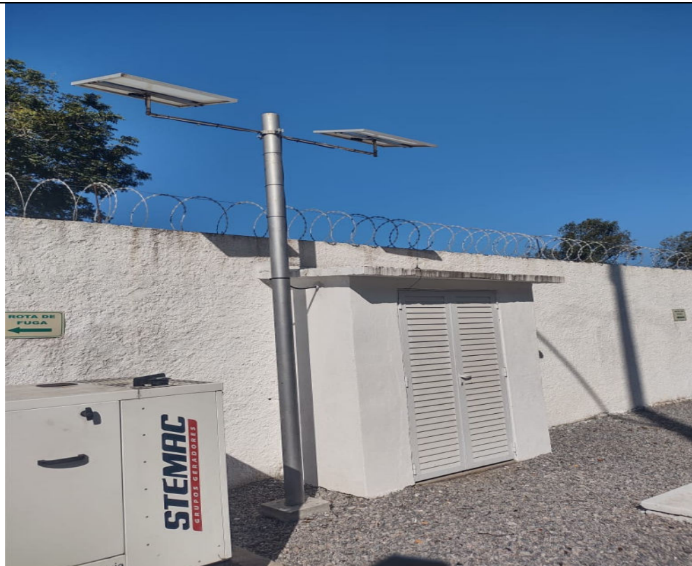
Foto 6: Local de acondicionamento do sistema de telemetria.
