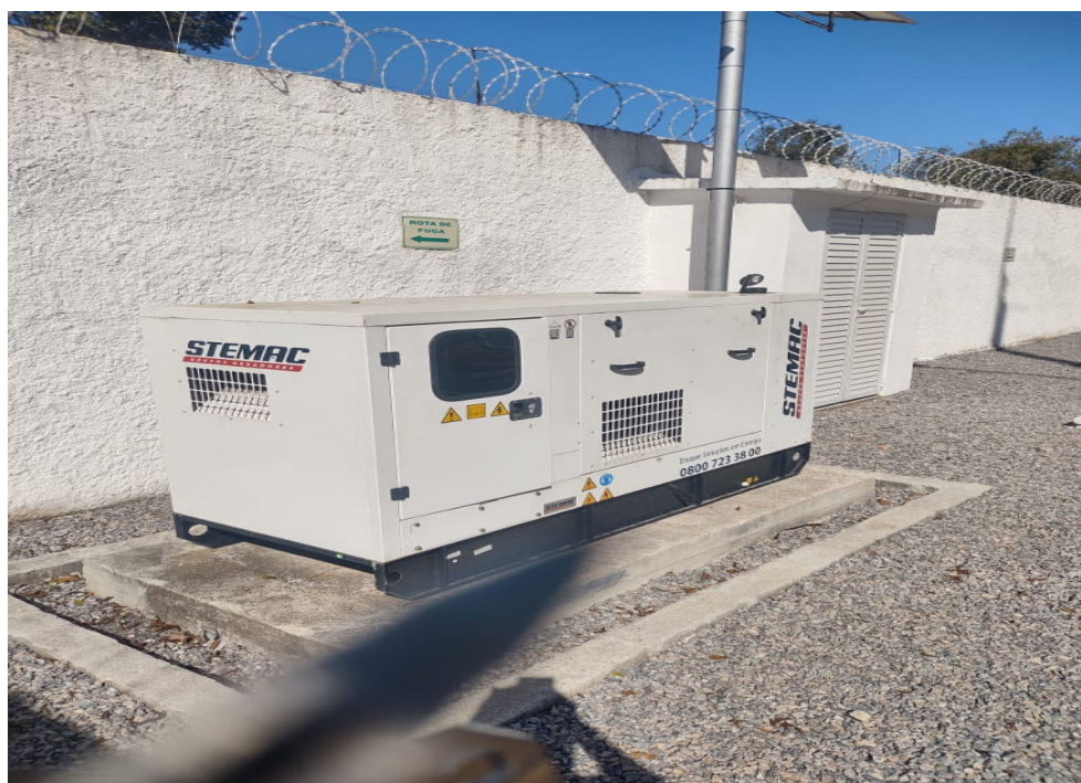
Foto 14: Gerador de energia elétrica.
