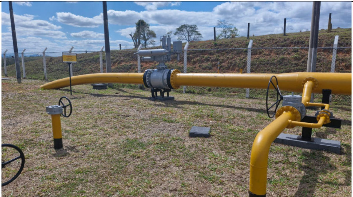
Foto 5: Saída do duto ao fim do lançador.
