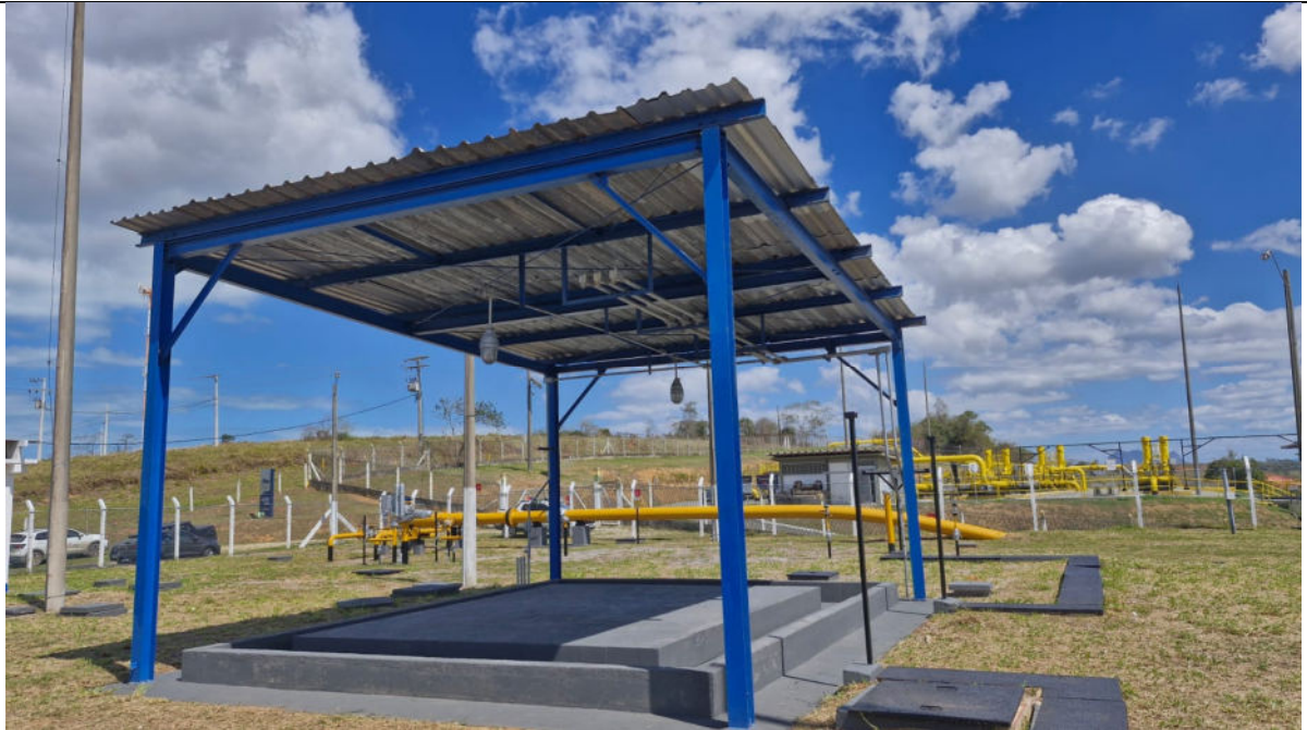
Foto 10: Cobertura da estação, com SPDA funcional.
