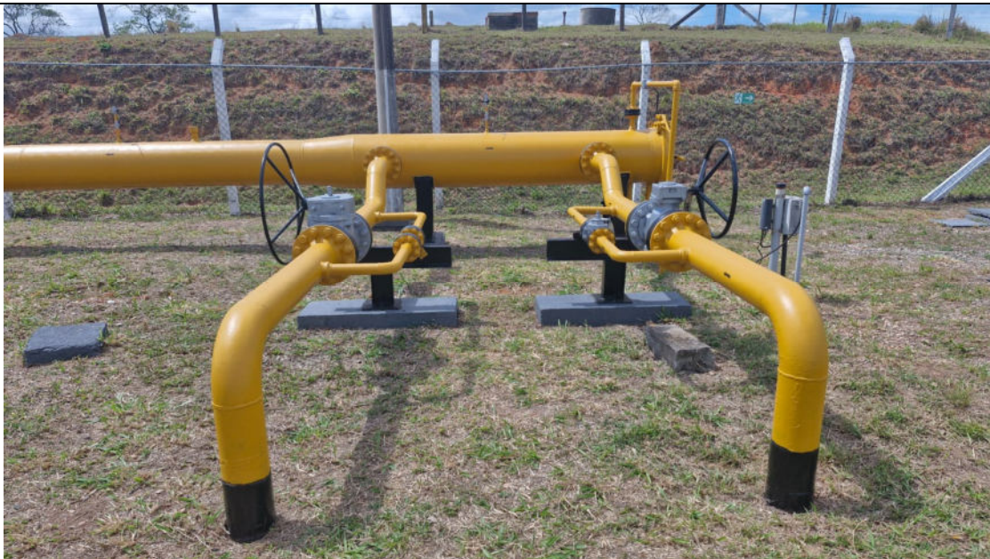
Foto 3: Dutos e lançador de PIG dedicado ao trecho da UTE Termomacaé.
