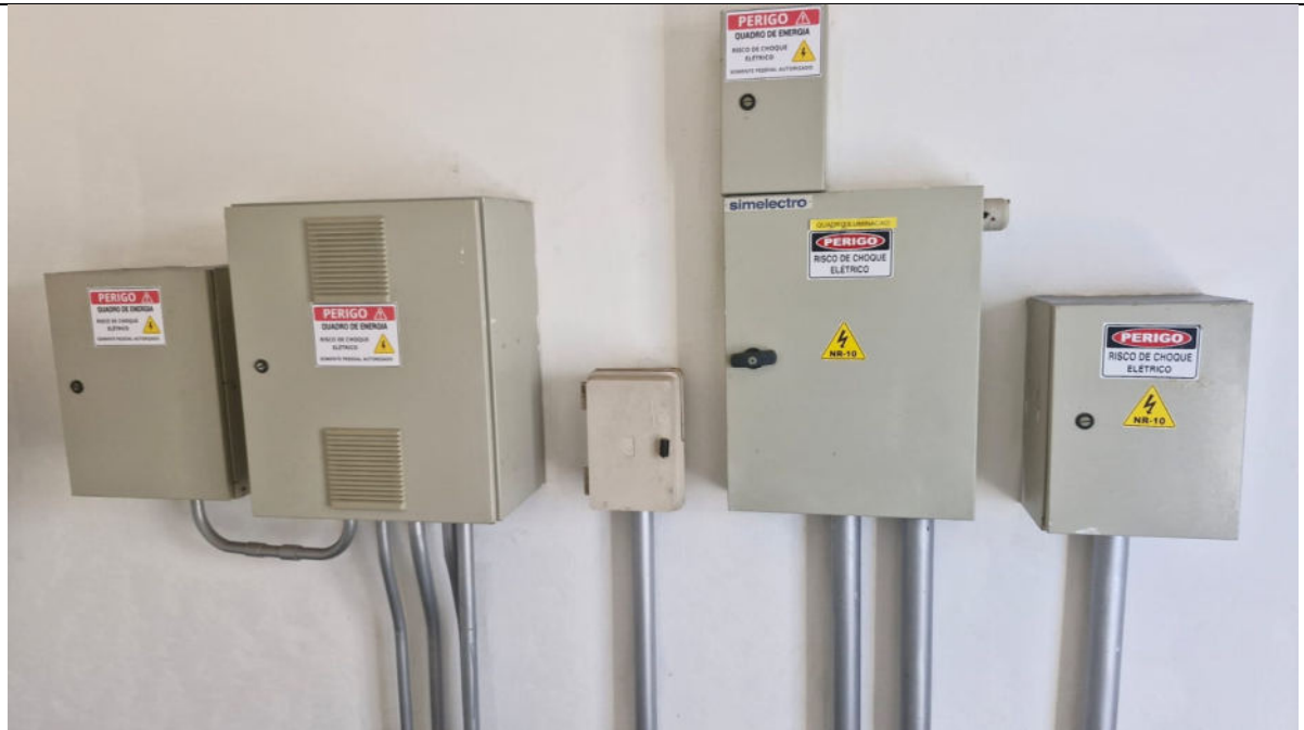
Foto 6: Quadros da instalação elétrica com devida sinalização.
