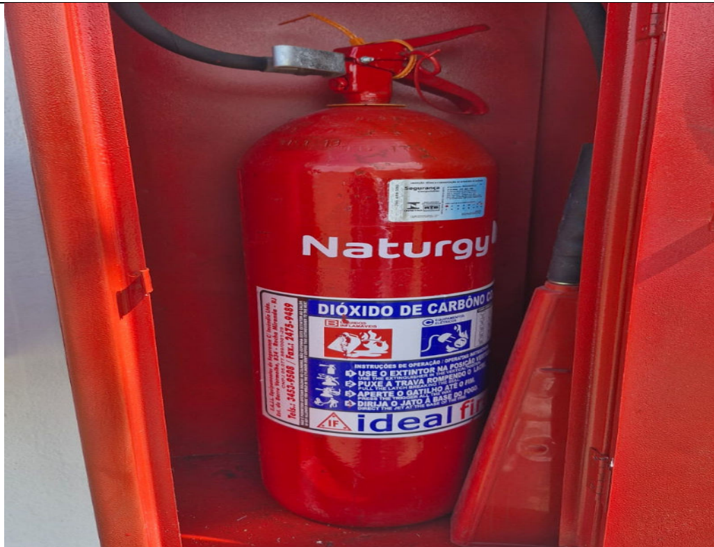
Foto 12: Extintor de incêndio lacrado. Documentação dos bombeiros não estava presente.
