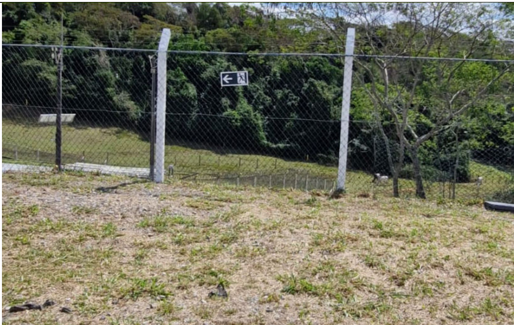
Foto 11: Cerca da estação, com aterramento e placa de rota de fuga sinalizada.
