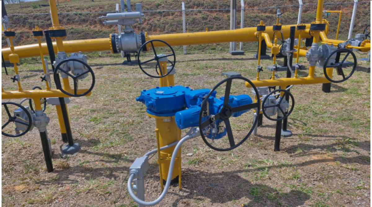
Foto 4: Foco nas válvulas de regulação e medidor.
