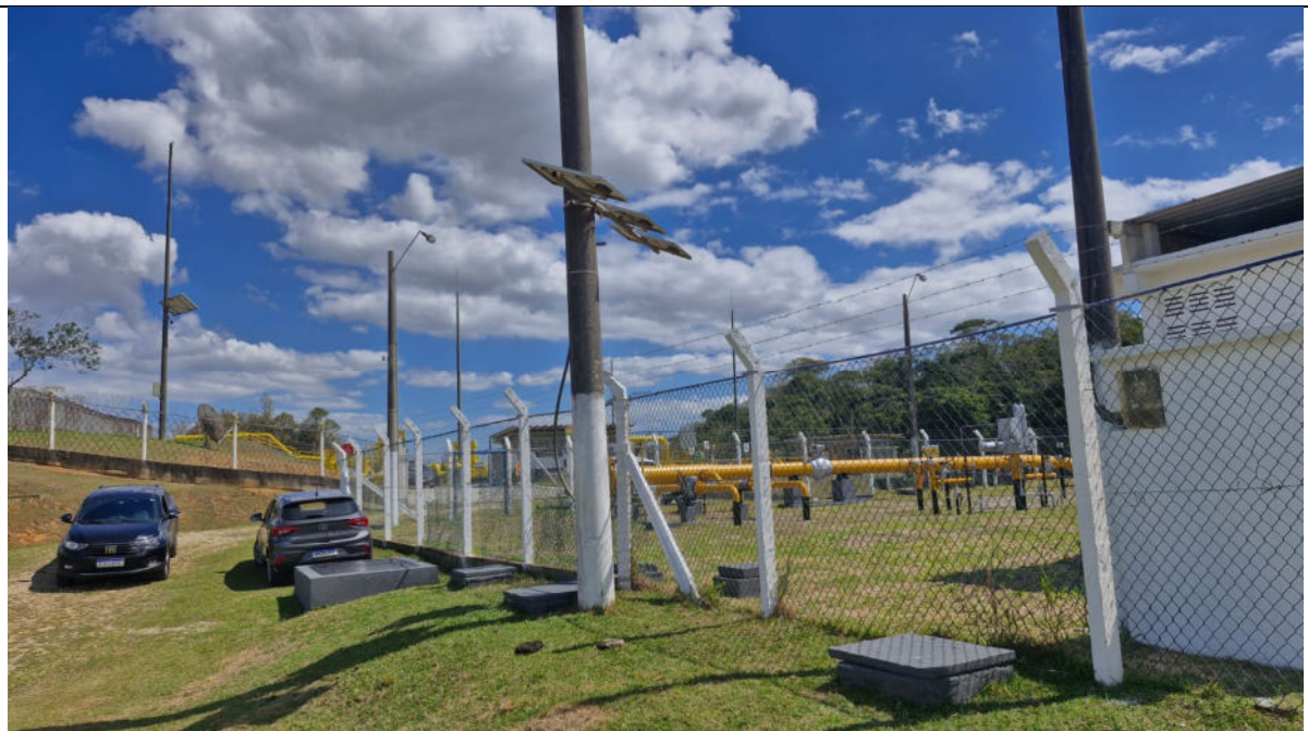
Foto 13: Placas solares para alimentação de sistema de telemetria.
