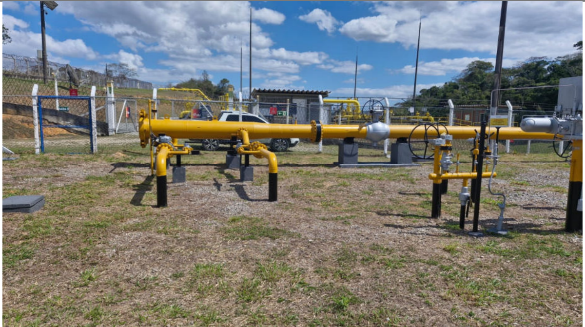
Foto 8: Lançador de PIG dedicado ao trecho de gasoduto para a UTE Norte Fluminense. Instalações da Petrobras ao fundo.
