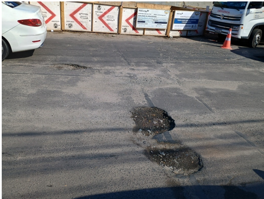
Foto 6: trecho de recomposição inadequada.
