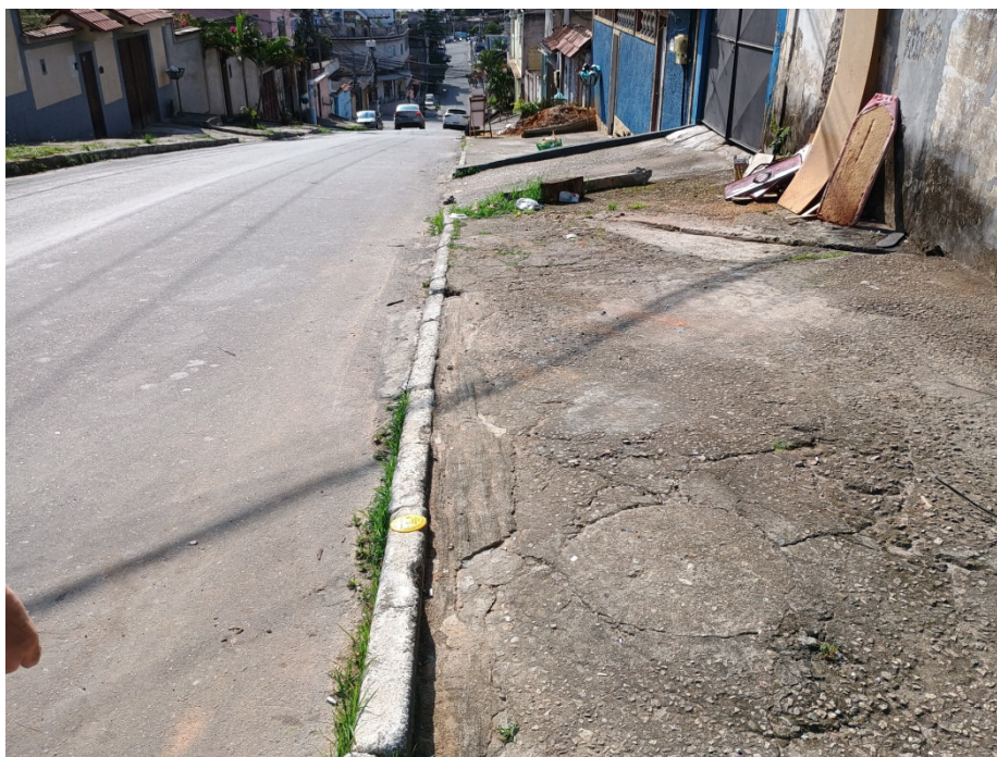
Foto 8: Marco plano fixado em local inapropriado.
