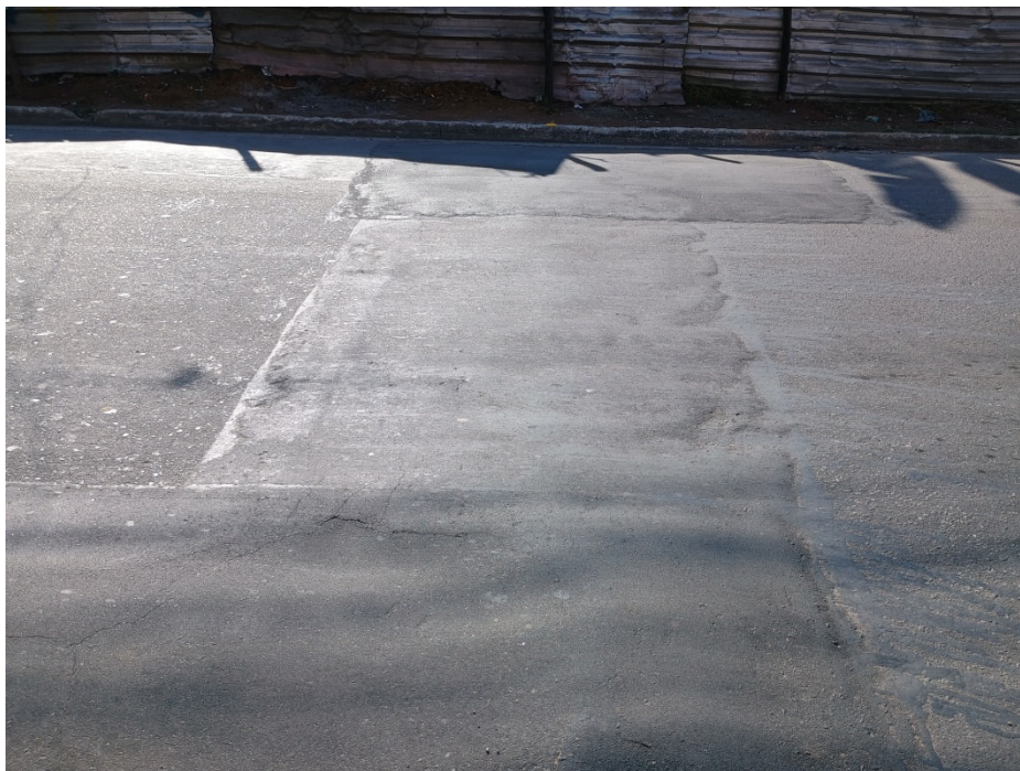
Foto 7: Trecho de recomposição inadequada.
