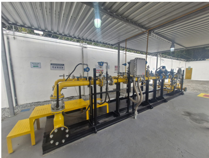
Foto 7: Estação de regulação e medição do gás (ERM).
