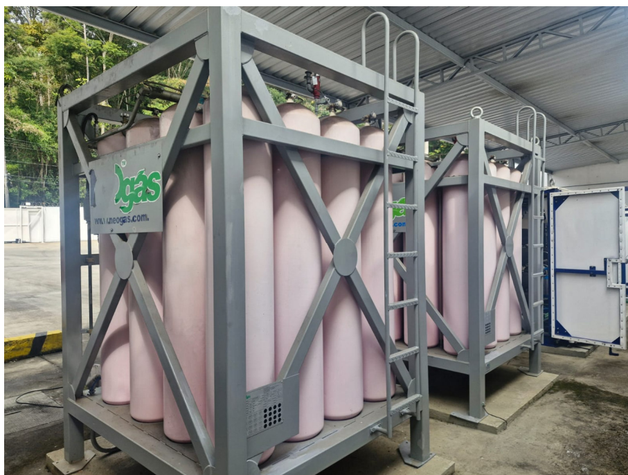
Foto 5: Sistema de estocagem do gás natural comprimido.
