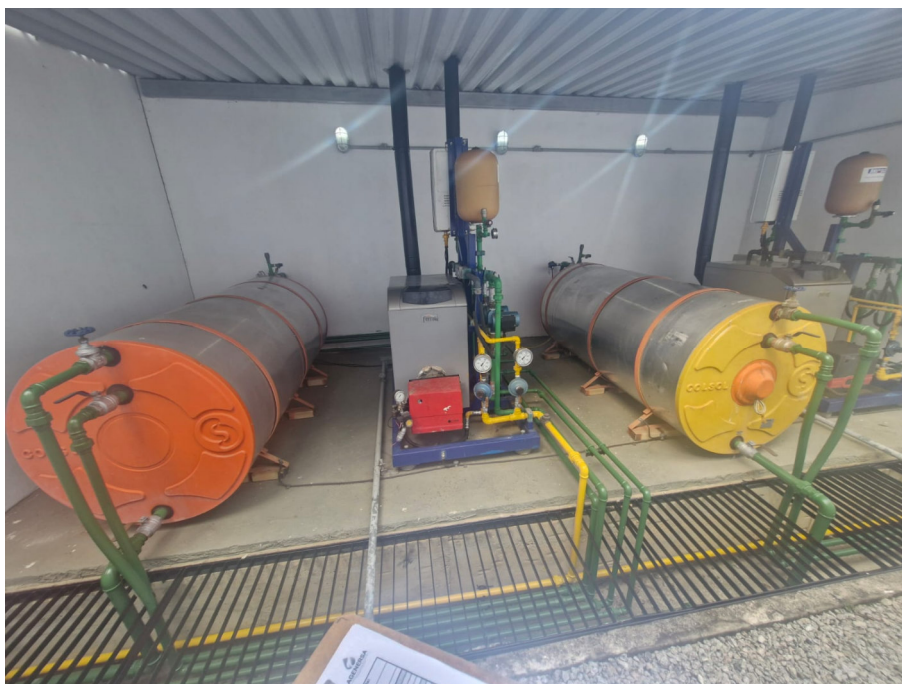
Foto 8: Aquecedores e tanque de estocagem de água.
