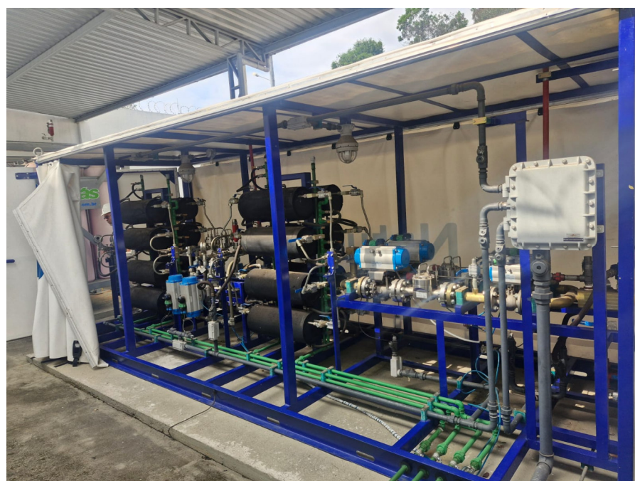
Foto 6: RCU – Unidade de redução e controle.
