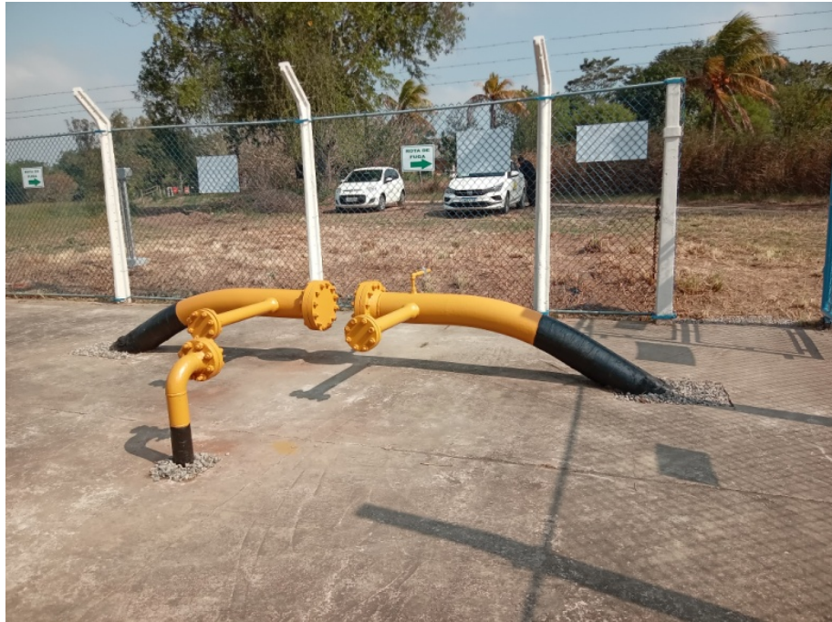
Foto 5: Rede de aço Ø8" desativada e sem válvula.
