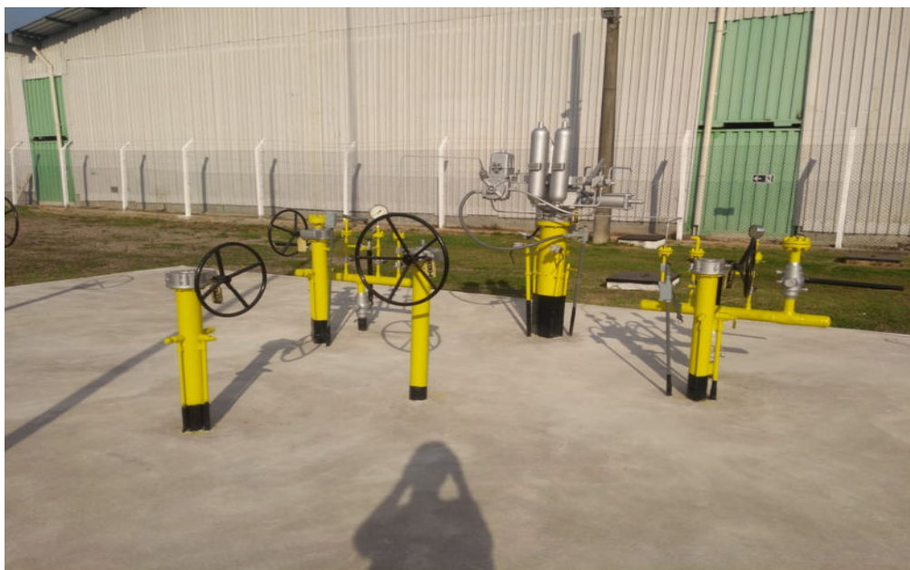
Foto 7: Sistema de válvula telecomandada para manobra de linha.
