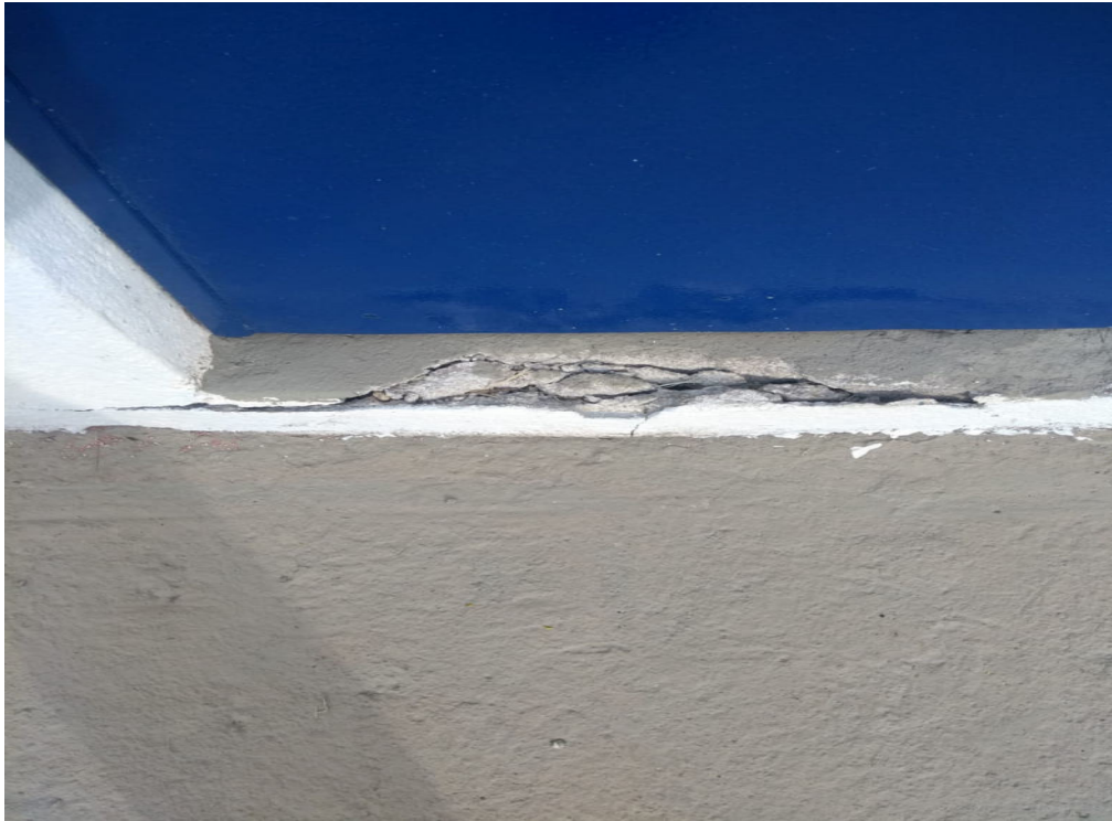
Foto 9: Ponto danificado na entrada da construção que está servindo como almoxarifado de peças.
