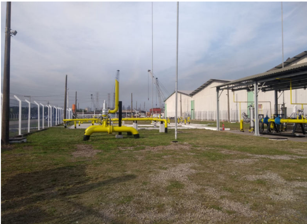
Foto 2: Estação de regulação e medição.
