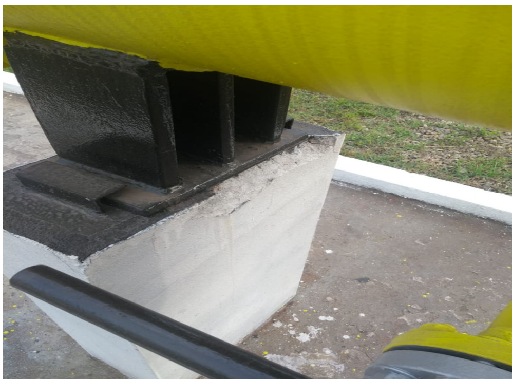
Foto 13: Ponto danificado no suporte que sustenta a tubulação.
