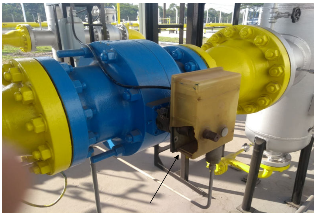
Foto 15: Caixa de acrílico, que protege componentes do regulador, danificada.
