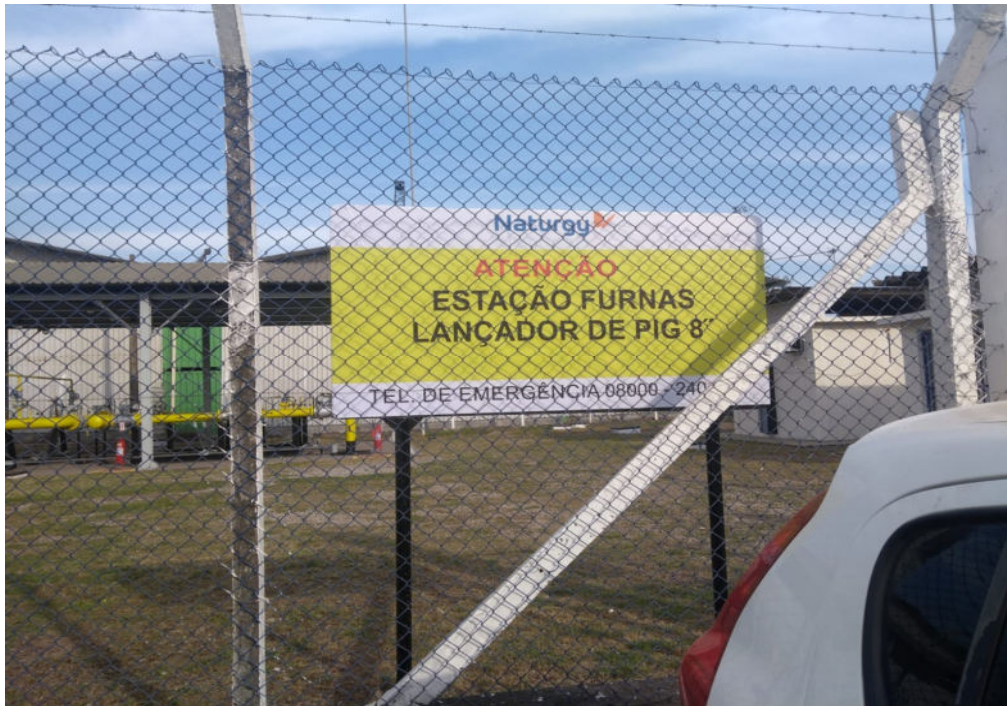
Foto 1: Estação de regulação e medição.
