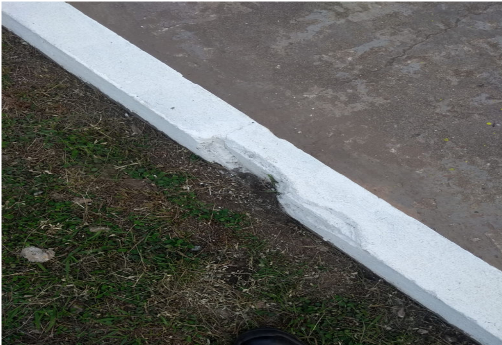
Foto 10: Ponto danificado no caminho cimentado.
