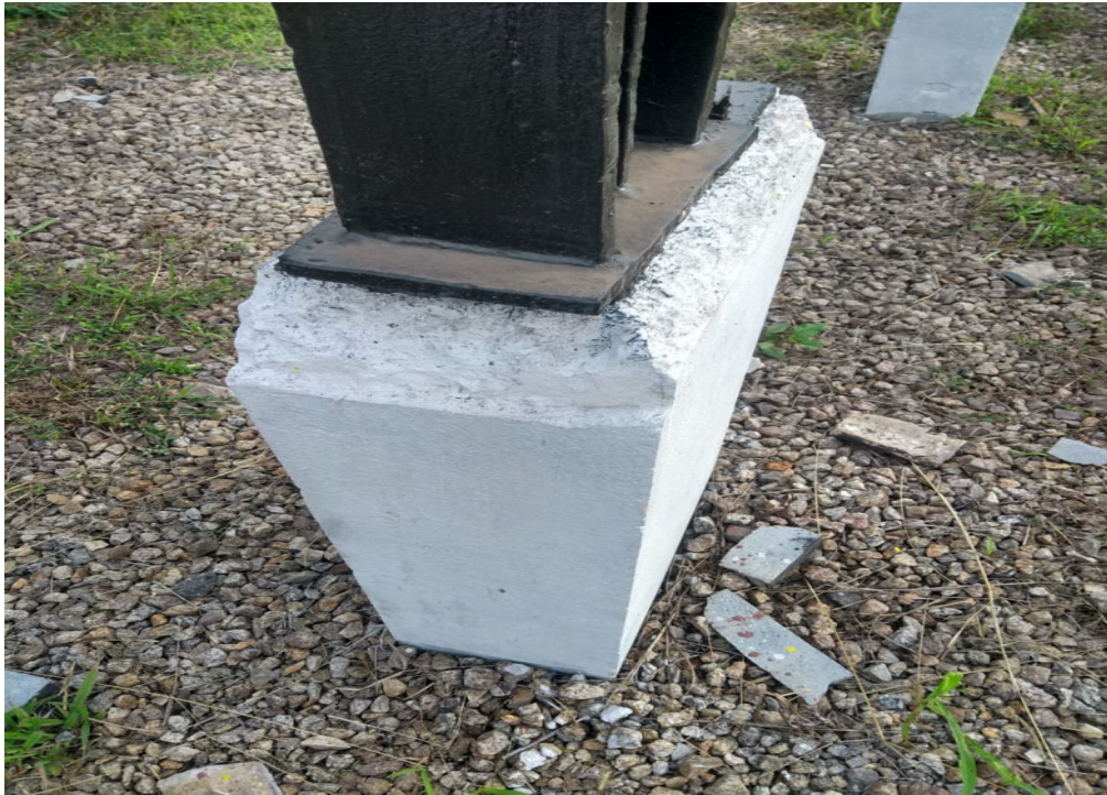
Foto 11: Ponto danificado no suporte que sustenta a tubulação.
