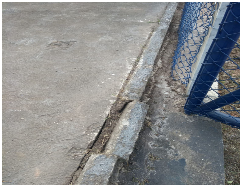
Foto 8: Ponto danificado em estrutura que acomoda válvula subterrânea.
