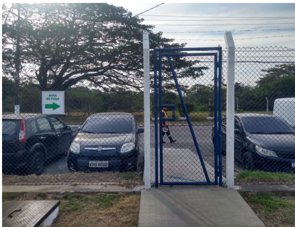
Foto 14: Ausência de placa de saída de emergência no portão.
