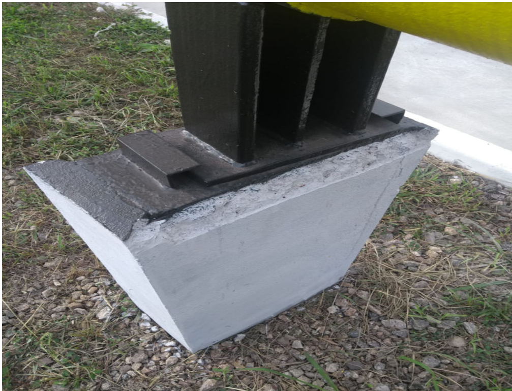
Foto 12: Ponto danificado no suporte que sustenta a tubulação.
