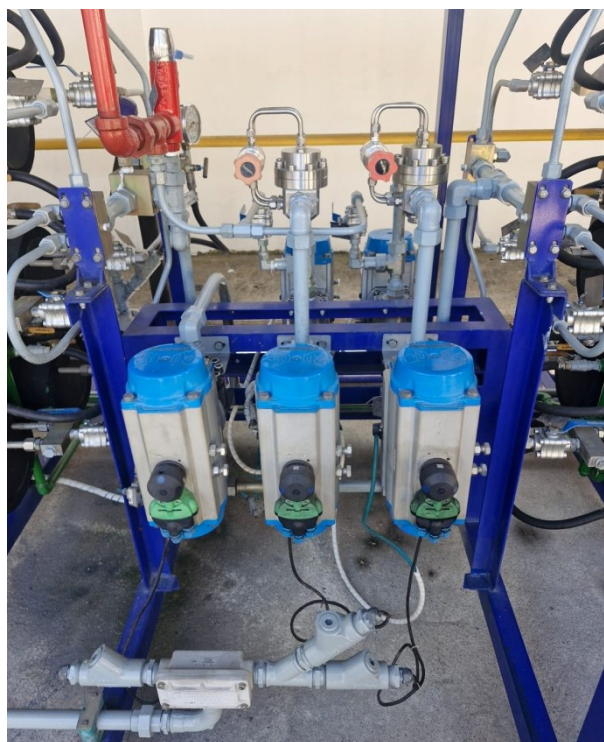
Foto 5: Sistema de Redução de Pressão.
