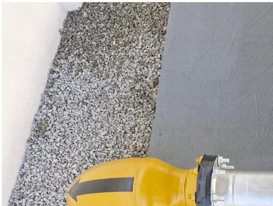
Foto 9: Linha de saída da Estação.
