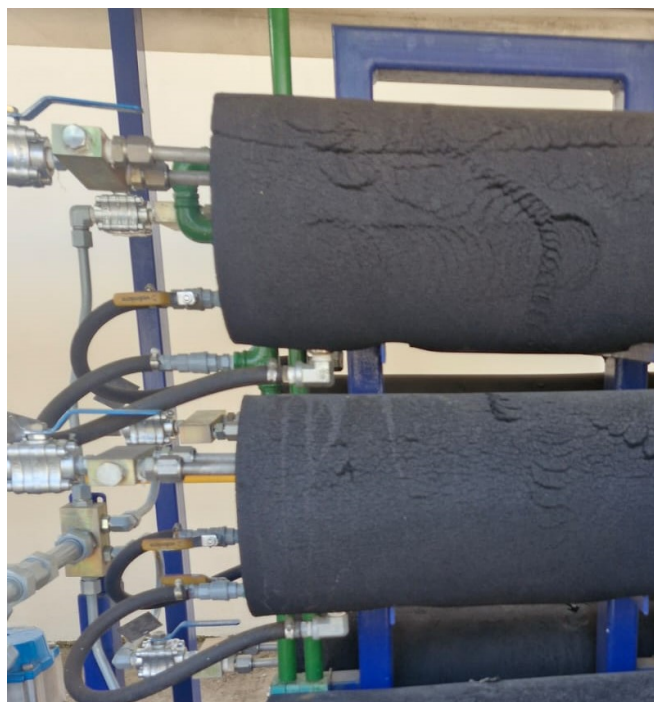
Foto 6: Sistema de troca de calor (Gás – Água).
