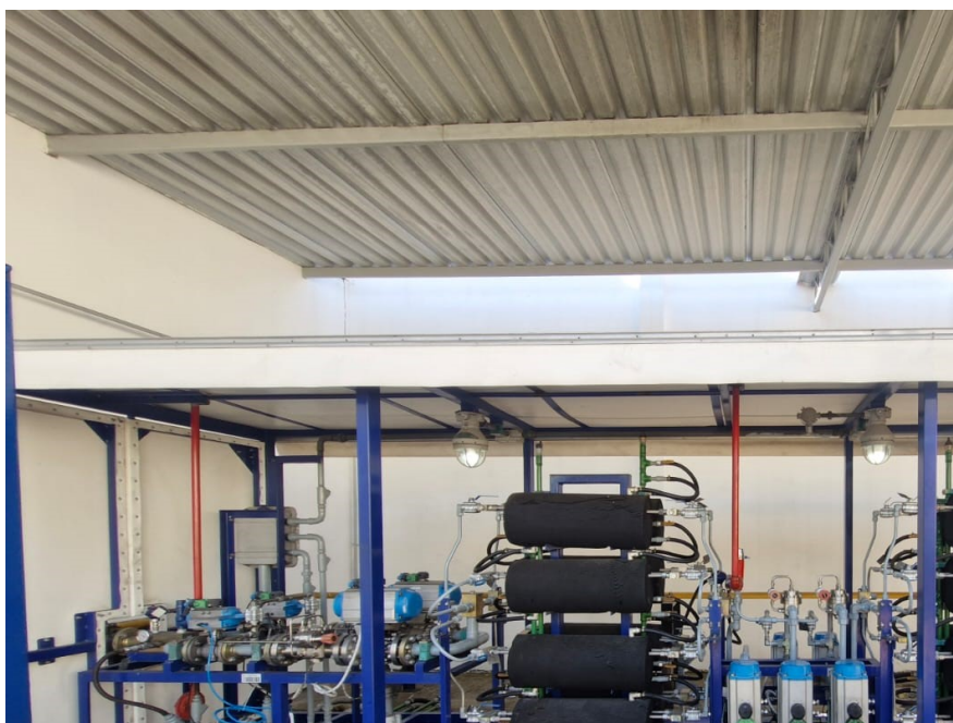
Foto 4: Unidade de redução e Controle de Pressão (RCU).
