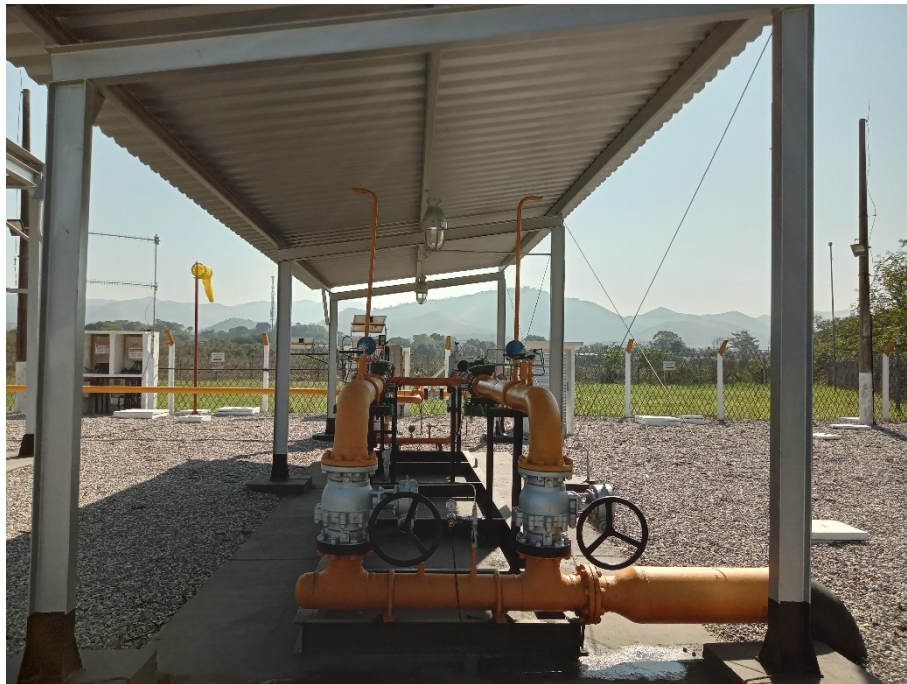
Foto 7: Linha de saída de gás para distribuição em média pressão.
