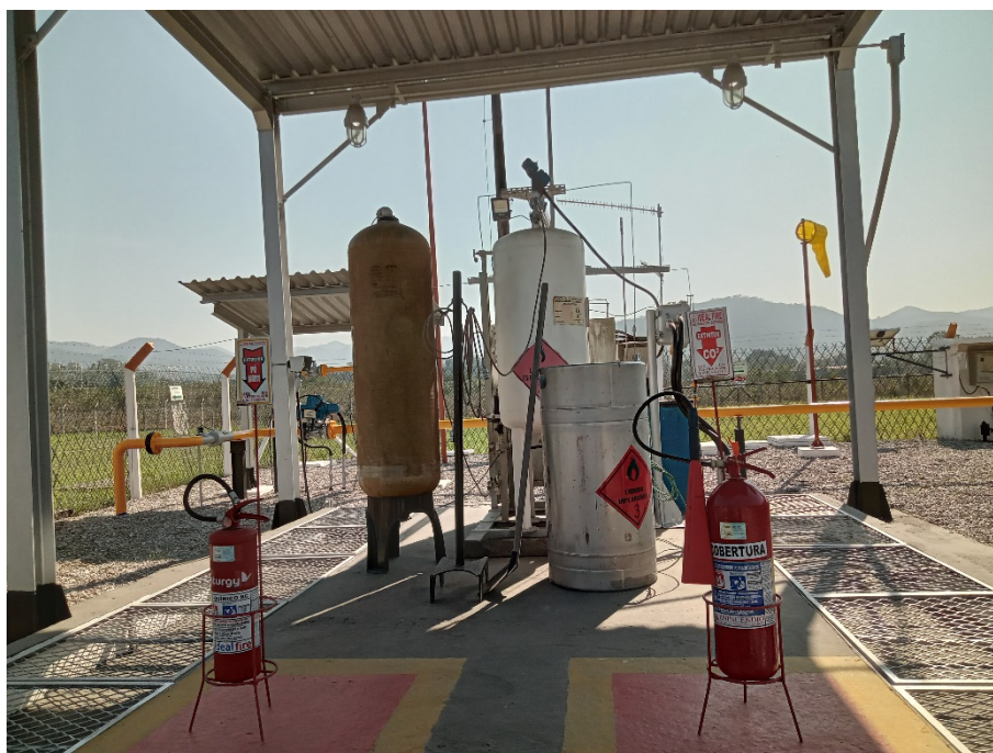
Foto 9: Estação de odorização.
