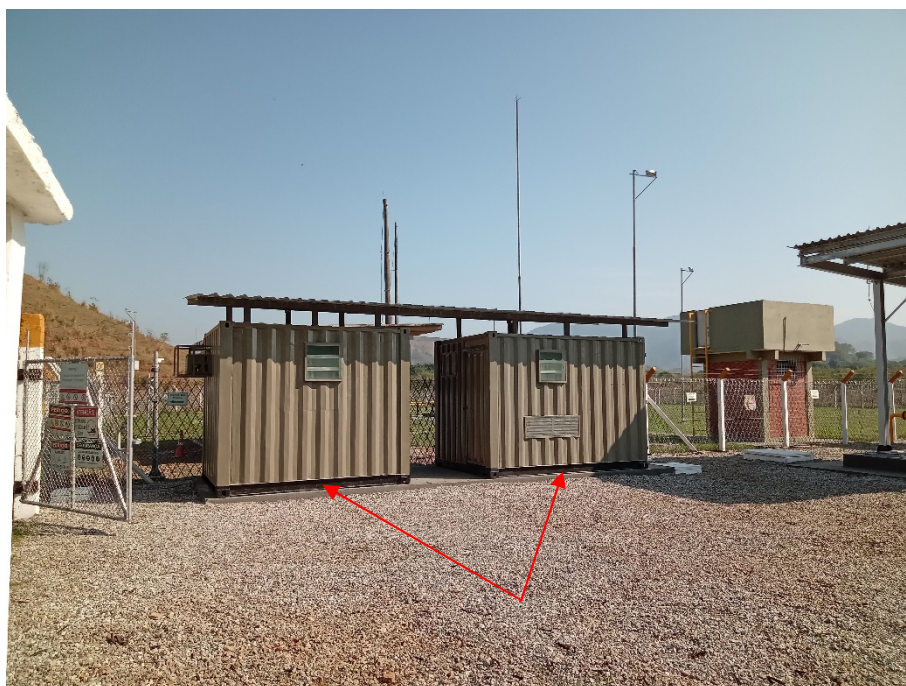
Foto 11: Sala de controle e sala de cromatografia.
