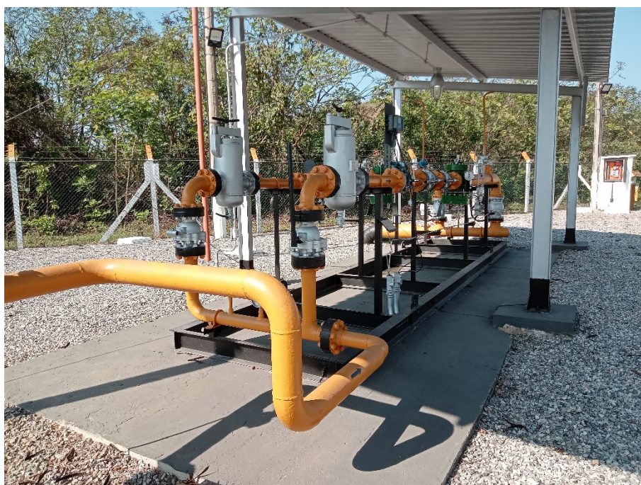
Foto 6: Estação de regulação e medição.
