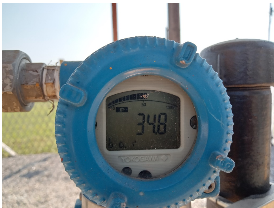
Foto 5: Indicação da pressão do gás na linha de entrada.
