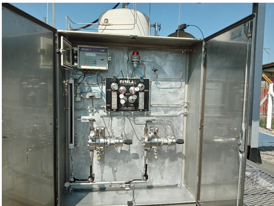
Foto 10: Equipamento de odorização (controlador, dispositivos de manobra e bombas).
