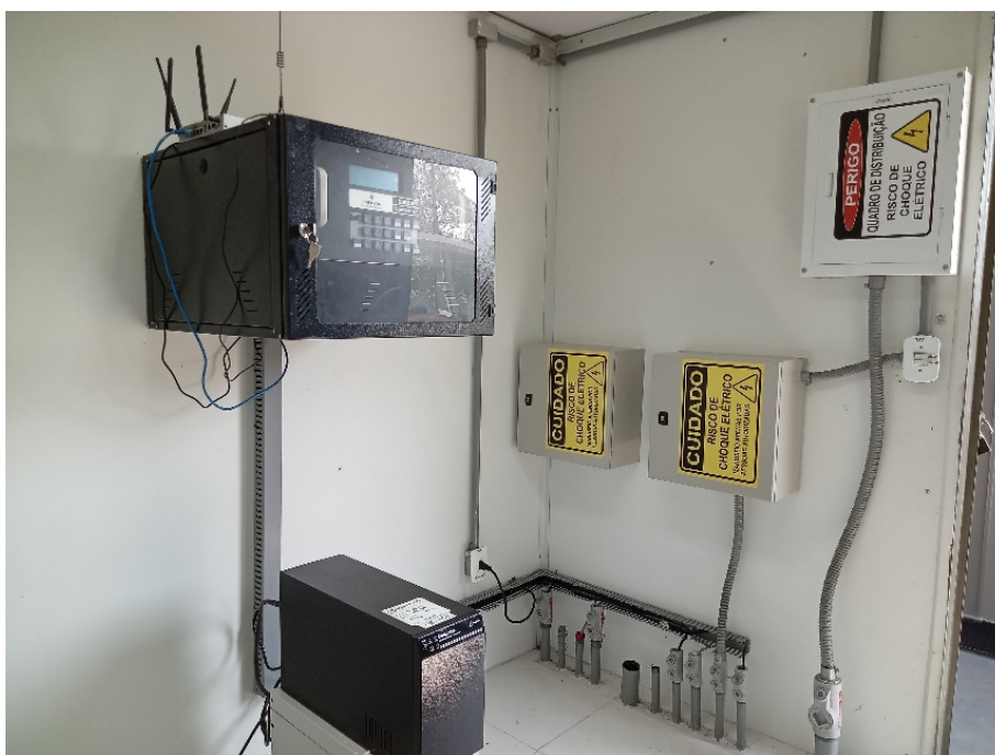
Foto 12: Equipamentos elétricos e de telemetria no interior da sala de controle.
