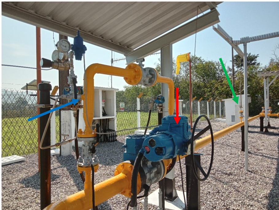
Foto 4: Válvula telecomandada na linha de entrada de gás (seta vermelha); ponto de derivação no bypass que segue para a estação de odorização (seta azul); ponto de injeção do odorante (seta verde).
