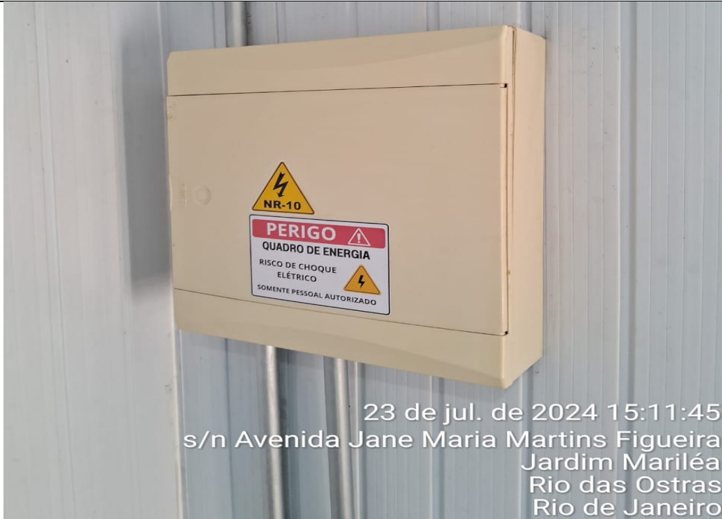
Foto 12: Quadro de energia com sinalização corrigida, foto enviada pelo responsável da Estação.
