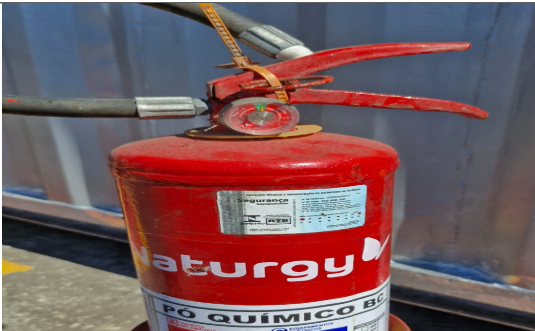
Foto 5: Extintor lacrado na Estação. Haviam 4, conforme Laudo.
