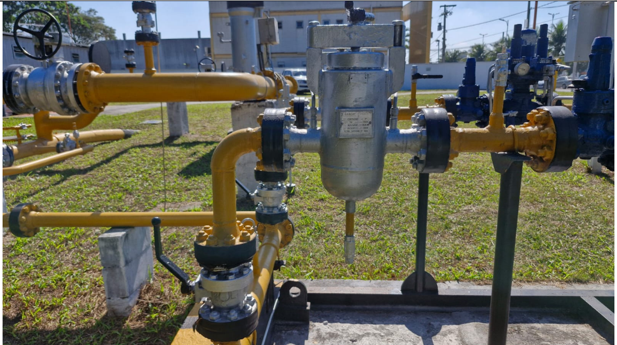
Foto 8: Filtro no sentido de abastecimento de Rio das Ostras.
