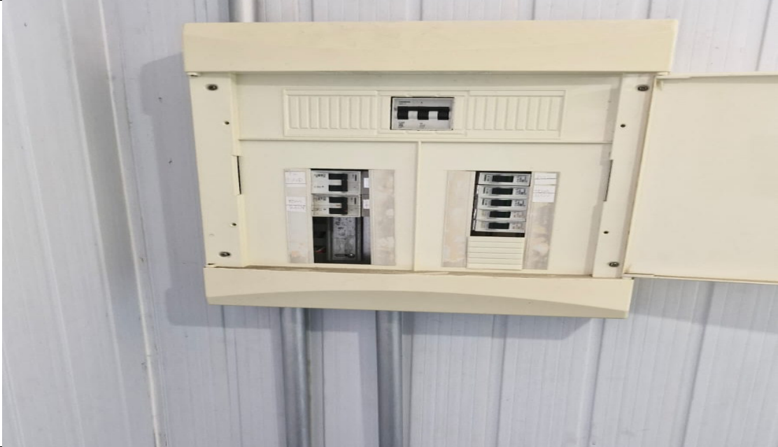
Foto 4: Quadro de energia elétrica. Não havia sinalização de risco de choque.
