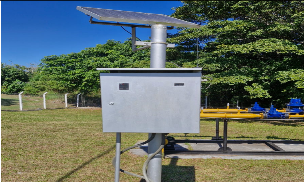
Foto 11: Placa solar alimentando ponto de telemetria.
