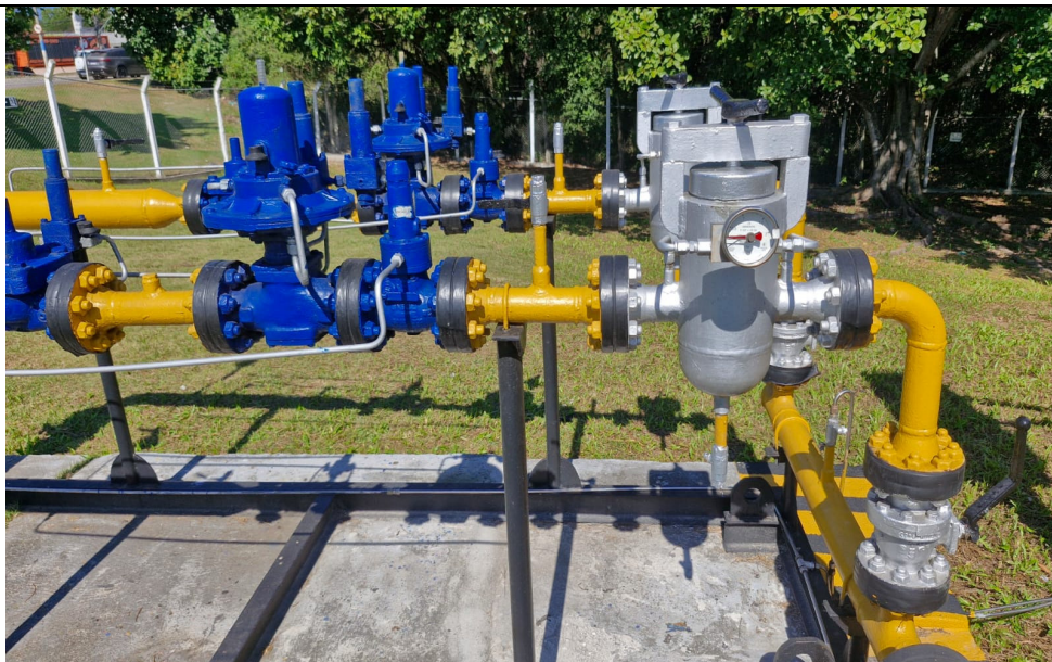
Foto 7: Regulagem e medição no sentido de abastecimento de Rio das Ostras.
