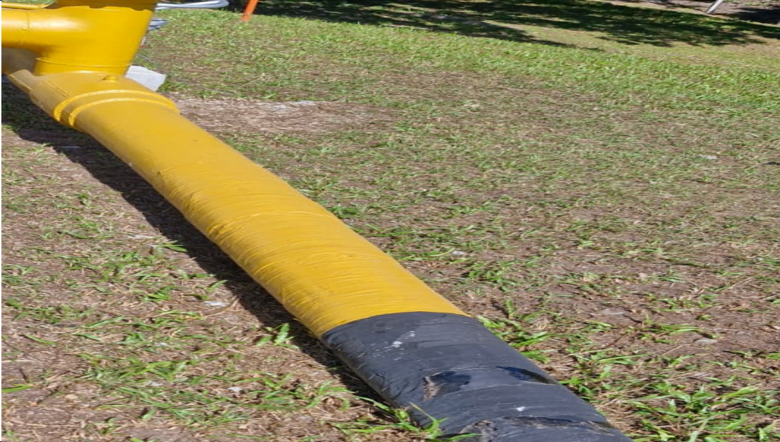
Foto 6: Duto de entrada da Estação.
