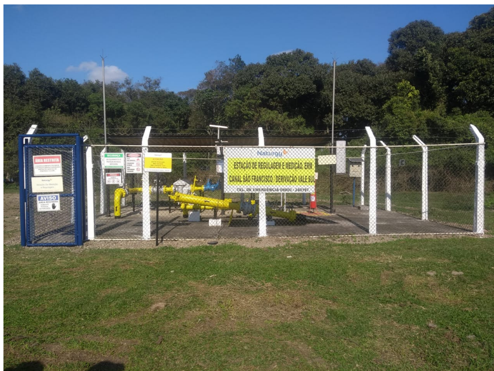
Foto 1: Estação de regulação e medição.
