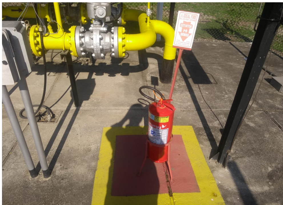
Foto 8: Extintor tipo Pó Químico.
