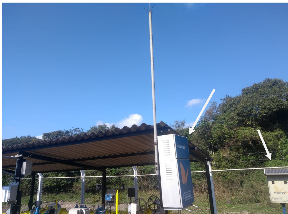
Foto 6: Para-raio e sistema de telemetria.
