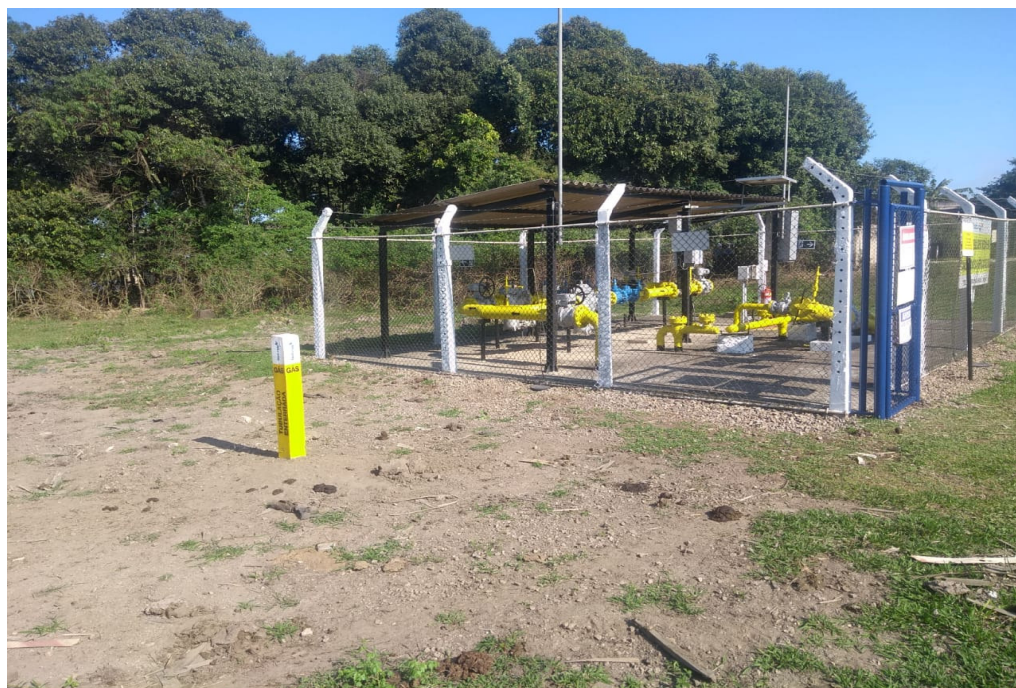
Foto 2: Estação de regulação e medição.
