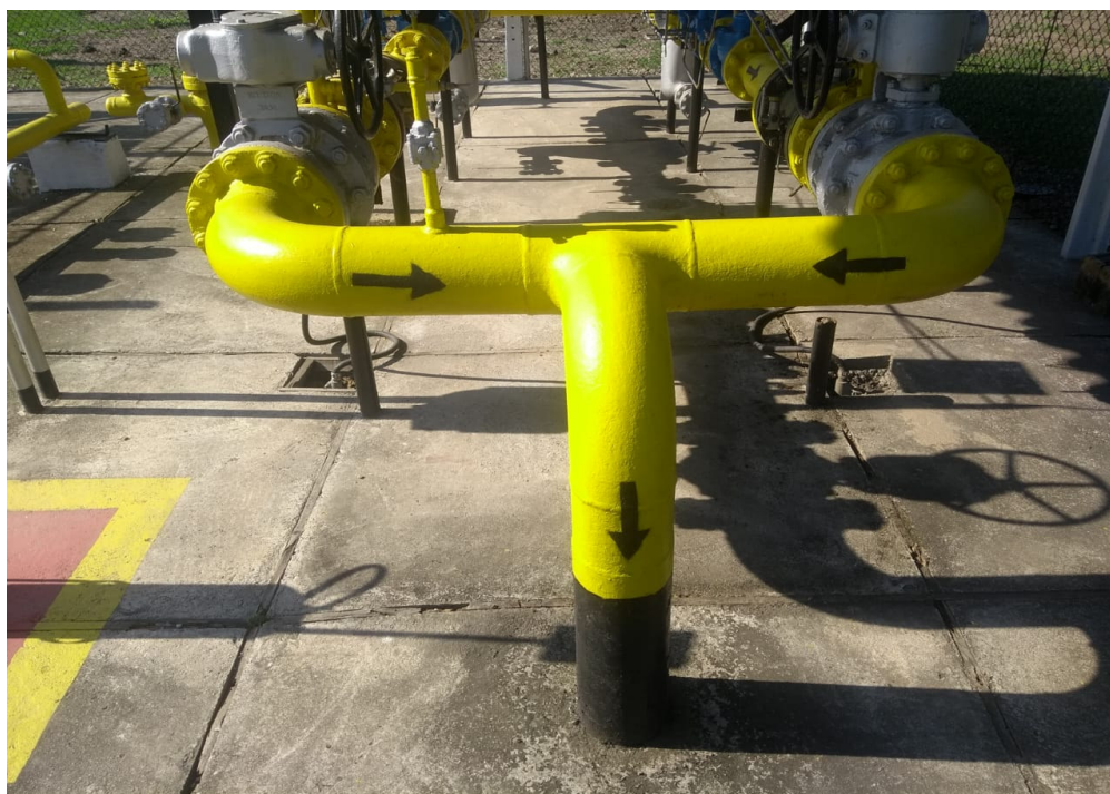
Foto 4: tubulação de saída destinada à Estação Aterro Leme.
