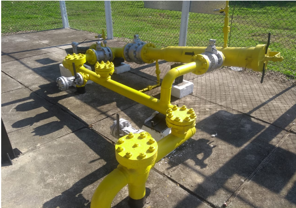
Foto 9: Tubulação para lançamento de Pig.
