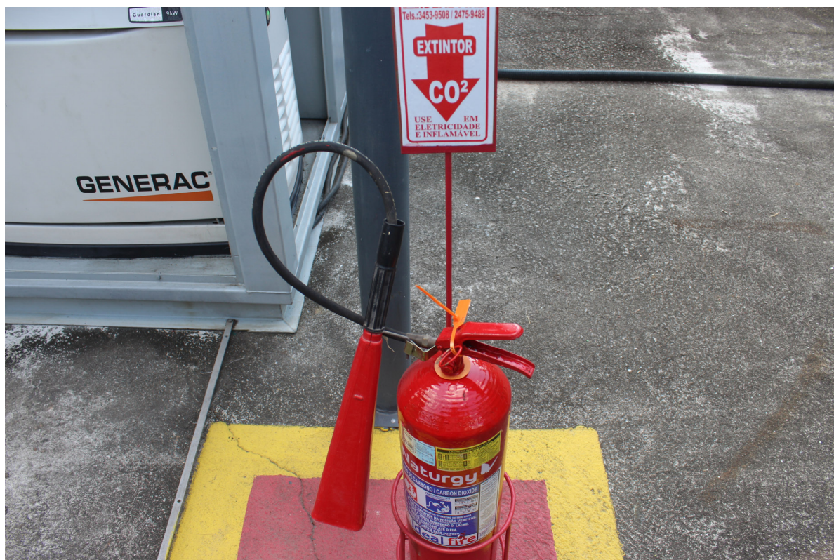
Foto 8: Extintor de incêndio e CO 2 da estação.
