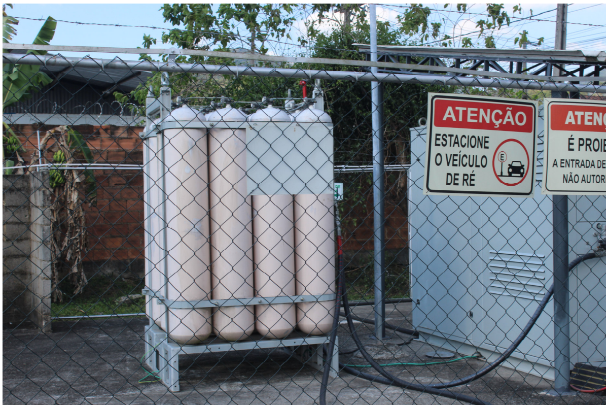
Foto 4: Cilindro de GNC que abastecem a estação.
