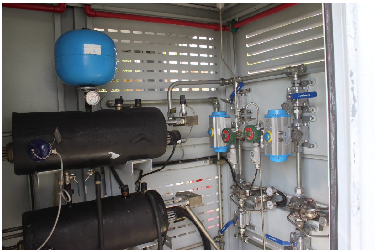
Foto 5: Trocador de calor da estação para abaixar a pressão.
