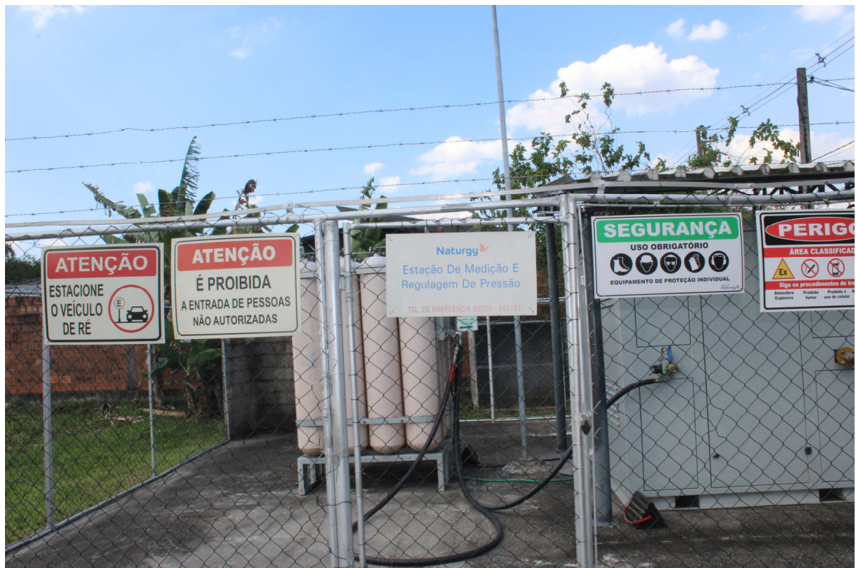
Foto 1: Identificação da estação com as placas de segurança.
