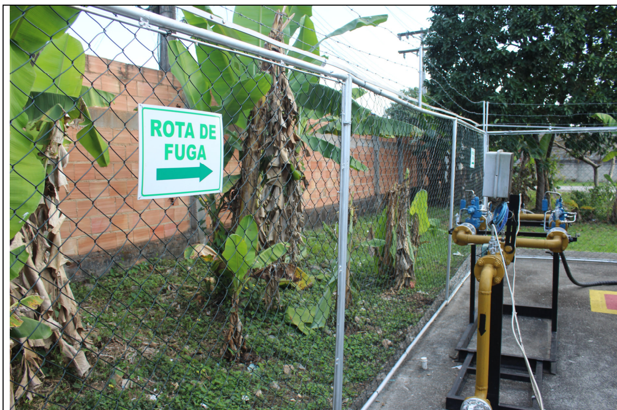
Foto 10: Placa de rota de fuga da estação.
