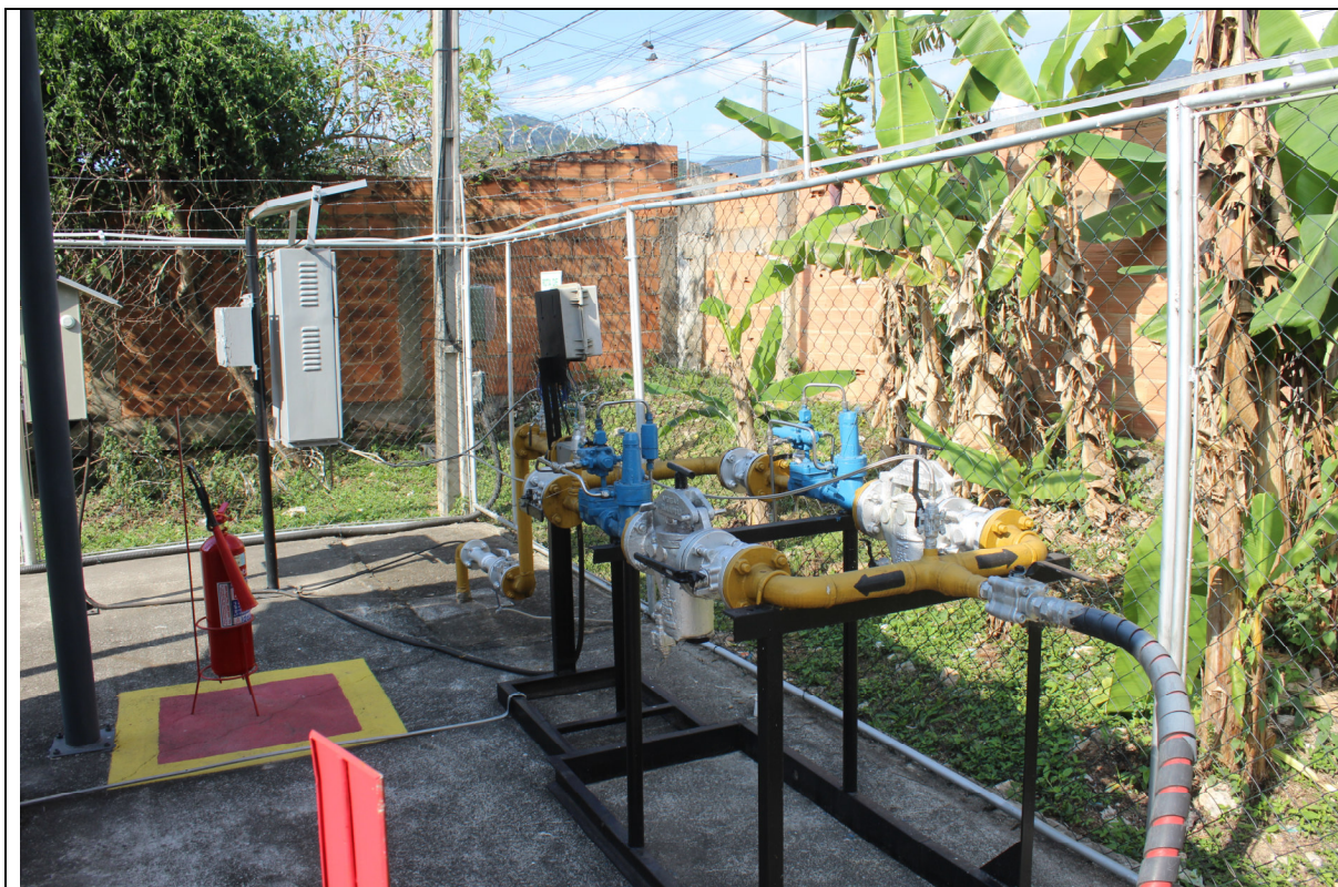
Foto 6: Estação de regulação e medição de pressão da Naturgy.
