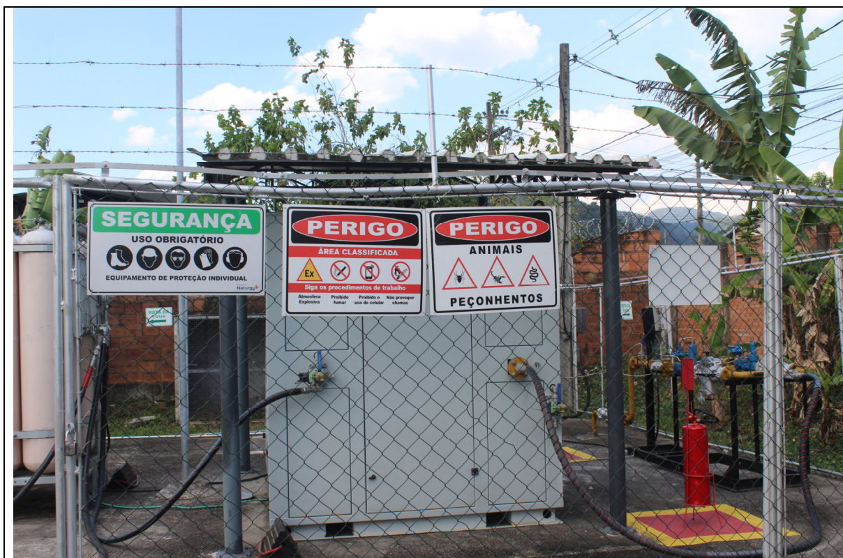
Foto 2: Placas de identificação de segurança.
