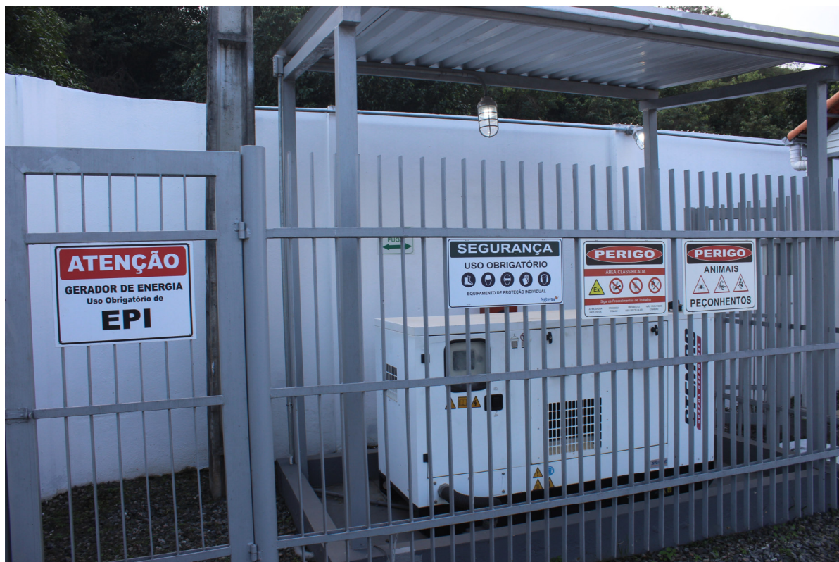
Foto 5: Gerador de Energia da estação.
