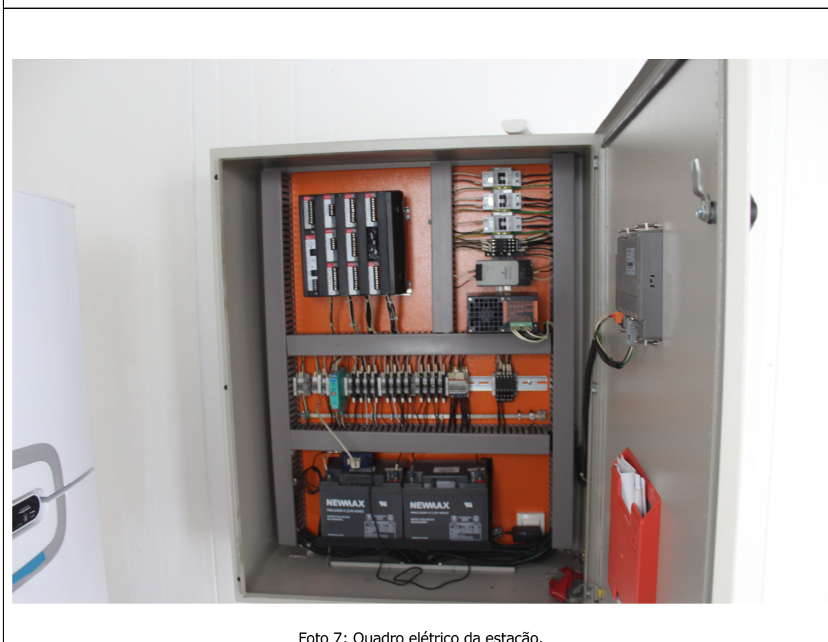
Foto 7: Quadro elétrico da estação.
