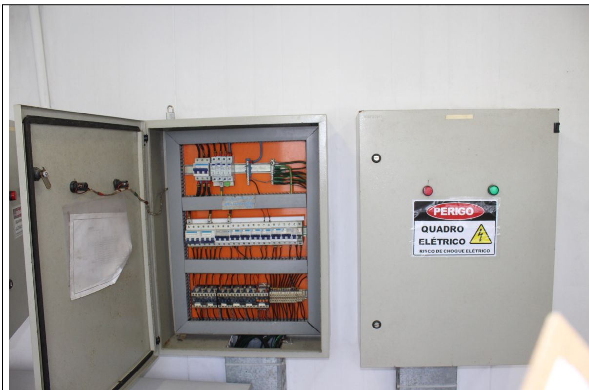
Foto 6: Quadro elétrico da estação.
