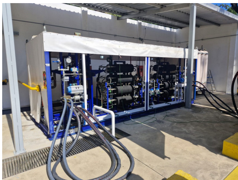
Foto 6: RCU - Unidade de redução e controle.
