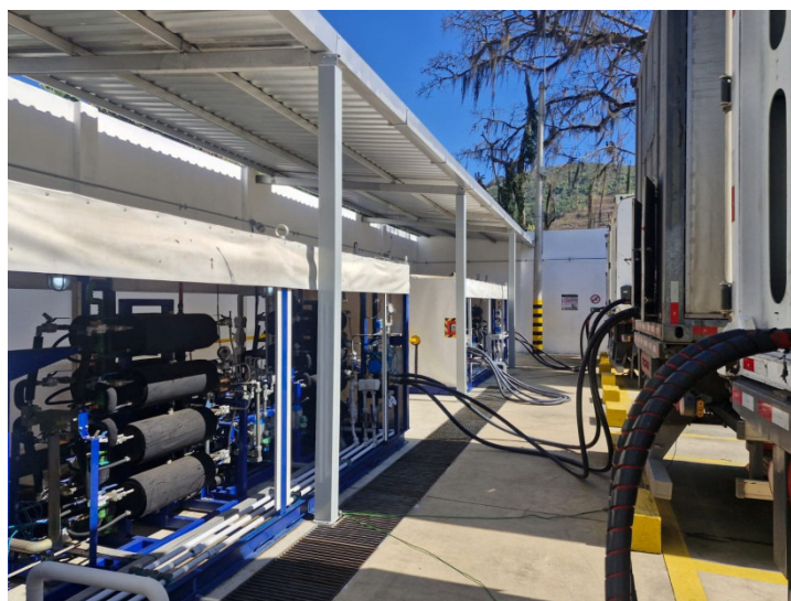
Foto 4: Carreta conectada à RCU.
