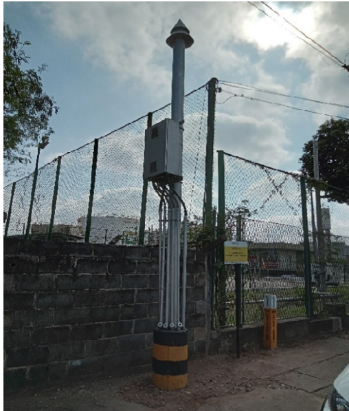
Foto 5: Sistema de telemetria que ainda não está em operação.
