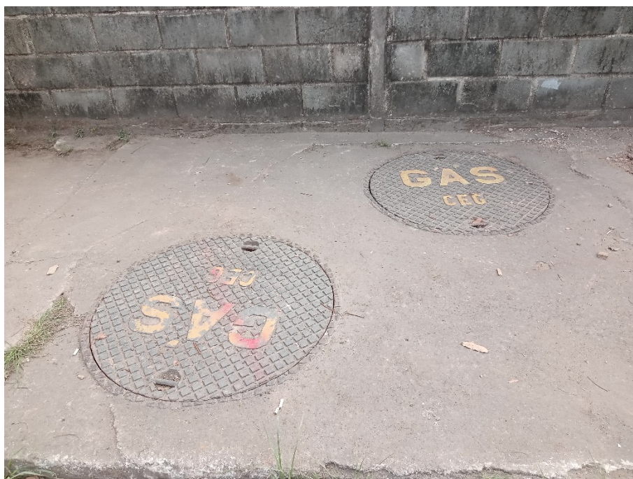
Foto 4: Caixa de válvulas subterrâneas.
