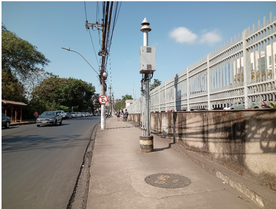
Foto 11: Caixa de válvula telecomandada e sistema de telemetria.
