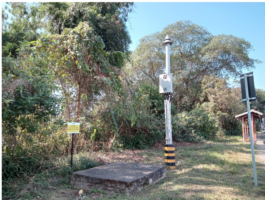
Foto 10: Caixa de válvula telecomandada e sistema de telemetria.
