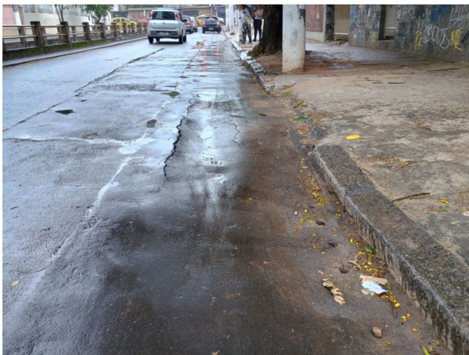
Foto 5: recomposição com rachadura.
