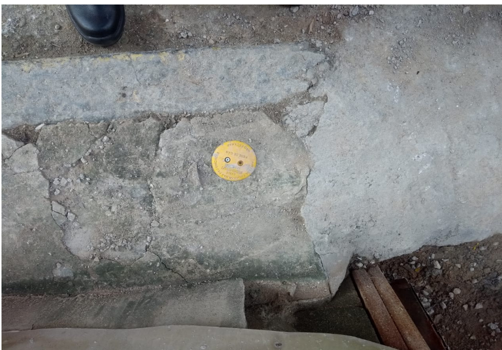
Foto 8: Marco plano sem a devida fixação.
