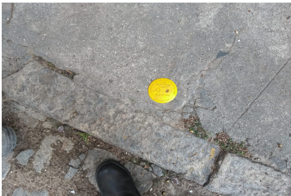
Foto 10: Marco plano sem a devida fixação.
