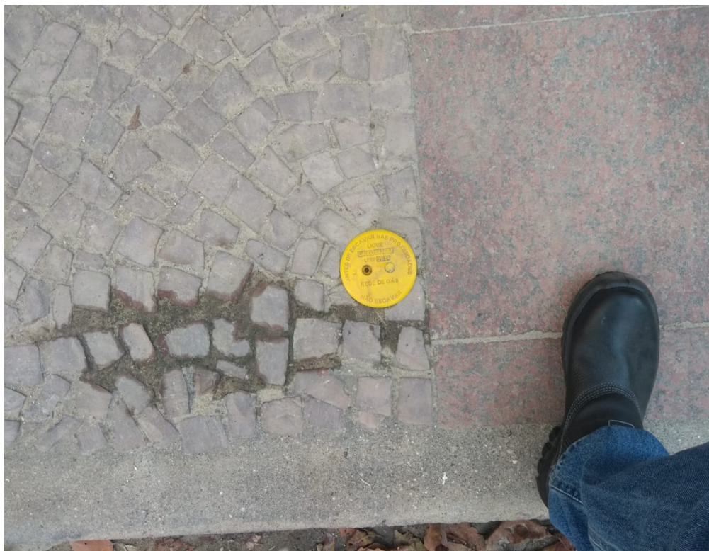
Foto 9: Marco plano sem a devida fixação.
