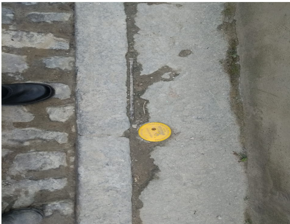
Foto 7: Marco plano sem a devida fixação.
