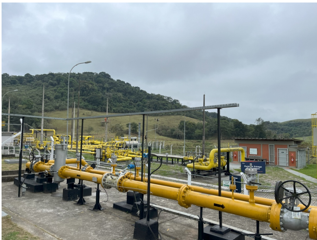
Foto 3: Estação de medição à frente e ponto de entrega da NTS atrás.
