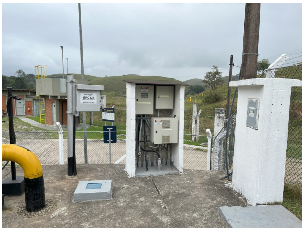
Foto 4: Retificador e painel elétrico.
