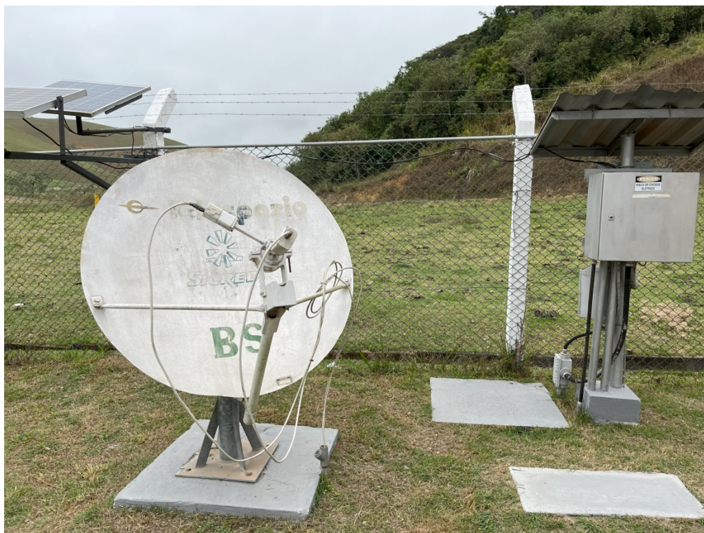
Foto 9: Painel fotovoltaico, antena de internet e caixa de telemetria.
