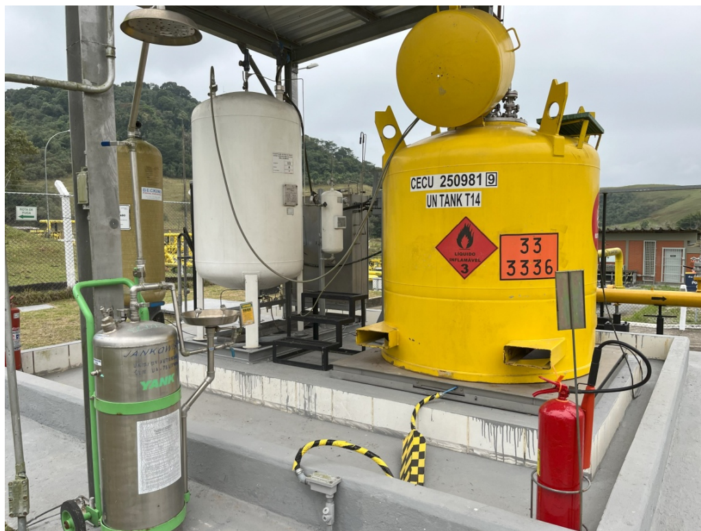
Foto 5: Estação de odorização.
