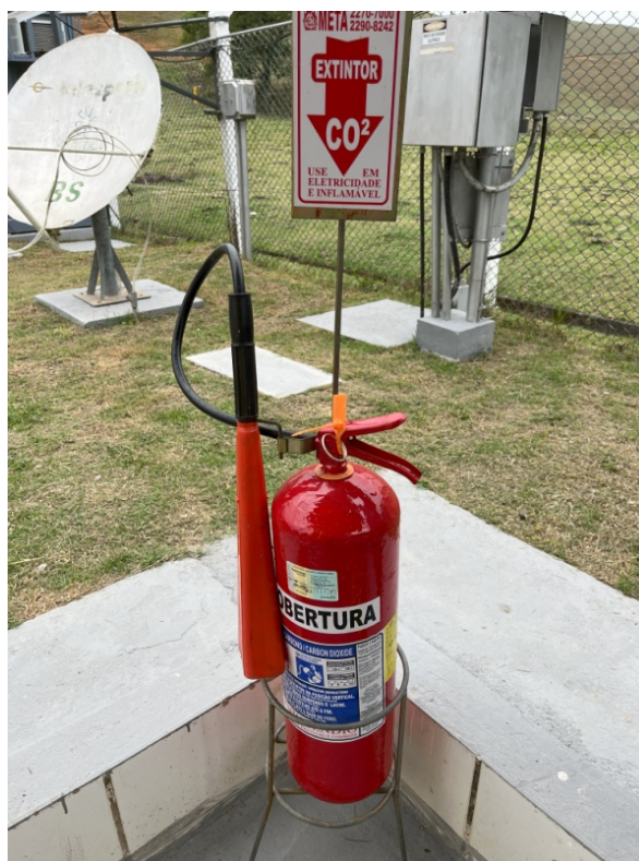
Foto 7: Extintor de CO 2 .
