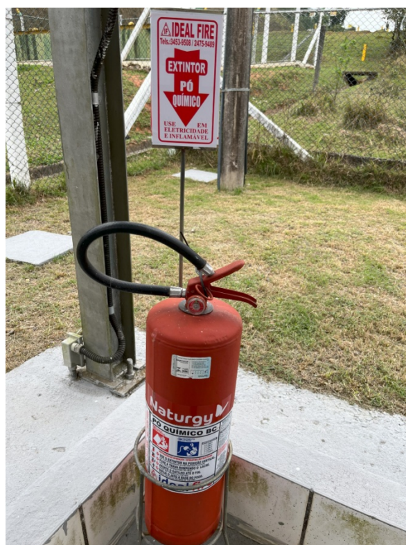
Foto 8: Extintor de pó químico.
