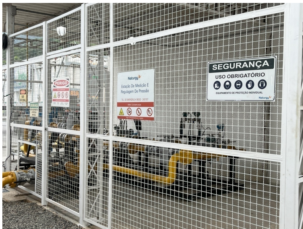
Foto 6: Estação de Medição e Regulagem de Pressão.
