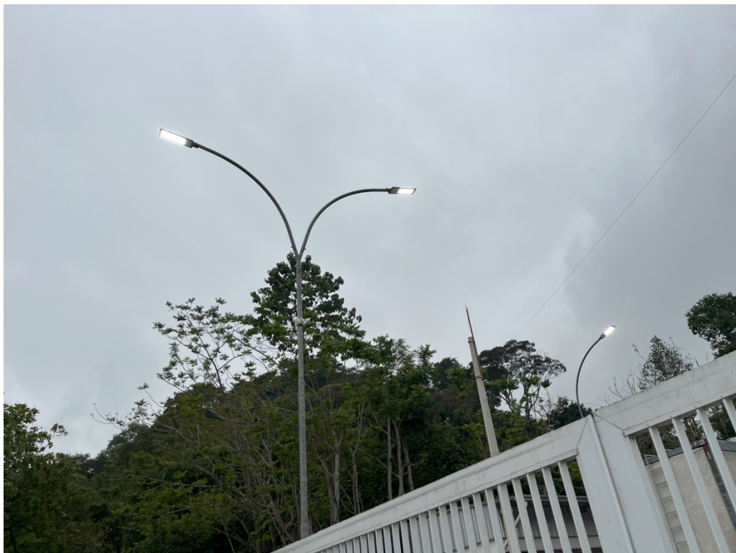
Foto 10: Iluminação em LED da estação.
