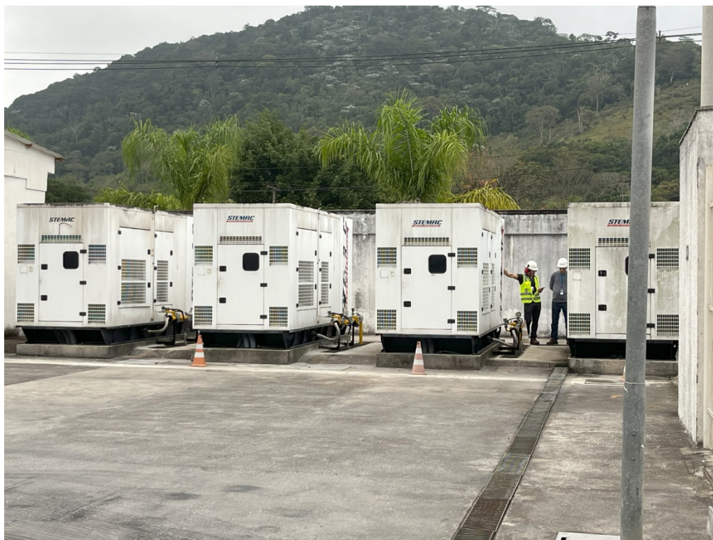
Foto 5: Geradores a gás da estação, incluindo o novo gerador à direita.
