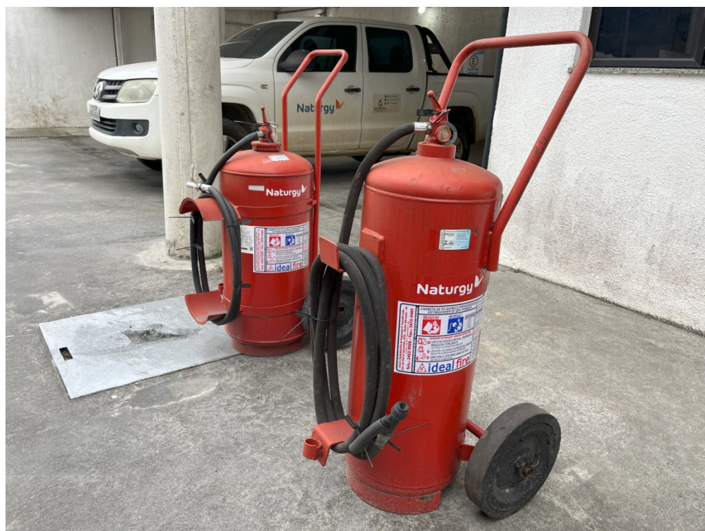
Foto 8: Extintores de incêndio.
