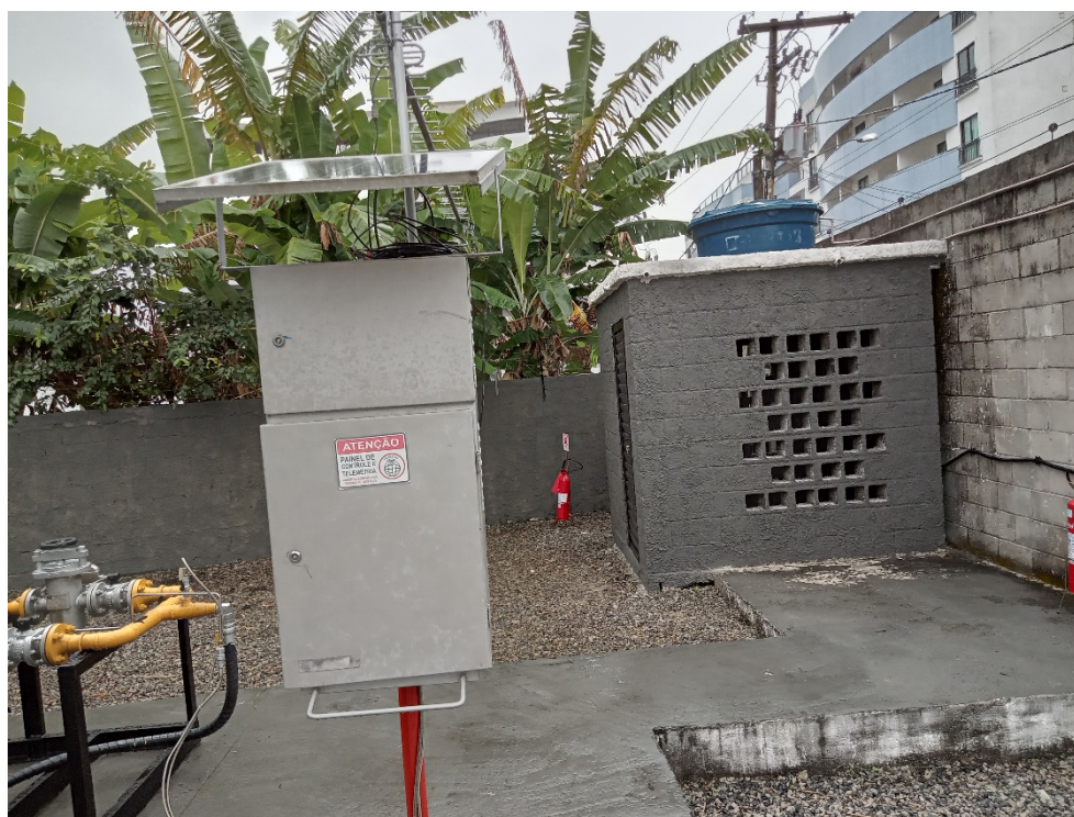
Foto 8: Painel do sistema de telemetria e placa fotovoltaica da ERM.
