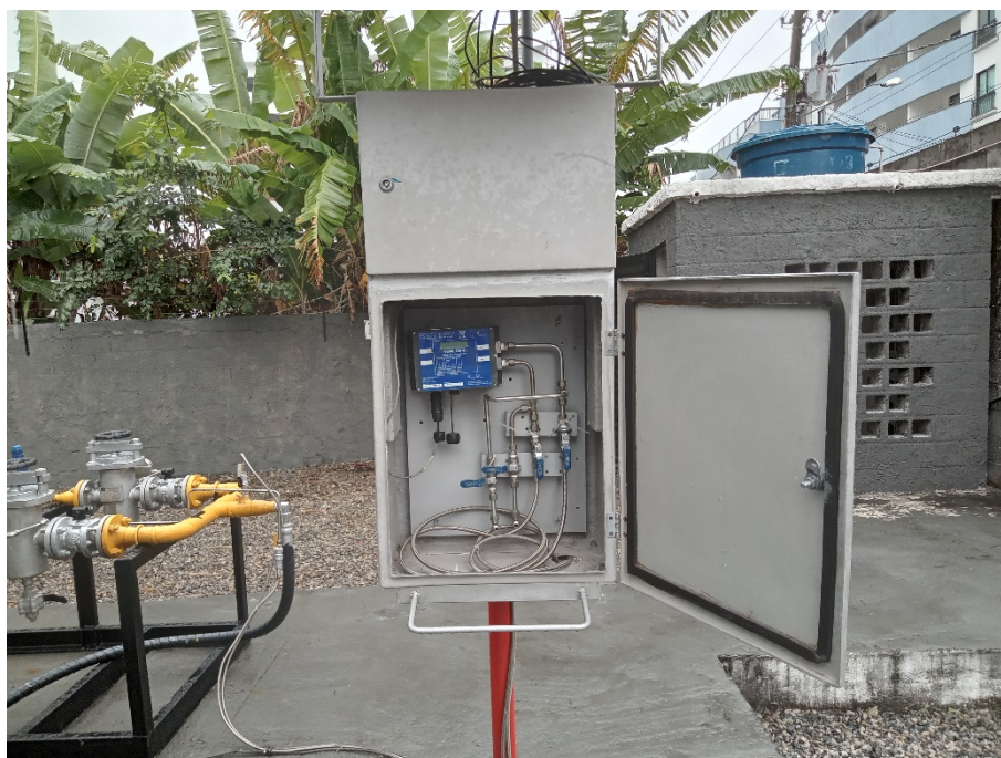
Foto 10: Sistema de monitoramento da pressão de entrada e saída da ERM.
