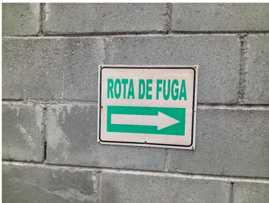
Foto 9: Placa de indicação da saída em caso de emergência.
