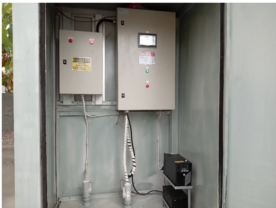
Foto 12: Painel do sistema de telemetria e Nobreak da RCU.
