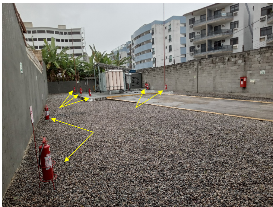
Foto 13: Extintores de incêndio sem proteção contra intempéries.
