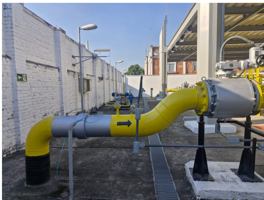
Foto 2: Linha de Entrada do gás na Estação.
