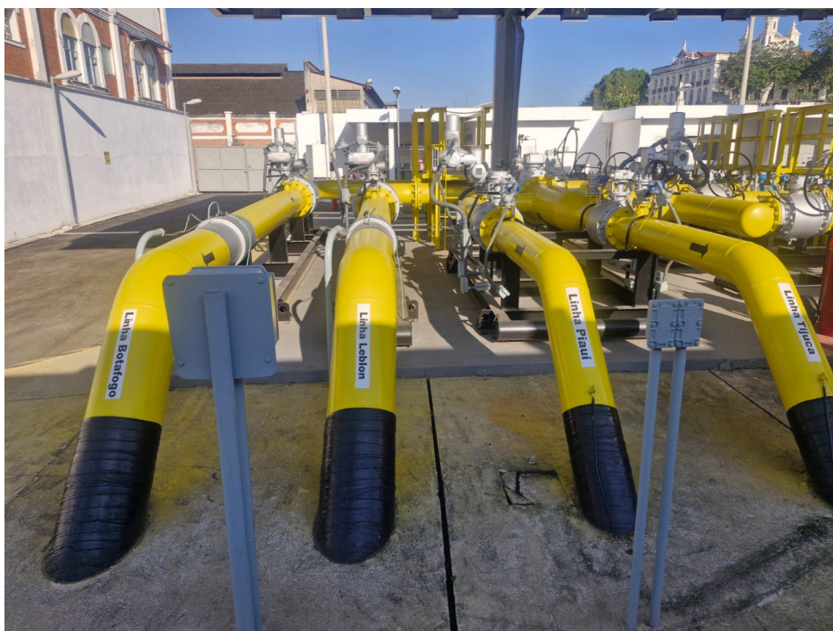
Foto 6: Linhas de distribuição do gás.
