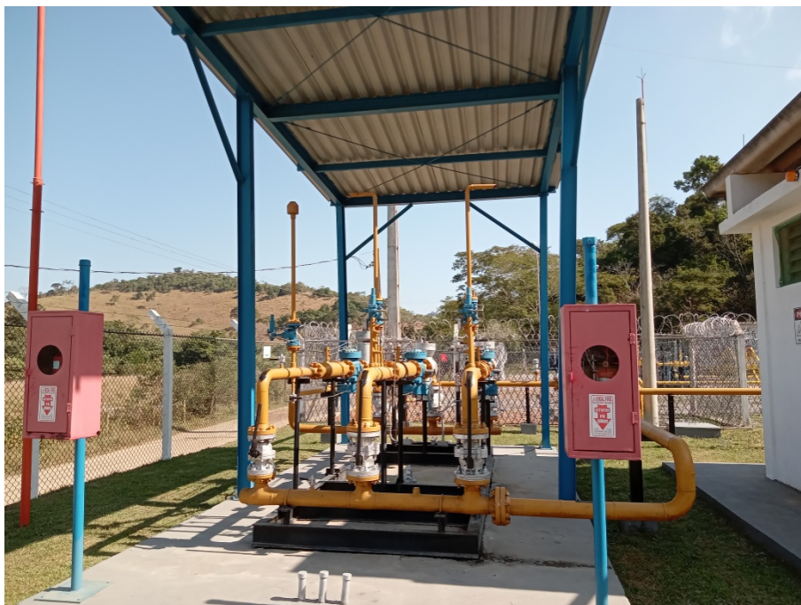
Foto 4: Estação de 1º corte que reduz a pressão de 50/25 bar.
