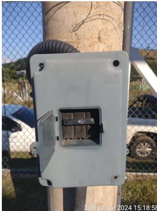
Foto 19: Adequação das condições de instalação de disjuntor de proteção geral.
