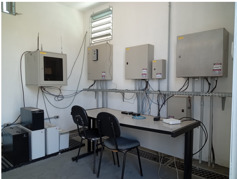
Foto 15: Painéis de telemetria e elétrico.
