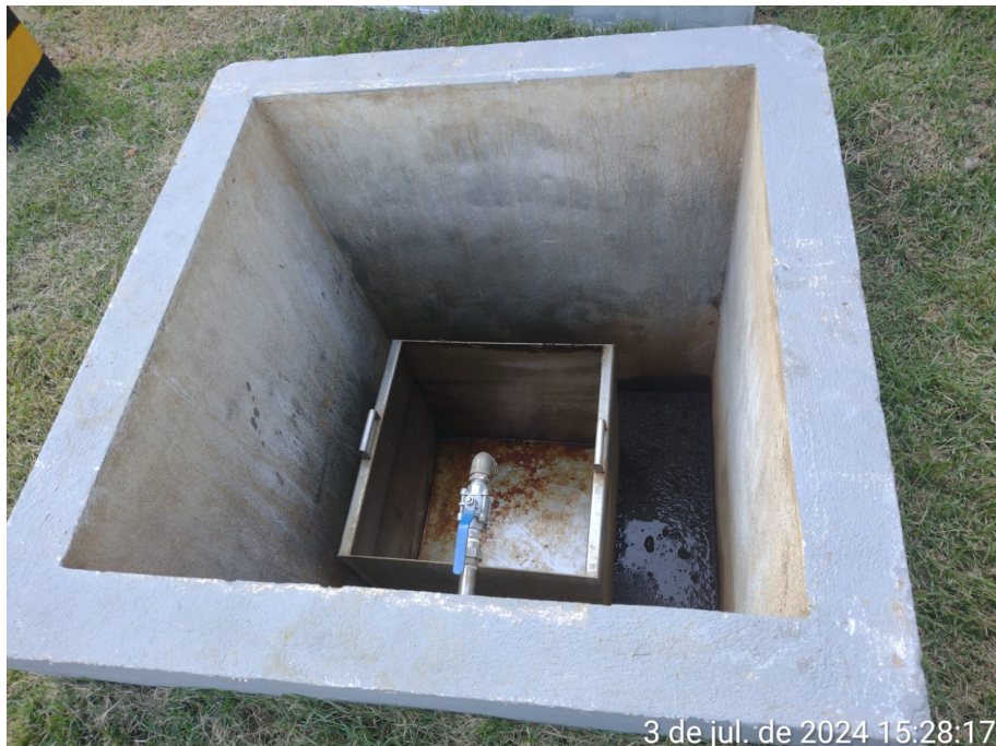
Foto 20: Drenagem de caixa destinada à contenção de mercaptana.
