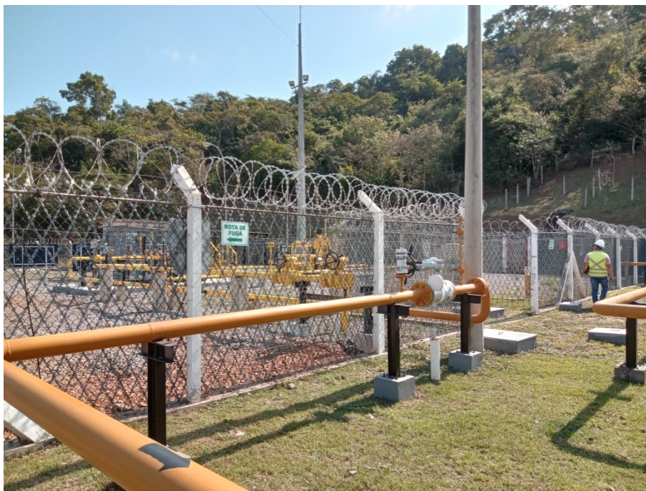
Foto 3: Linha de entrada de gás do Ponto de entrega NTS em área contígua à ETC Rio das Flores.
