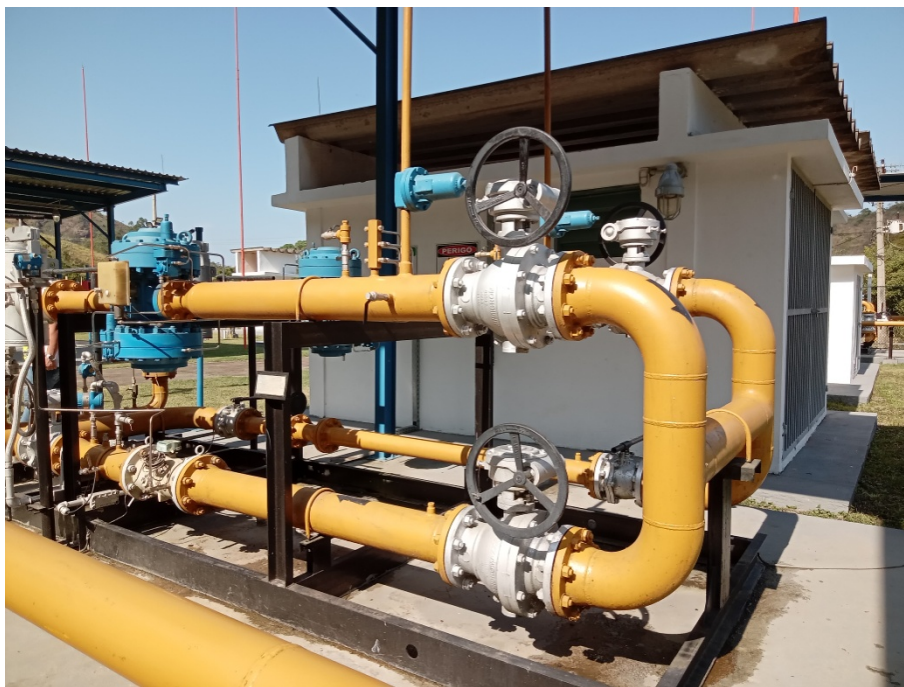
Foto 7: Estação de 2º corte que reduz a pressão de 25/16 bar.
