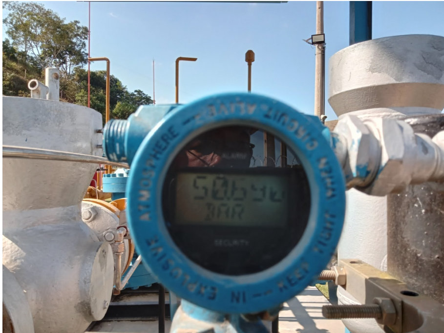
Foto 5: Indicação da pressão de entrada.
