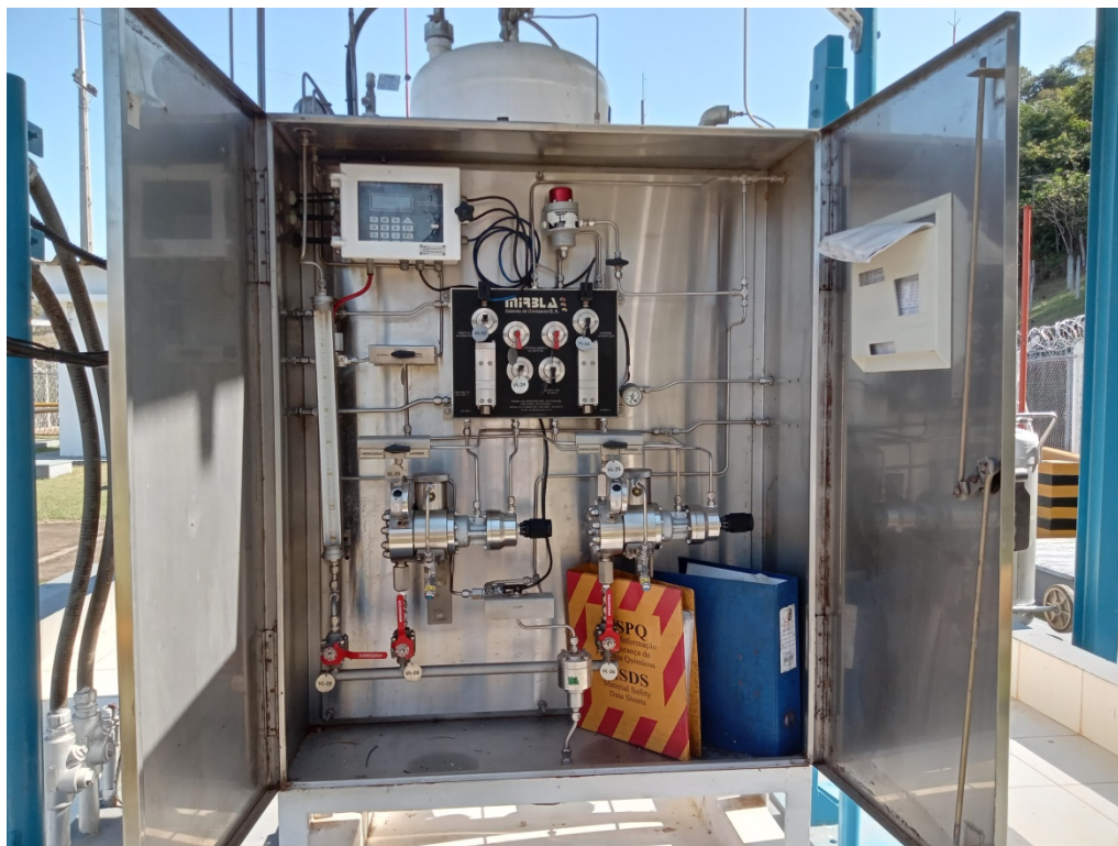
Foto 12: Equipamento de odorização.
