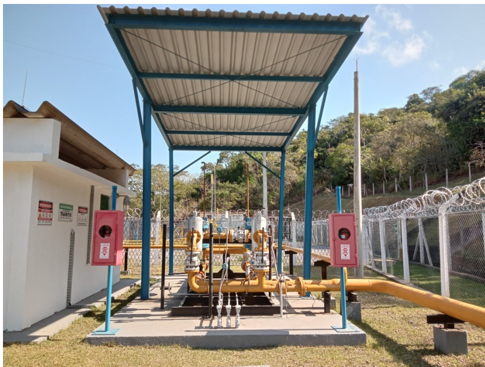
Foto 8: Estação de regulação e medição 2º corte.
