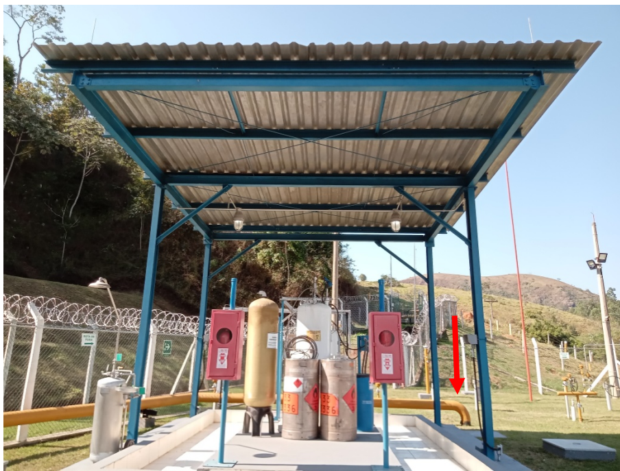
Foto 11: Estação de odorização do gás natural (linha de saída do gás odorizado).
