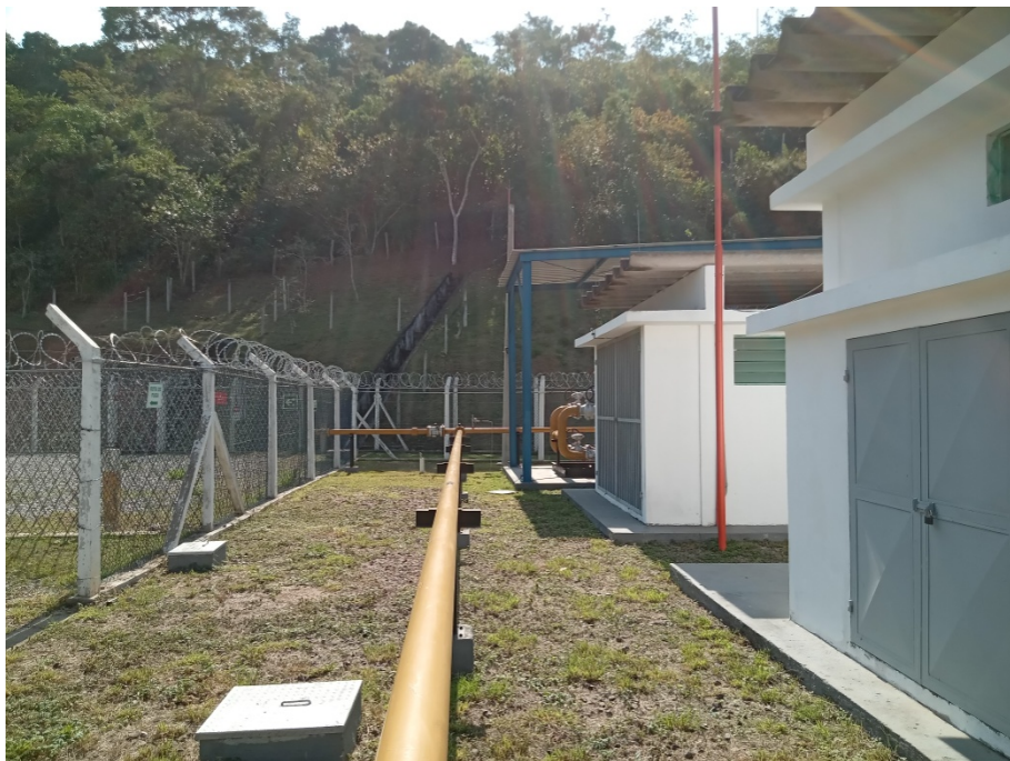
Foto 6: Tubulação de gás natural ( \varnothing 4'' ) que segue para a estação de 2º corte.
