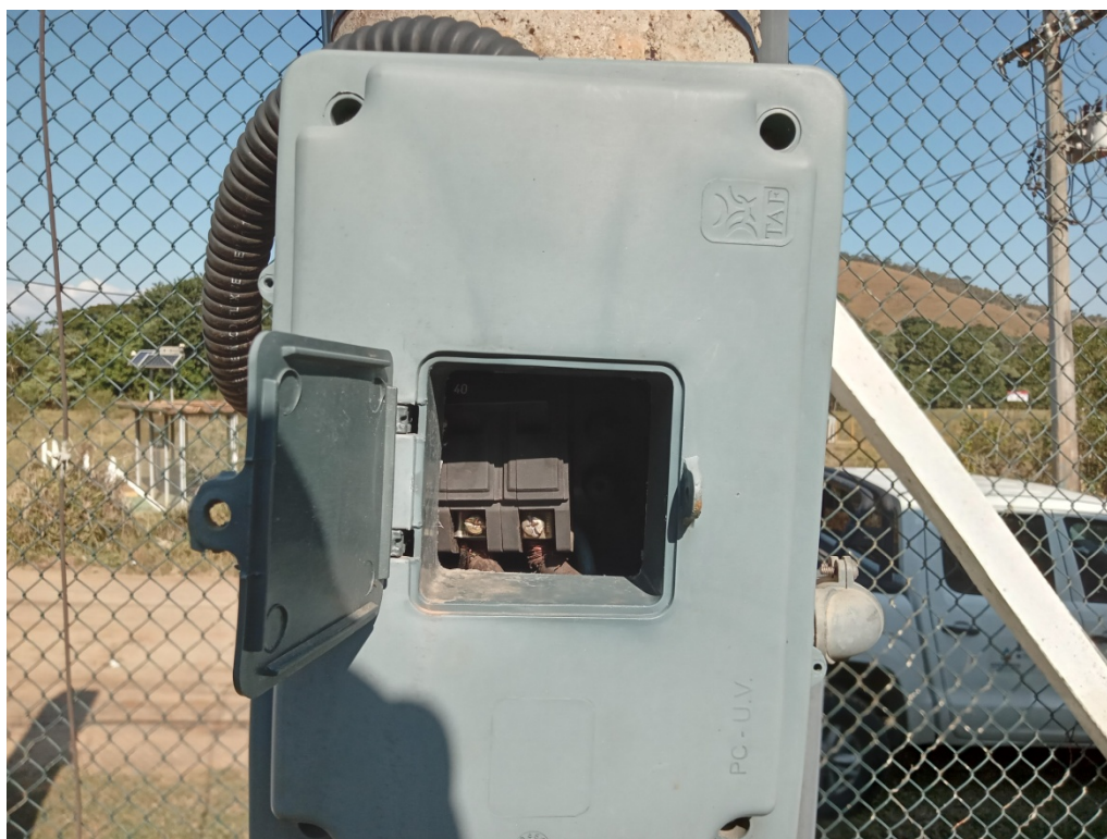
Foto 16: Disjuntor geral da estação fora das condições normais, oferecendo risco de choque.
