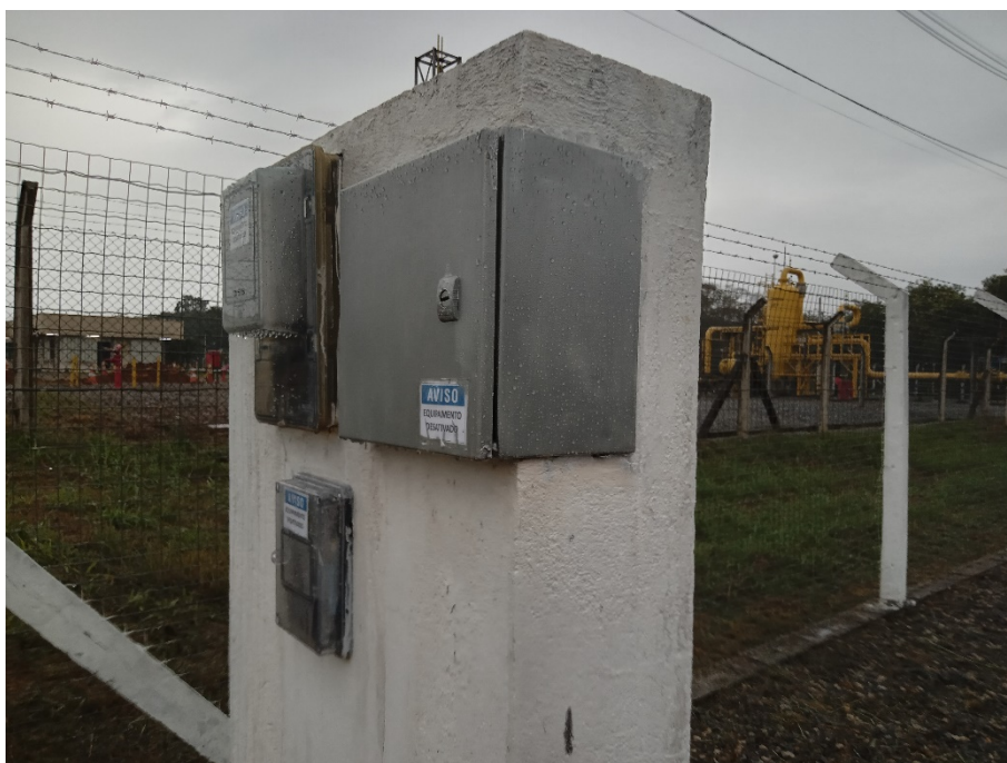
Foto 13: Padrão de entrada de energia desativado.
