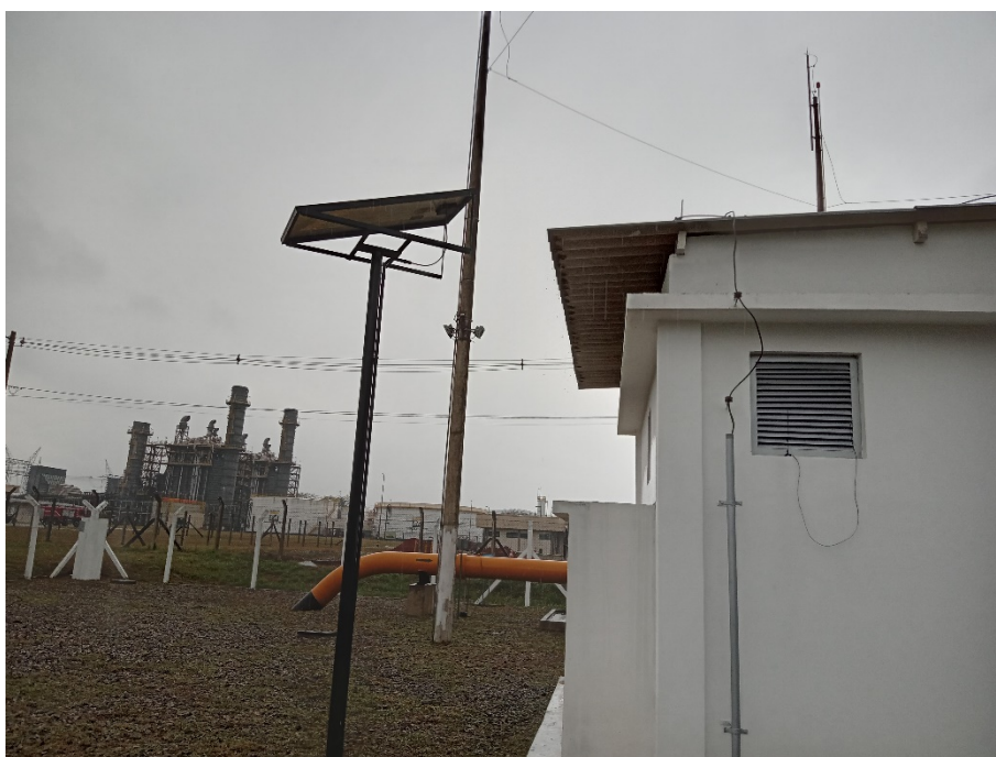
Foto 12: Paineis fotovoltaicos e sistema de proteção contra descargas atmosféricas.
