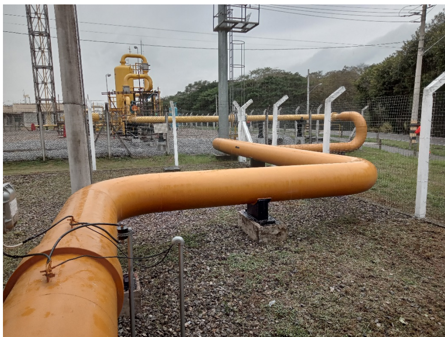
Foto 9: Linha de saída que segue para a Termelétrica Baixada Fluminense.
