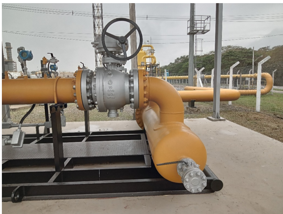
Foto 8: Válvula de acionamento manual.
