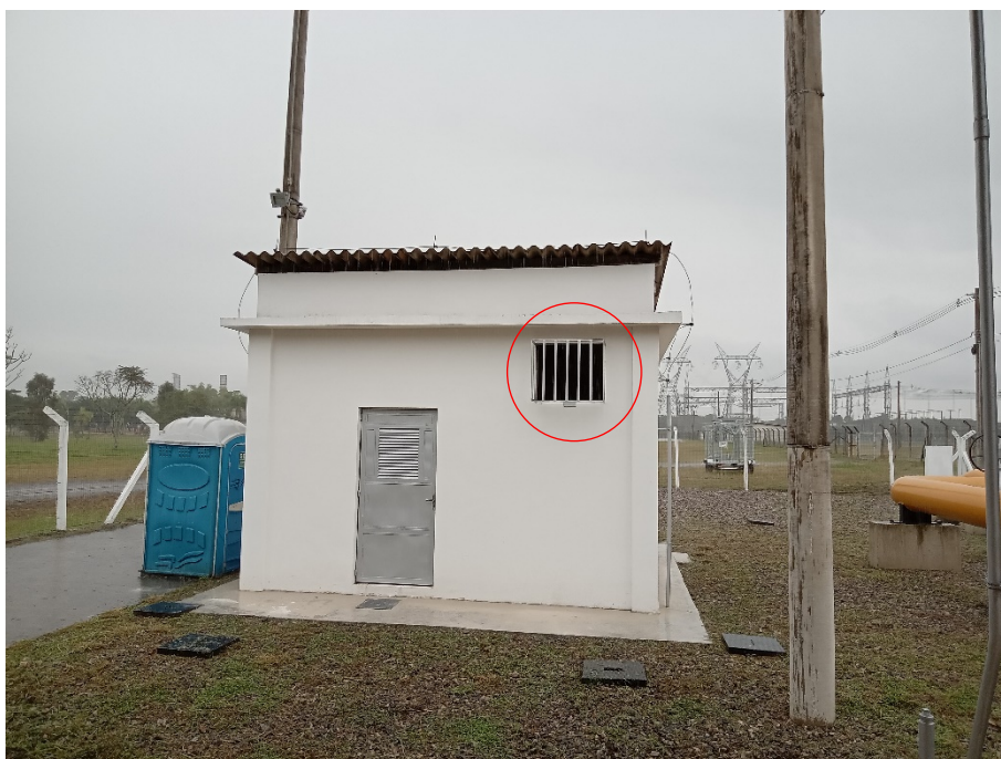
Foto 11: Sala de comando e telemetria com abertura no local destinado ao ar-condicionado.
