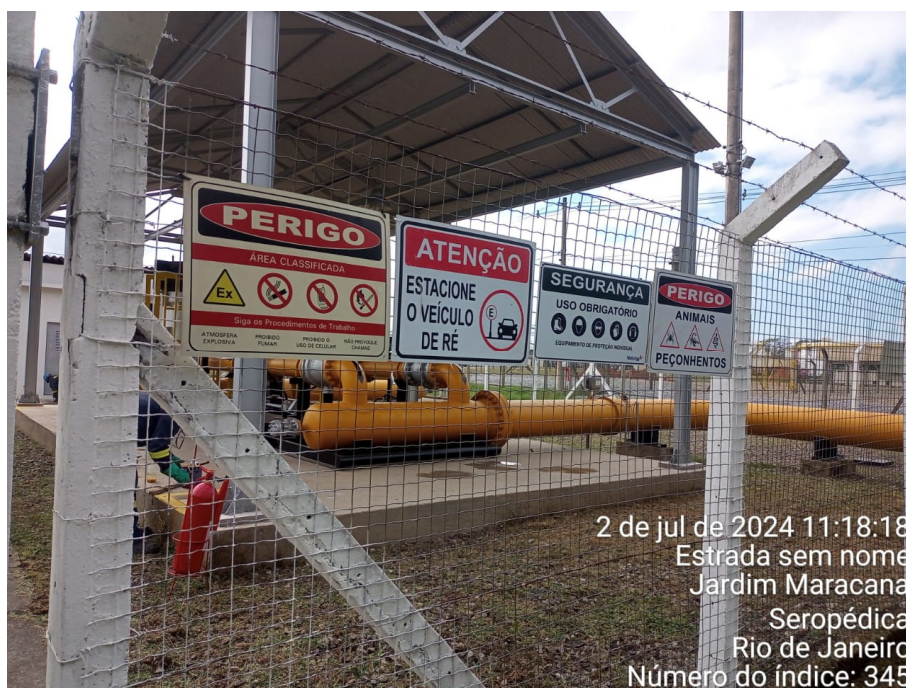
Foto 15: Adequação de placa indicativa de área classificada.
