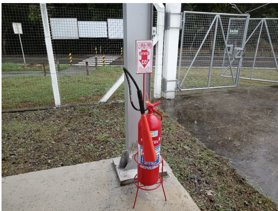
Foto 14: Extintor de incêndio sem a pintura no piso da área demarcada.
