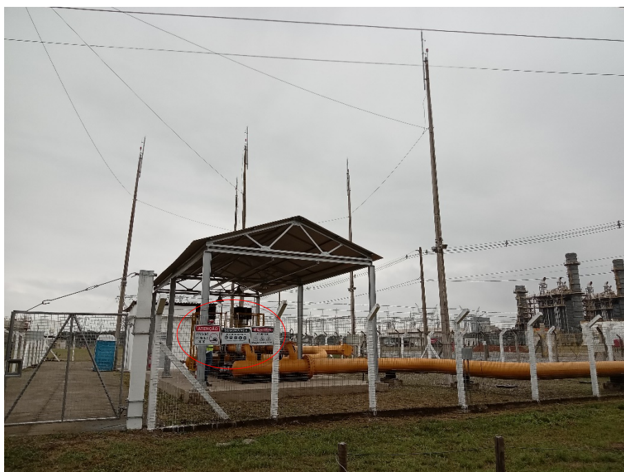
Foto 2: Vista geral da estação (ausência de placa indicativa de área classificada).
