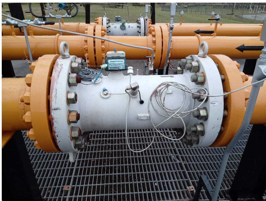
Foto 5: Medidor de vazão (Turbina).
