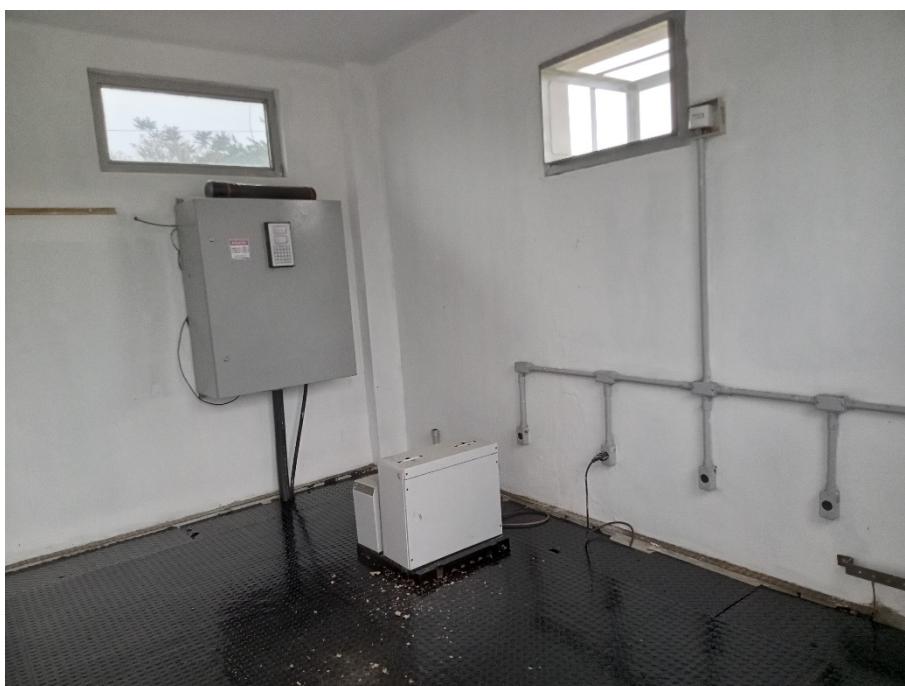
Foto 12: Painel de comando e telemetria e nobreak.
