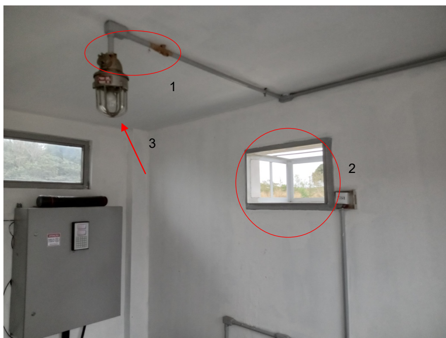
Foto 11: Presença de inseto (1), abertura (2) e iluminação inoperante (3).
