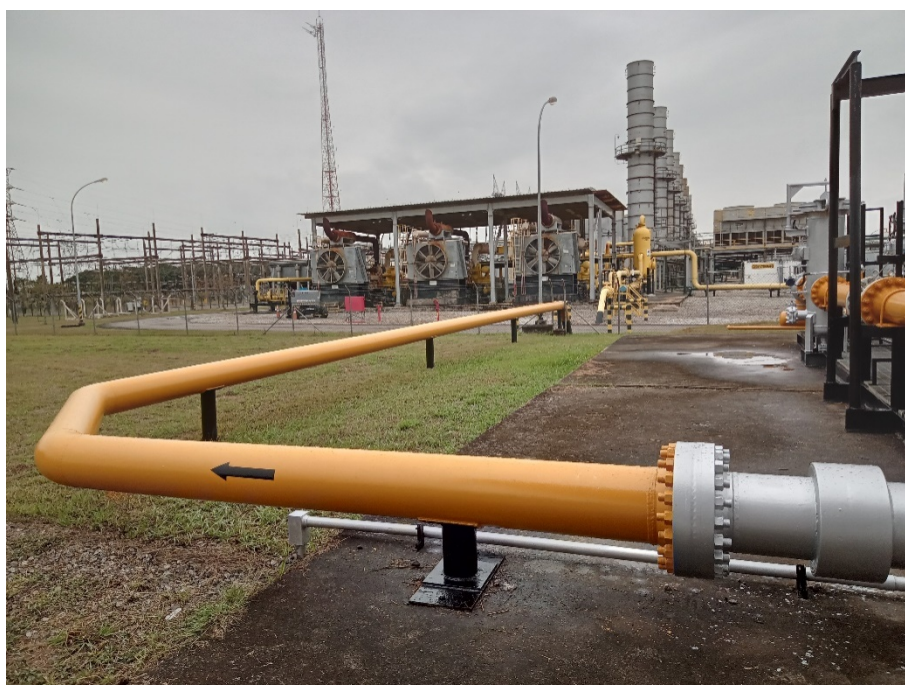
Foto 8: Linha de saída que segue para a Termelétrica.
