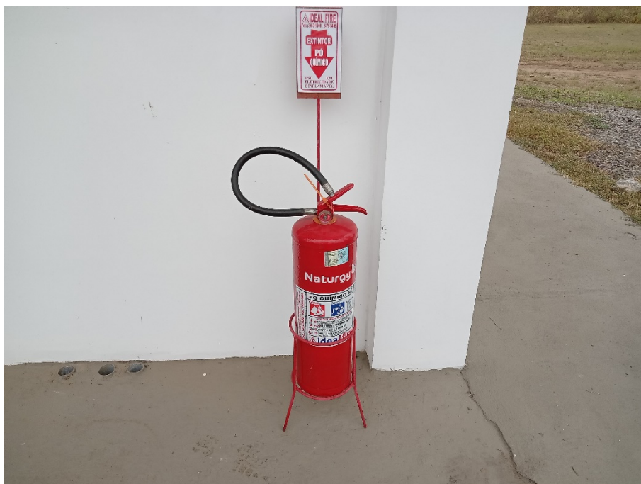
Foto 10: Extintor de incêndio sem a área demarcada no piso.
