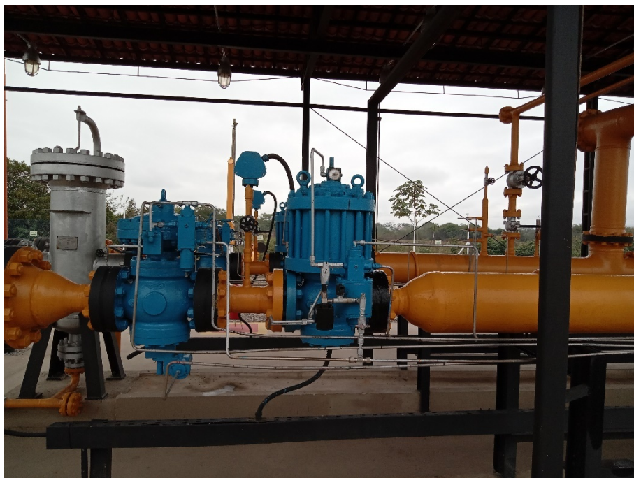
Foto 5: Reguladores de pressão.
