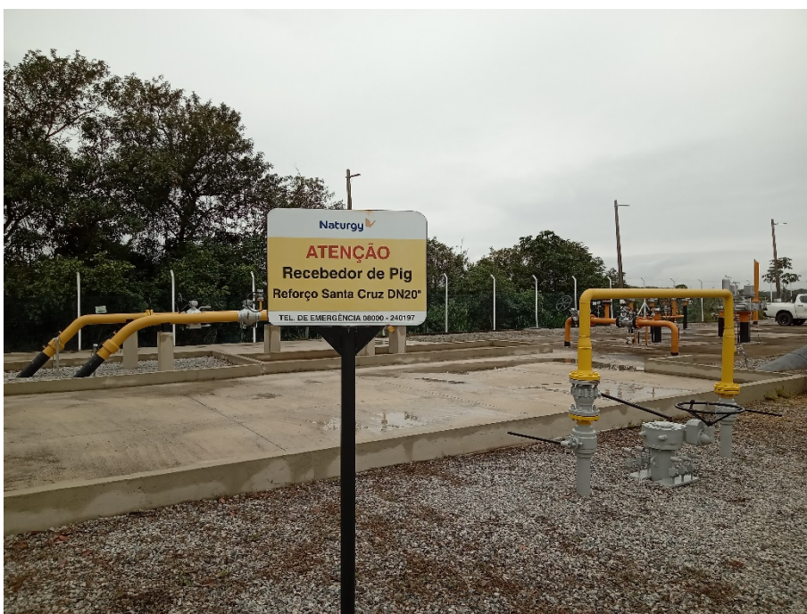
Foto 14: Sistema de manobra de válvulas.
