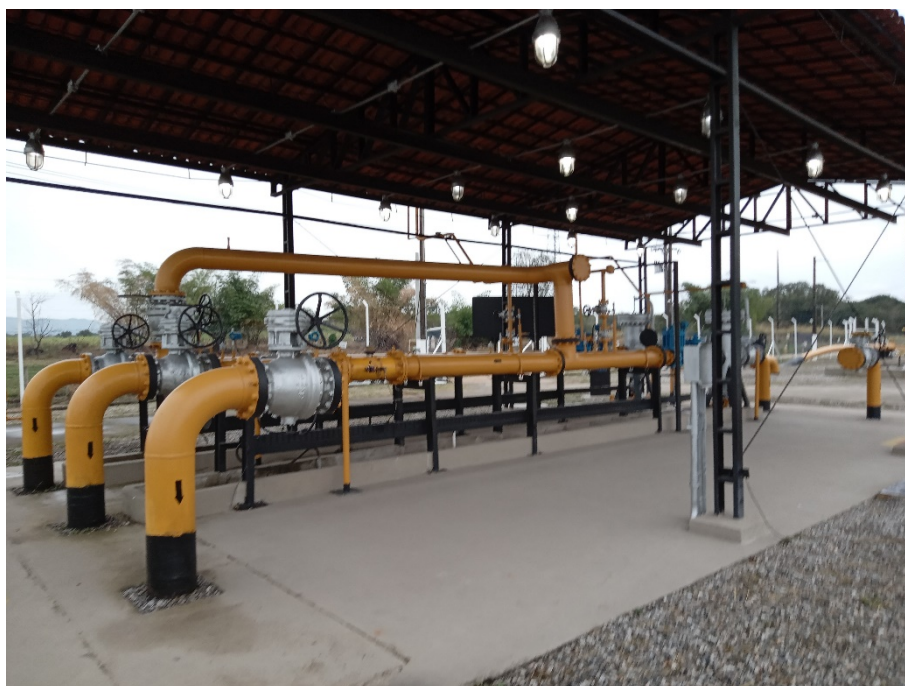
Foto 7: Linha de saída do gás.
