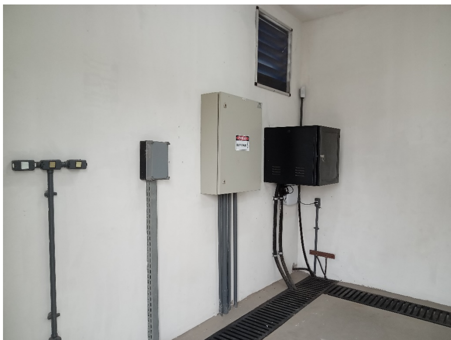
Foto 10: Sistema elétrico e sistema de monitoramento por câmera.
