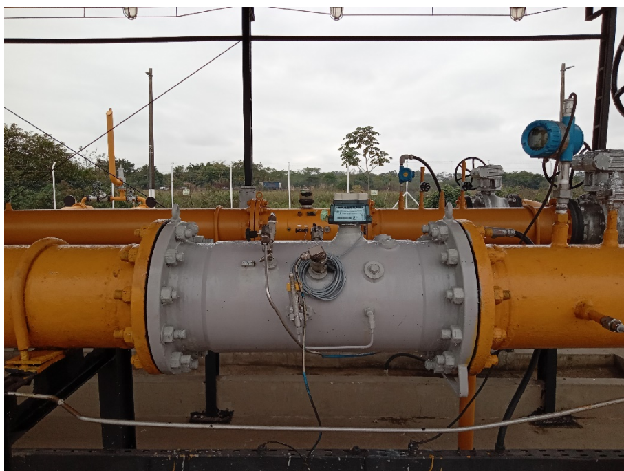
Foto 6: Medidor de vazão (Turbina).
