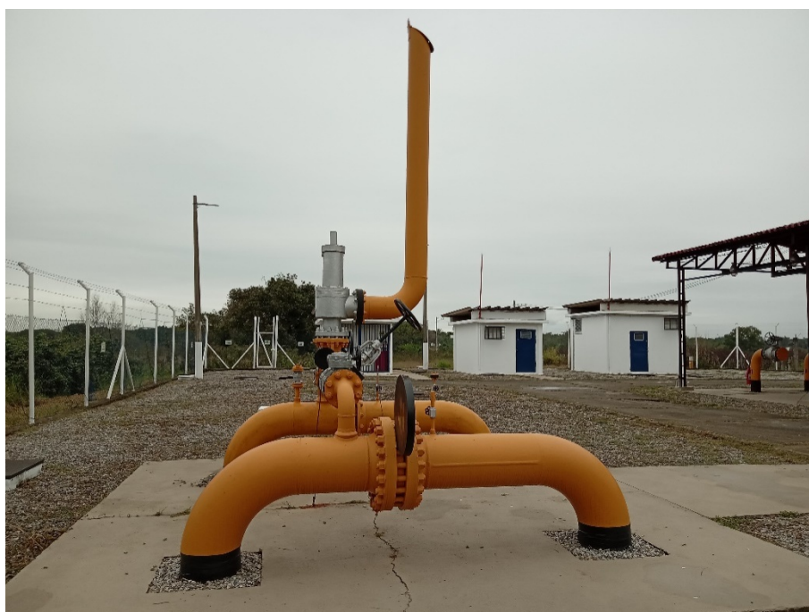
Foto 8: Tubulações de entrada e saída de gás.
