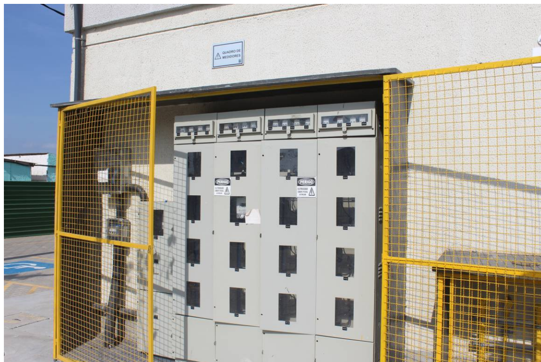
Foto 8: Quadro de medidores.
