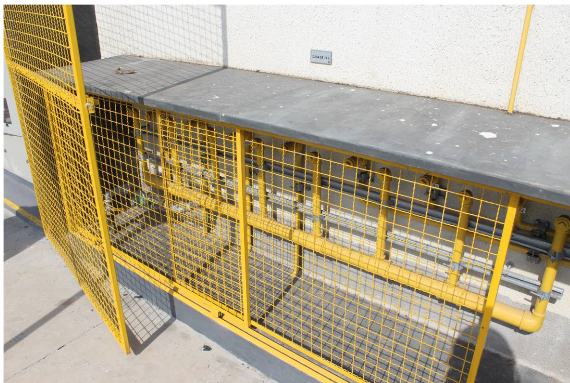
Foto 5: Abrigo dos medidores de gás e regulador de pressão.
