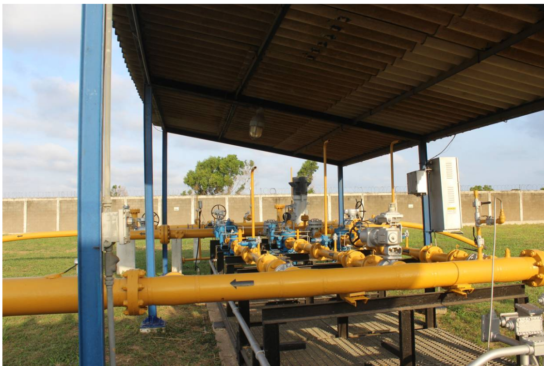
Foto 6: Estação aérea de gás.
