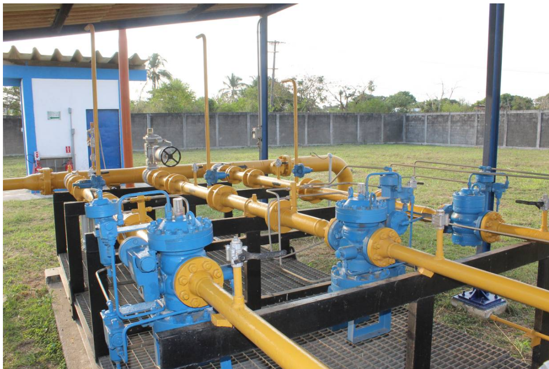
Foto 7: Os 3 reguladores de pressão da estação.
