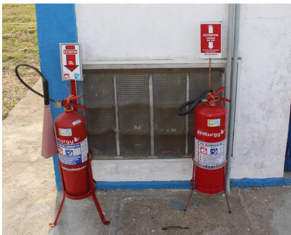
Foto 9: Extintor CO 2 e de carga de pó da estação.
