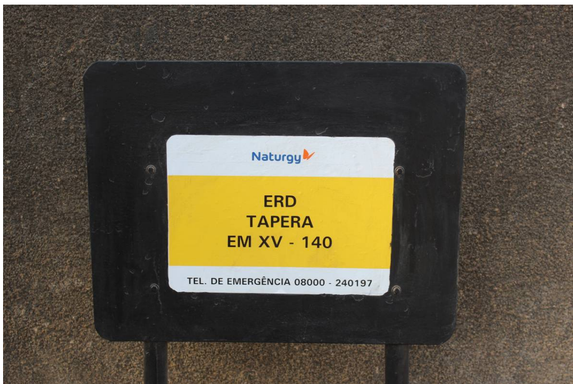
Foto 1: Placa de identificação da estação.
