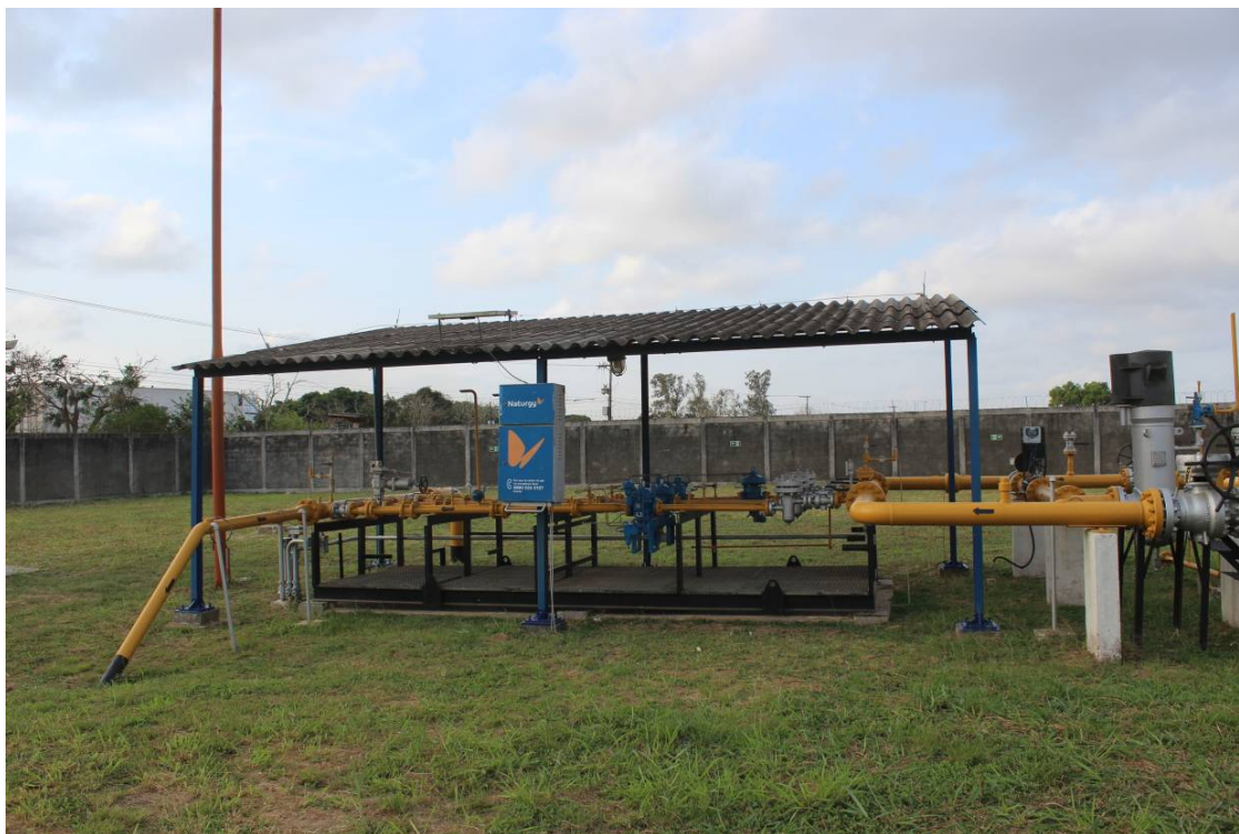
Foto 3: Estação aérea de gás.
