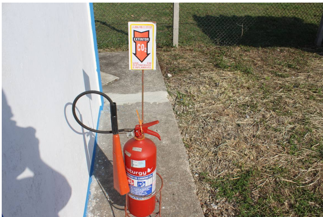
Foto 4: Extintor de CO 2 da estação.
