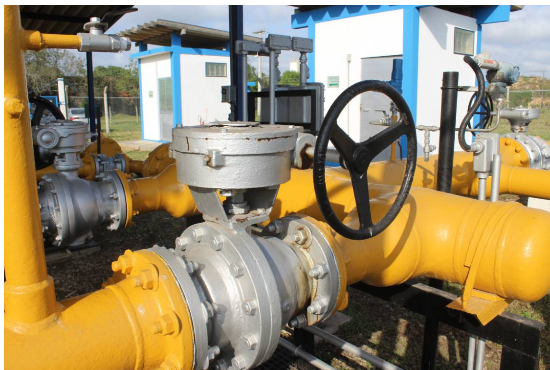
Foto 7: Sinais de ferrugem em alguns locais da estação.
