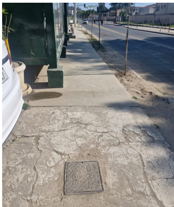
Foto 4: Rede Externa de gás que passa na calçada em frente ao condomínio.
