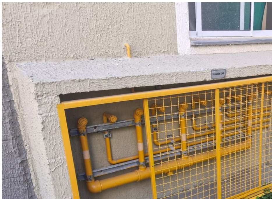
Foto 2: Cabine de Medidores de um bloco.
