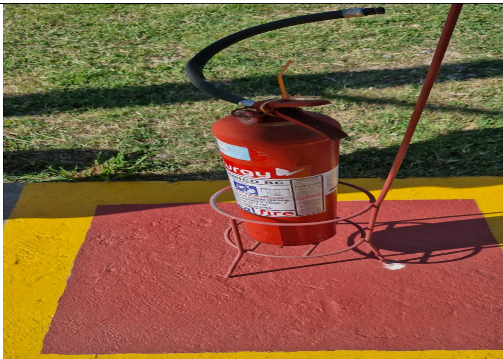
Foto 10: Extintor de incêndio e sinalização adequada no chão.
