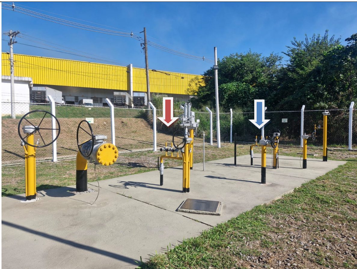
Foto 2: Linhas subterrâneas de entrada do gás e válvulas
