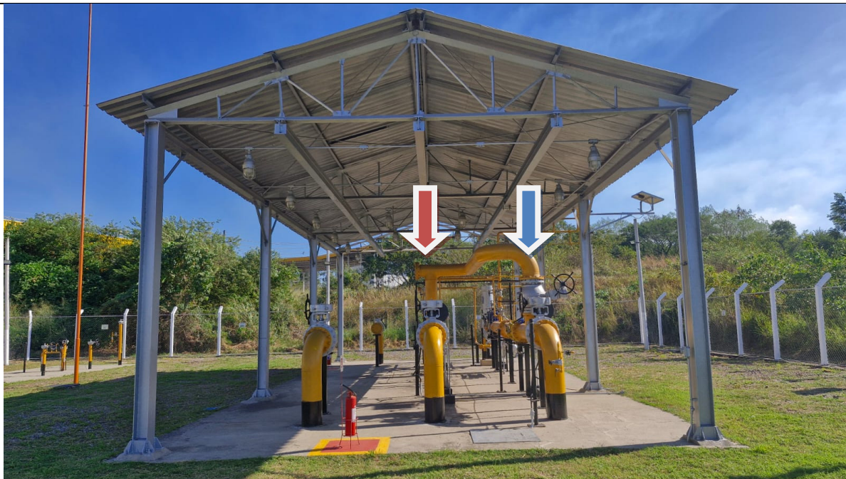
Foto 3: Linhas de regulagem. O lado esquerdo, sinalizado em vermelho, estava em stand-by, enquanto o direito, em azul, estava em operação no momento da vistoria.
