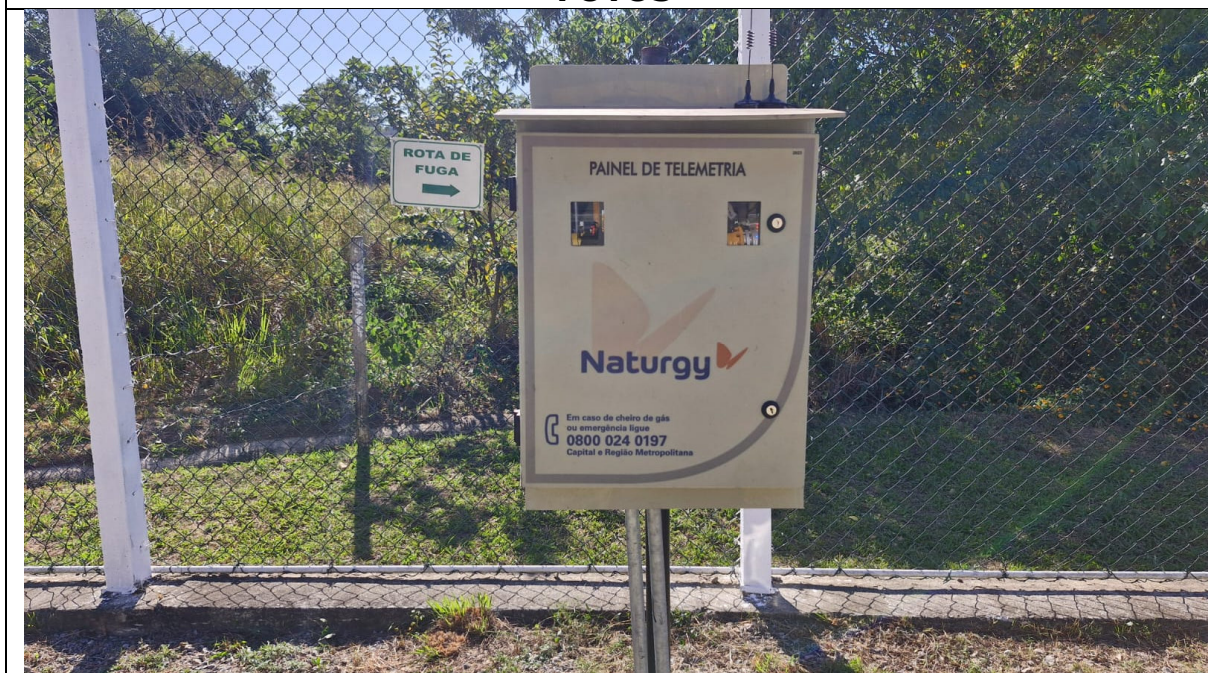
Foto 5: Painel externo de telemetria. Placa sinalizando rota de fuga ao lado.
