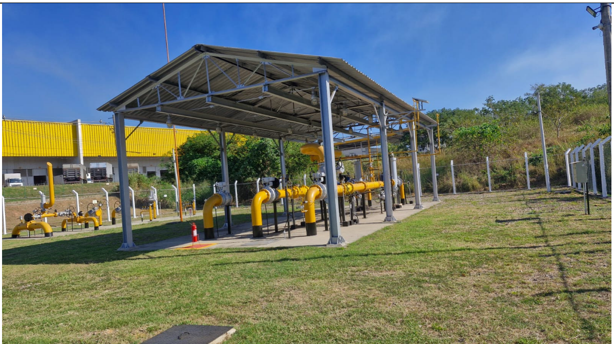
Foto 1: Visão geral da estação.
