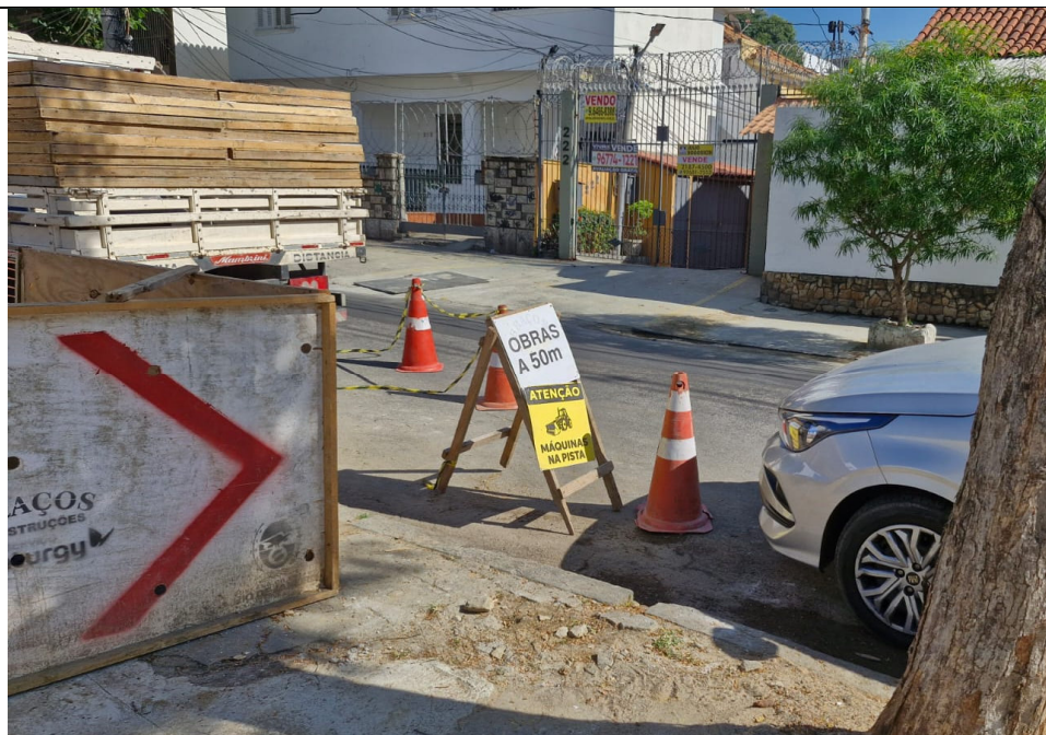
Foto 6: Sinalização, cones de isolamento, e área com descarte de material.
