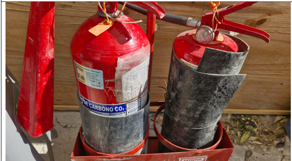
Foto 2: Extintores disponíveis e lacrados.
