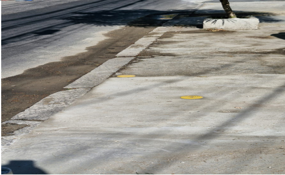
Foto 11: Vazamento acumulando pela calçada e logradouro, em frente ao nº 422.
