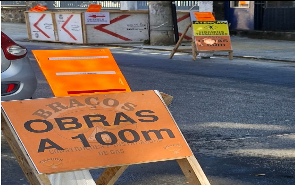
Foto 12: Sinalização noturna e para desvio de trânsito.
