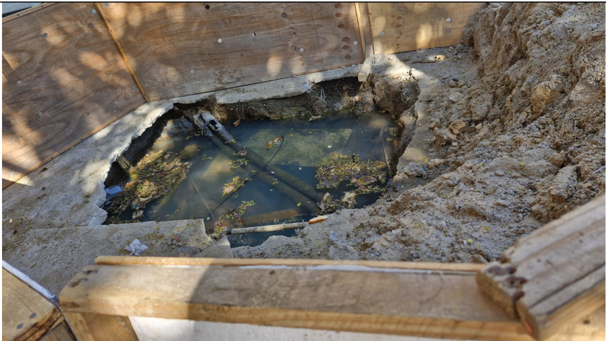
Foto 10: Vazamento na rede se acumulando na intervenção da concessionária, na esquina com a Rua Vilena Tavares.
