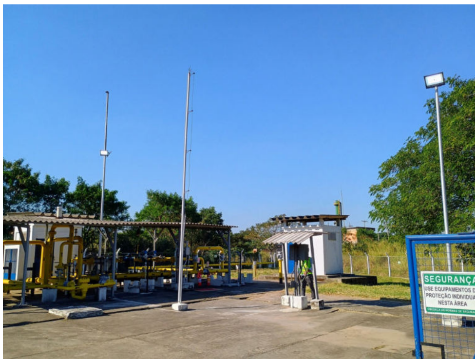
Foto 2: Estação de regulagem e medição.
