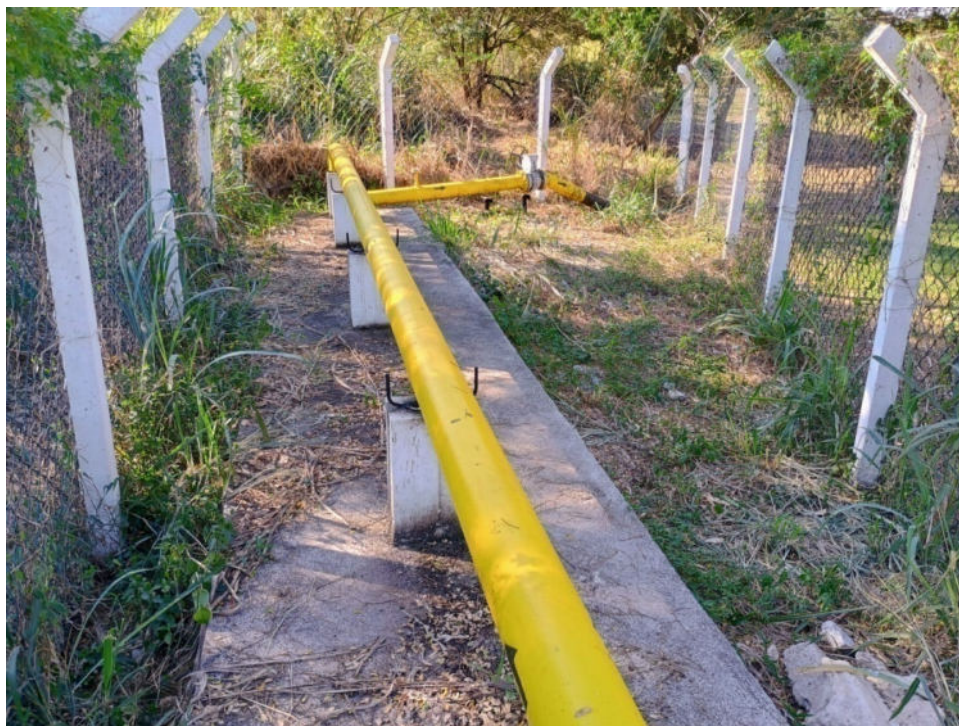
Foto 4: tubulação de saída destinada a Fábrica Carioca de Catalisadores.
