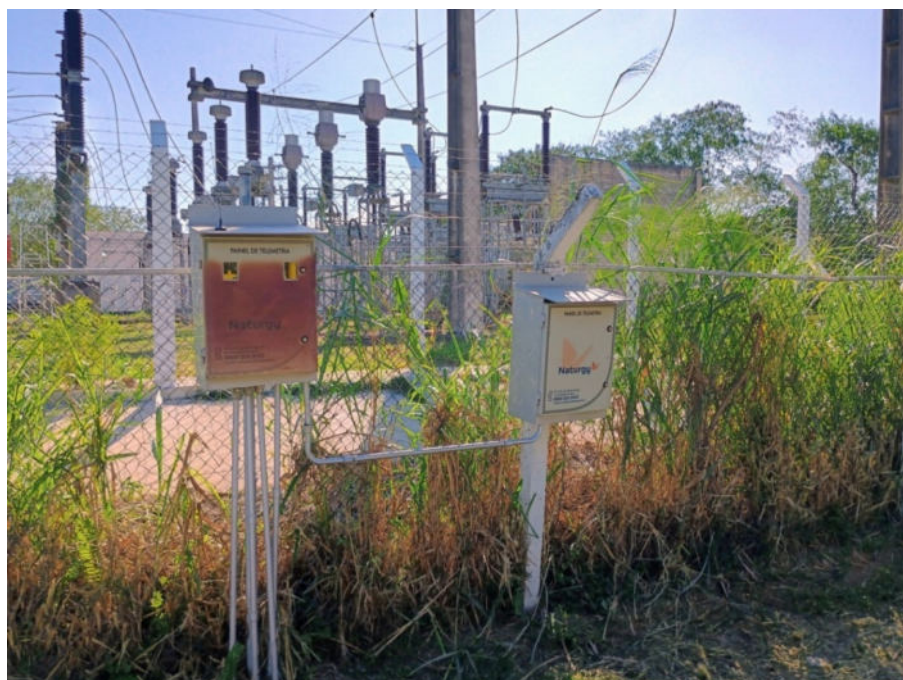
Foto 6: caixa de acondicionamento do sistema de telemetria.
