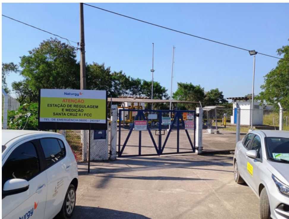
Foto 1: Estação de regulagem e medição.
